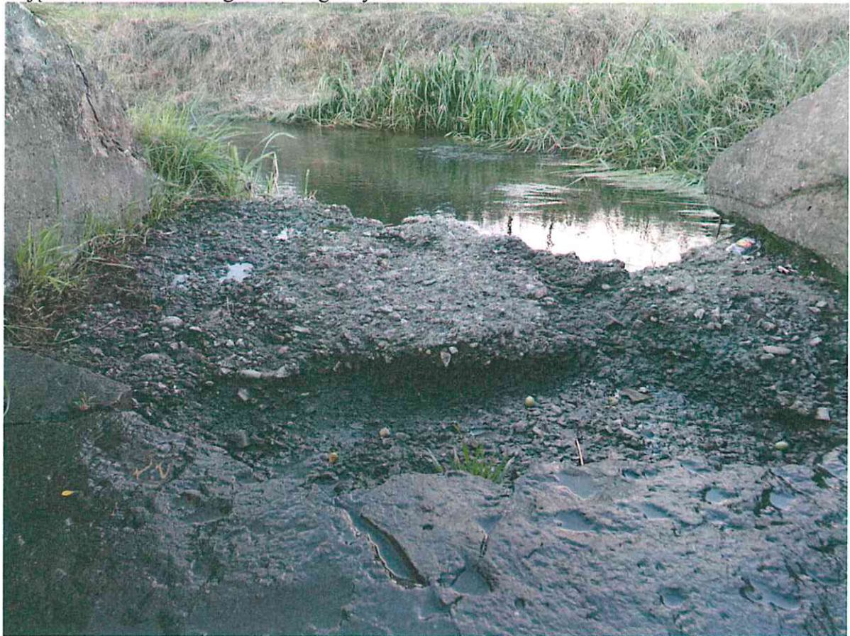
Zdjęcie nr 3 – widok zdegradowanego wylotu W23
