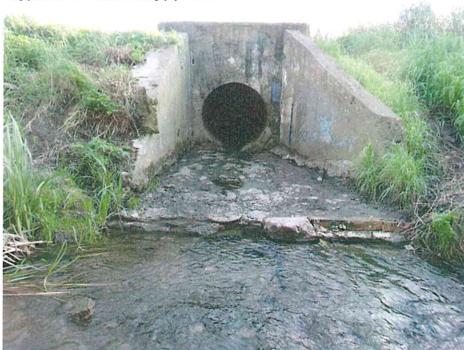
Zdjęcie nr 1 - stan istniejący W22
