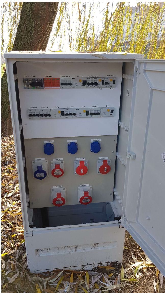
Widok złącza na boisku przy ul. Daszyńskiego
