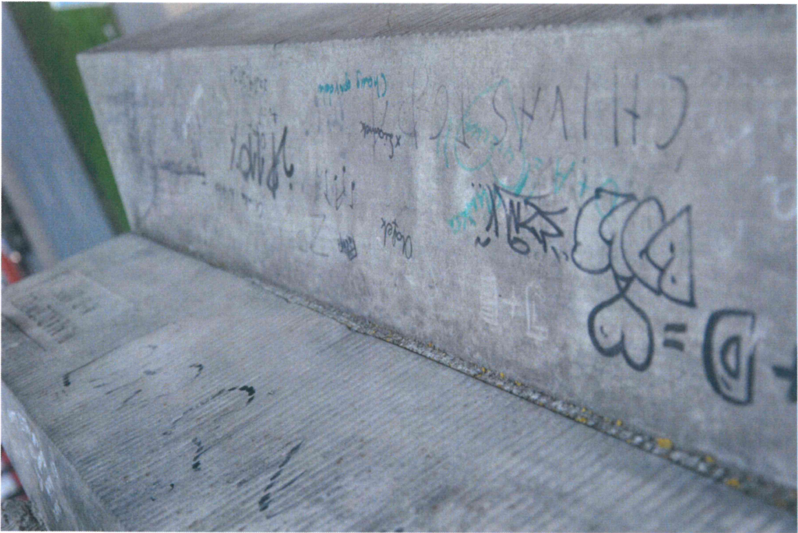
Fot. nr 15 – Lew – symbol Lwowa . Pomnik na wzgórzu zamkowym w Lublinie, ul Zamkowa 9. Fragment – zniszczenia partii cokołowej.
