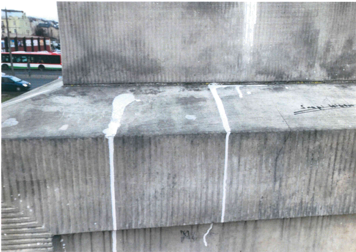
Fot. nr 13 – Lew – symbol Lwowa . Pomnik na wzgórzu zamkowym w Lublinie, ul Zamkowa 9. Fragment – zniszczenia partii cokółowej. Zacieki z farby od strony południowej.
