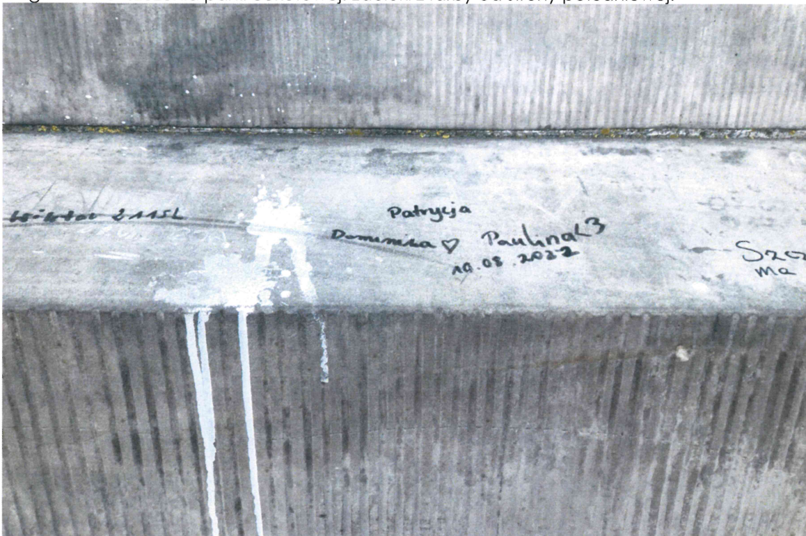
Fot. nr 14 – Lew – symbol Lwowa . Pomnik na wzgórzu zamkowym w Lublinie, ul Zamkowa 9. Fragment – zniszczenia partii cokółowej.
