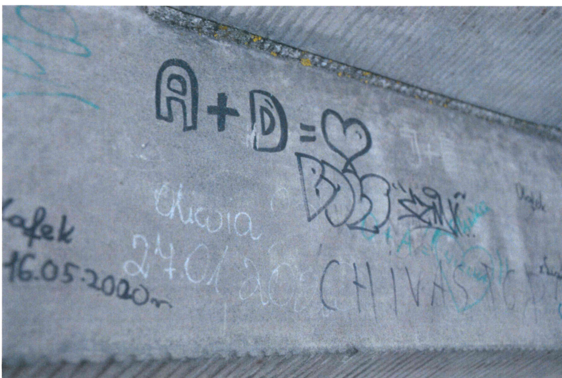
Fot. nr 8 – Lew – symbol Lwowa . Pomnik na wzgórzu zamkowym w Lublinie, ul Zamkowa 9. Fragment górnej płaszczyzny cokołu. Widoczne napisy wykonane flamastrem.
