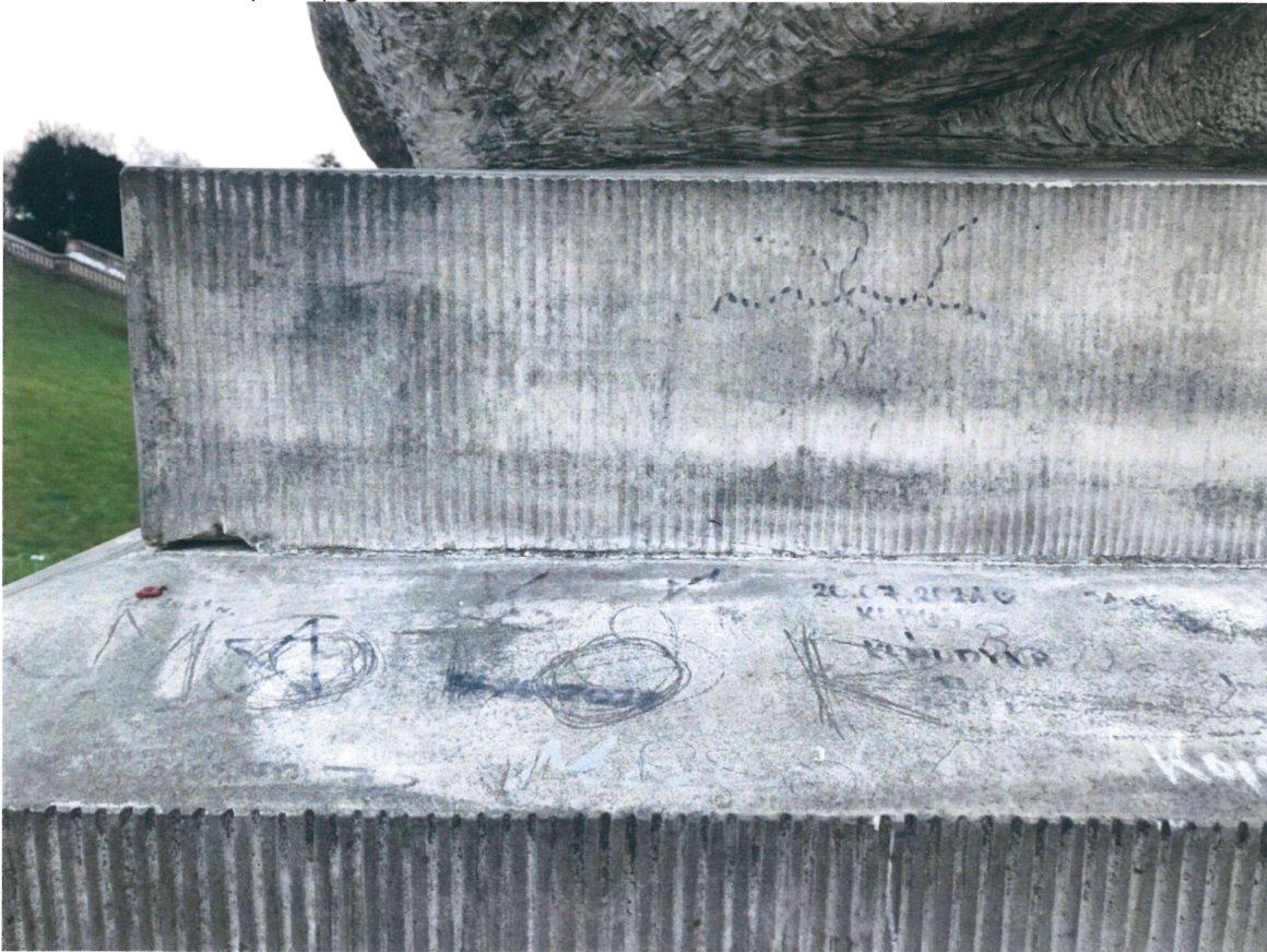
Fot. nr 12 – Lew – symbol Lwowa . Pomnik na wzgórzu zamkowym w Lublinie, ul Zamkowa 9. Fragment – zniszczenia partii cokołowej.
