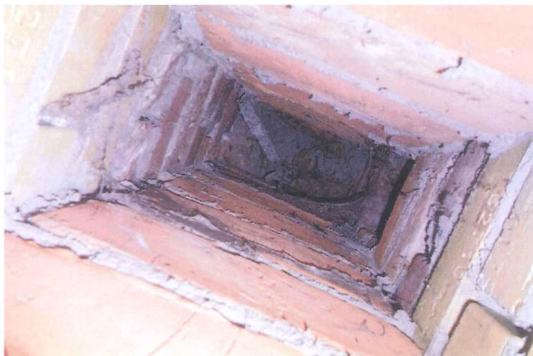
Fot. Wnętrze szymbw wentylacyjnych.
