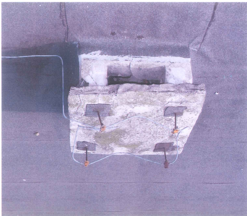
Fot. Niezabezpieczony komin wentylacyjny.
