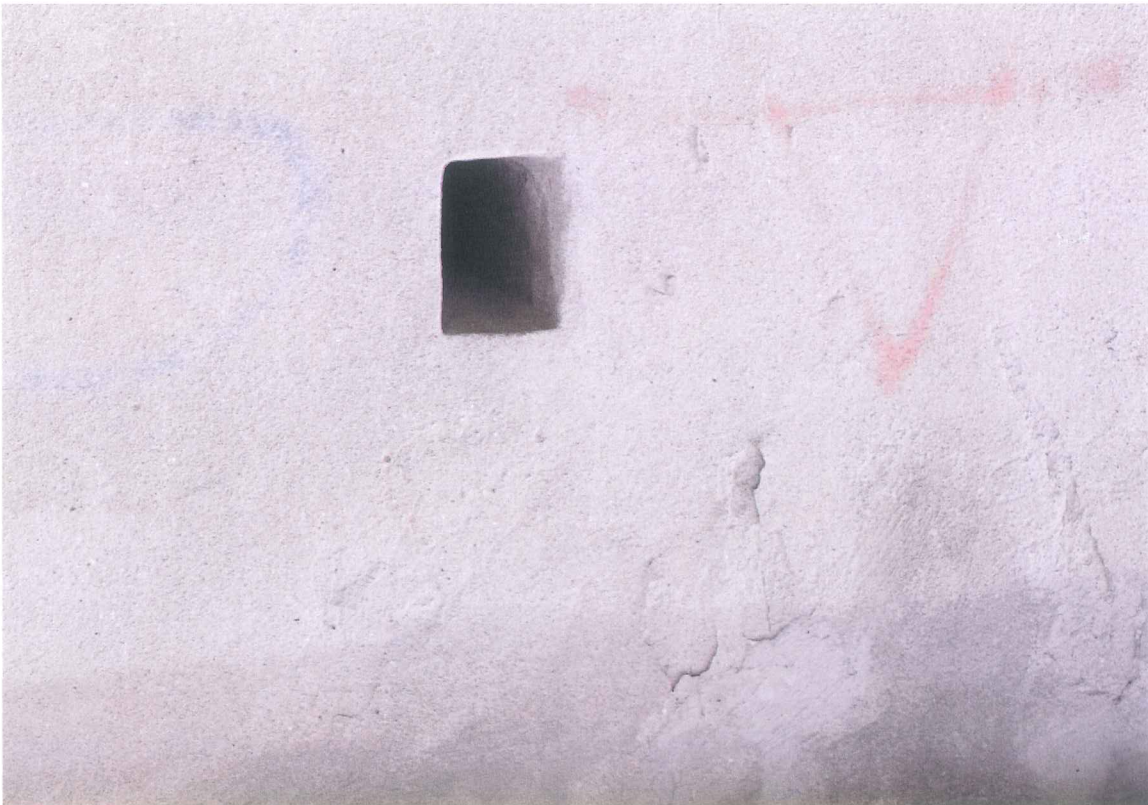
Fot. Niezabezpieczony otwór wentylacyjny prowadzący na stropodach nad salą gimnastyczną, potencjalne miejsce lęgu kawki i nietoperzy.
