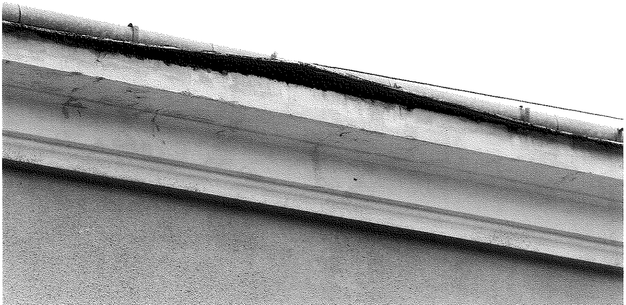
Fot. Gniazda jerzyków w szczelinach pod obróbką.
