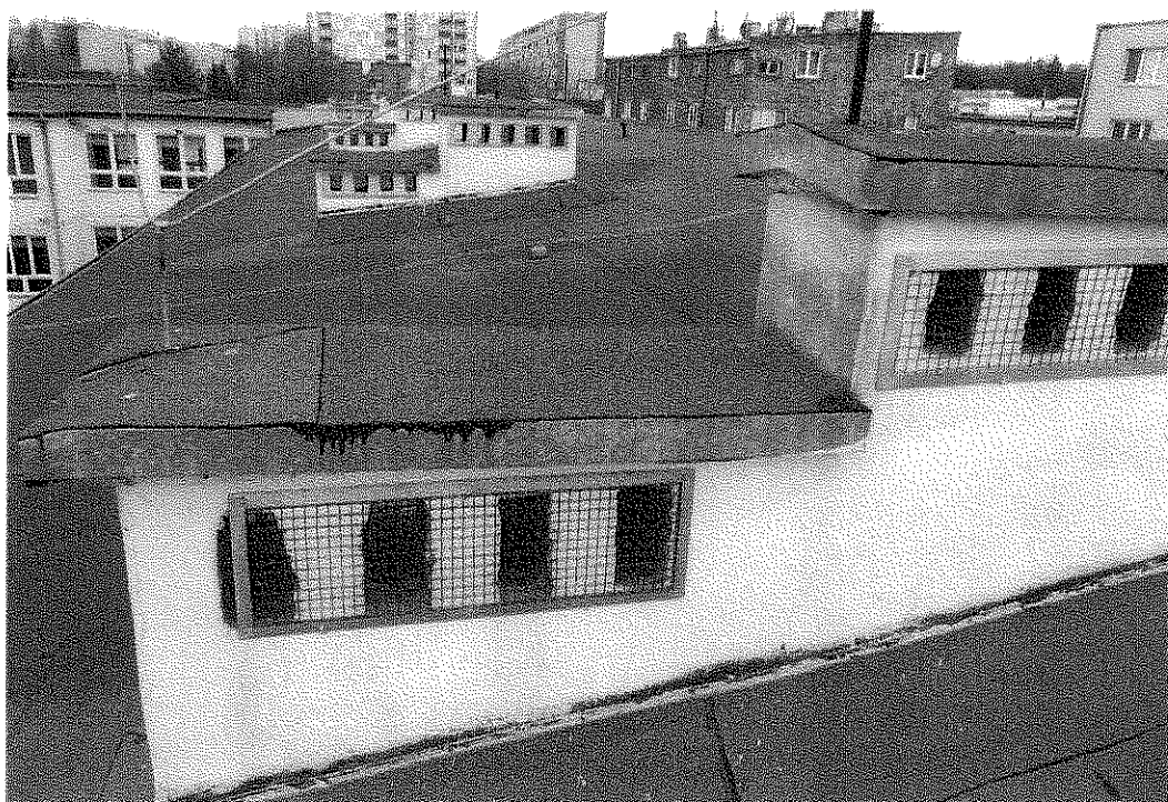
Fot. 2. Widok kominów wentylacyjnych na dachu z zabezpieczonymi otworami
