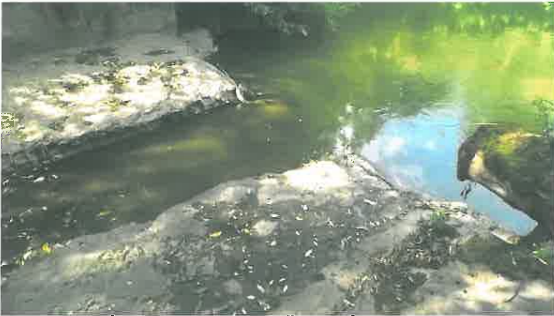
Płyta denna wylotu – obniżenie w części środkowej mocno zerodowana.
