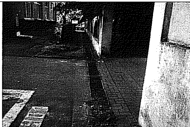
Fot. 13. Zamulony ściek na końcu odcinka A-B, przykryty szczelinowym rusztem żeliwnym
