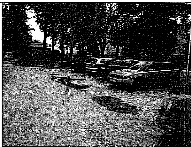
Fot. 18. Deformacje i nierówności nawierzchni zatoki parkingowej, zlokalizowanej na odcinku C-D
