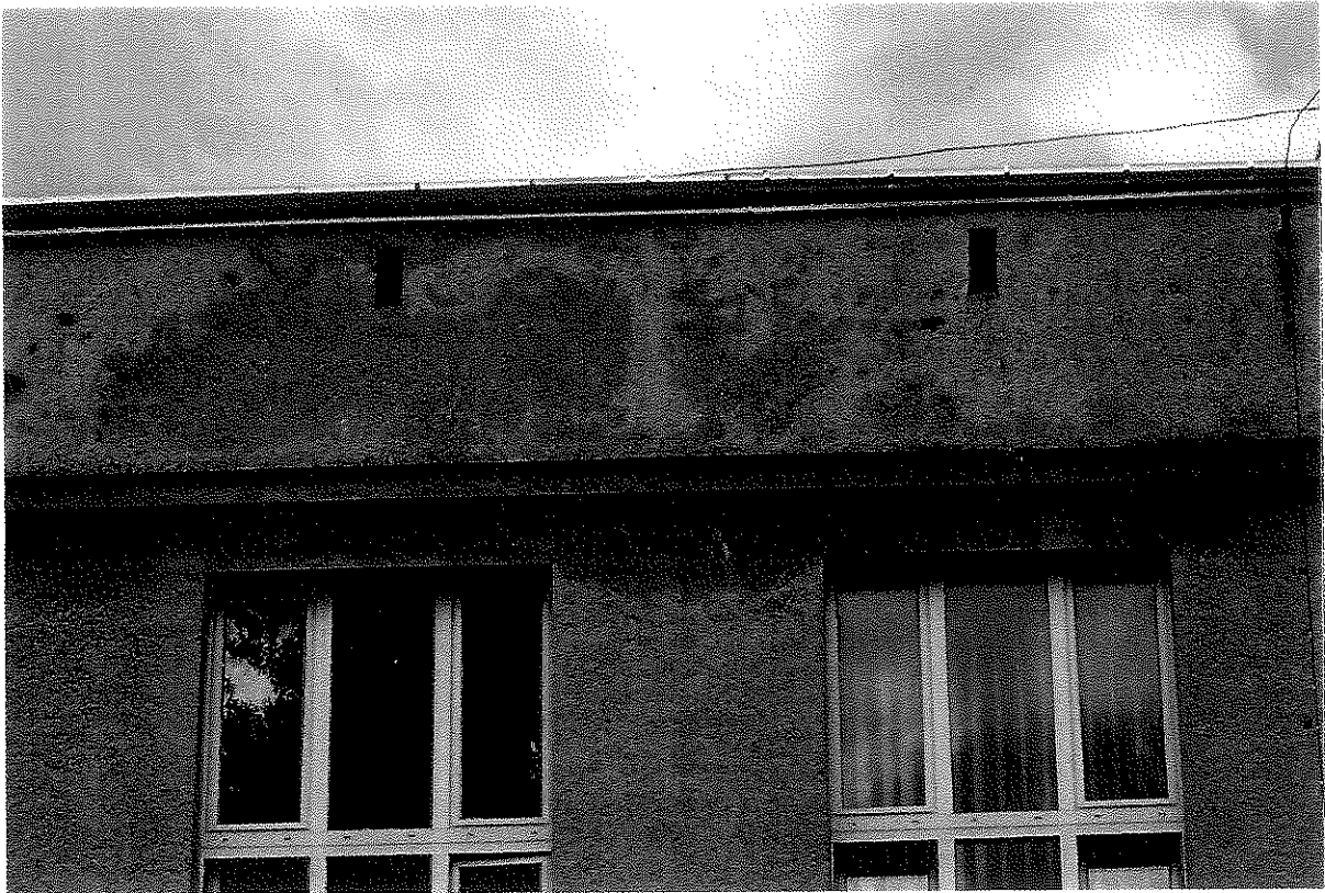
Fot. 4. Niezabezpieczony otwór na strychu możliwy do zasiedlenia przez nietoperze, jerzyki, kwaki
