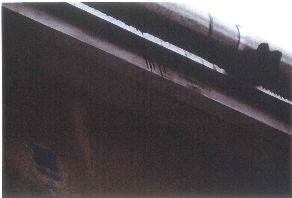
Fot. 3. Niezabezpieczony otwór na stropodach z wylatującą kawką
