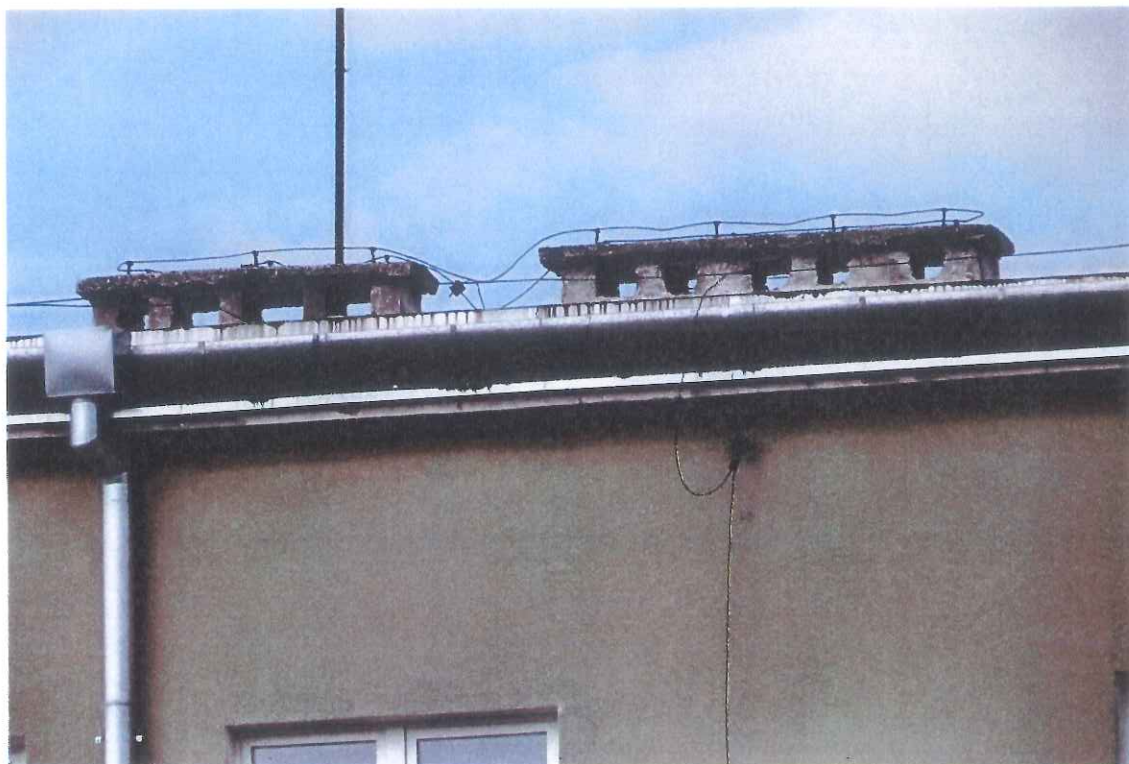
Fot. 2. Widok kominów wentylacyjnych na dachu szkoły
