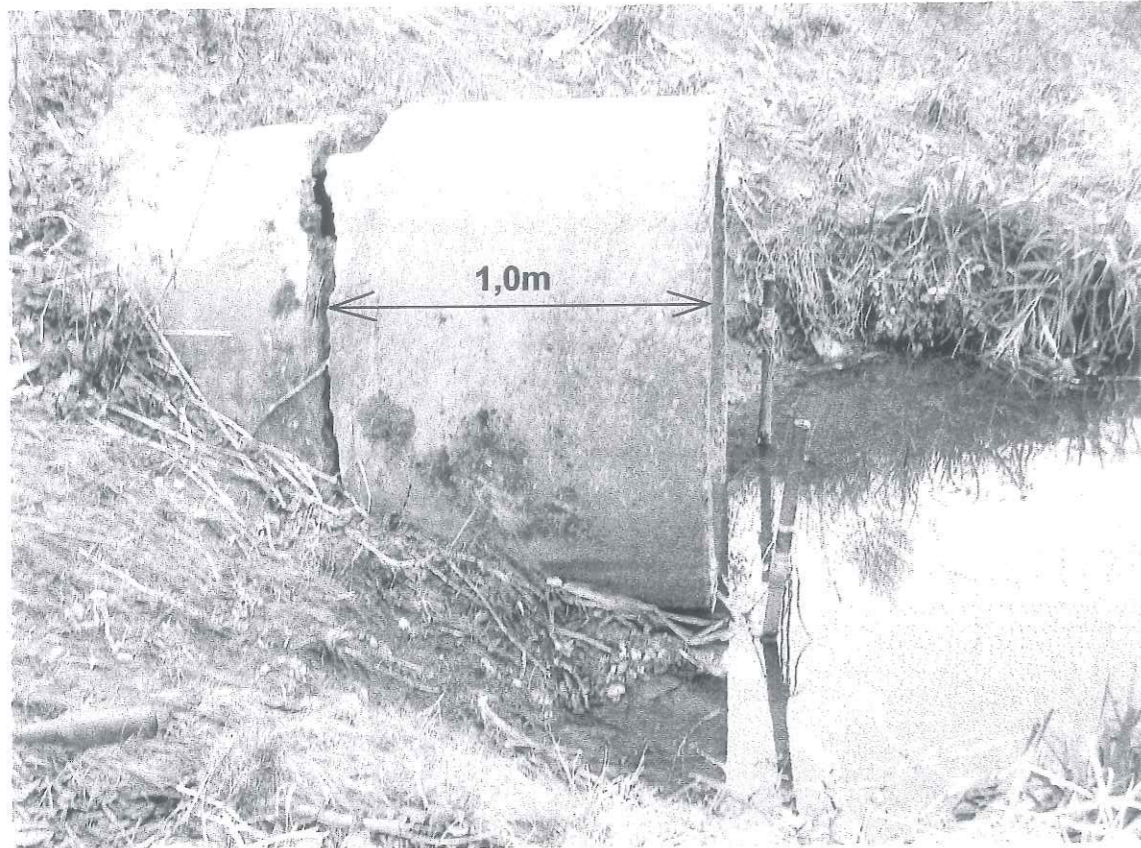
Widoczna szczelina pomiędzy rurami.
