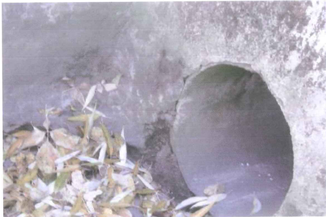
Połączenie rury DN 400 ze ścianką wylotu.
