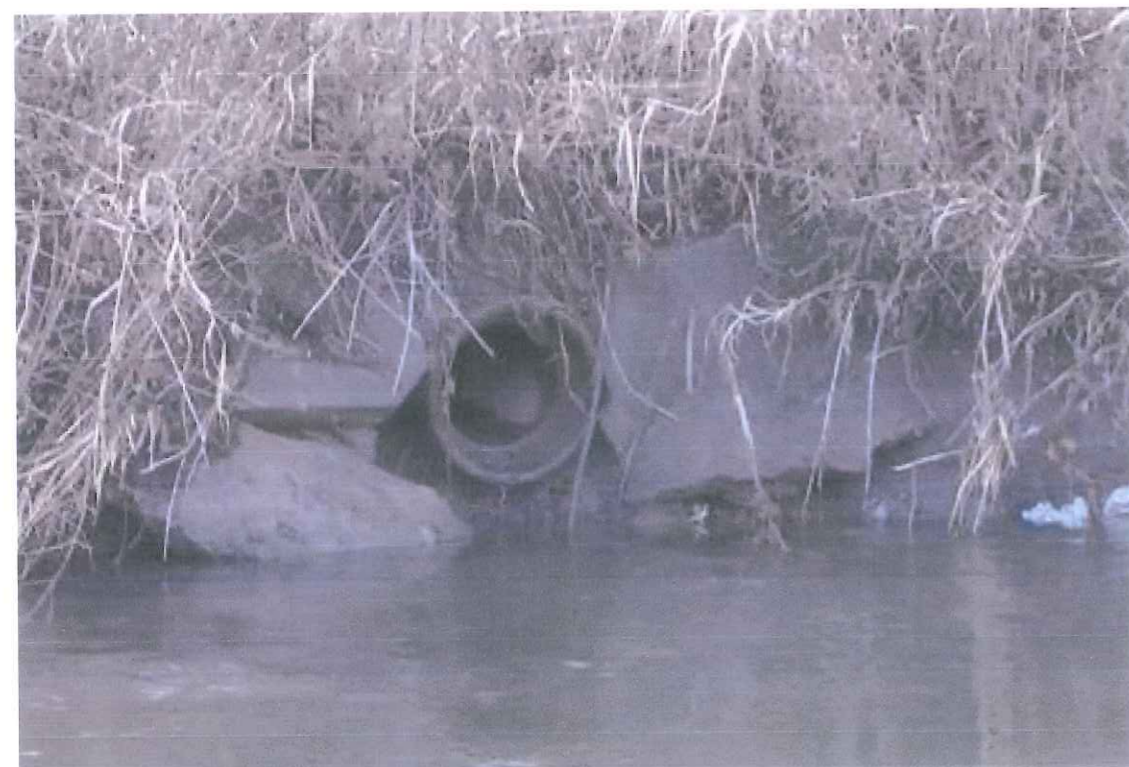
Stan techniczny i kielich rury kamionkowej.
