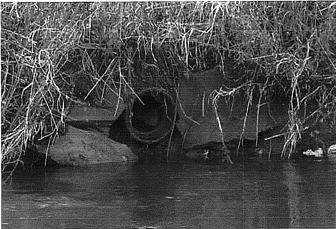
Stan techniczny i kielich rury kamionkowej.
