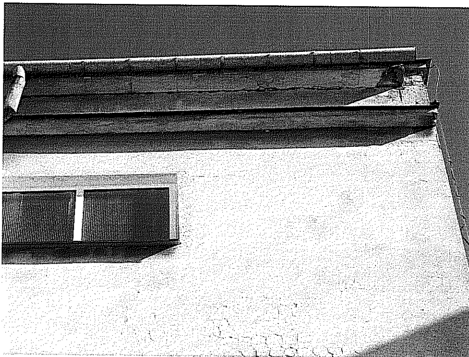
Fot. 2. Pęknięcia i szczeliny w zachodniej części szkoły
