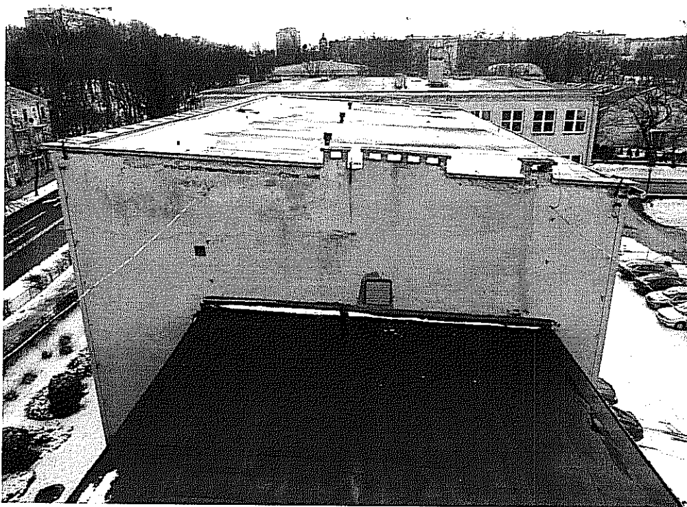
Fot. 1. Widok dachu i kominów z otwartymi wentylacyjnych na Zespole Szkół Samochodowych
