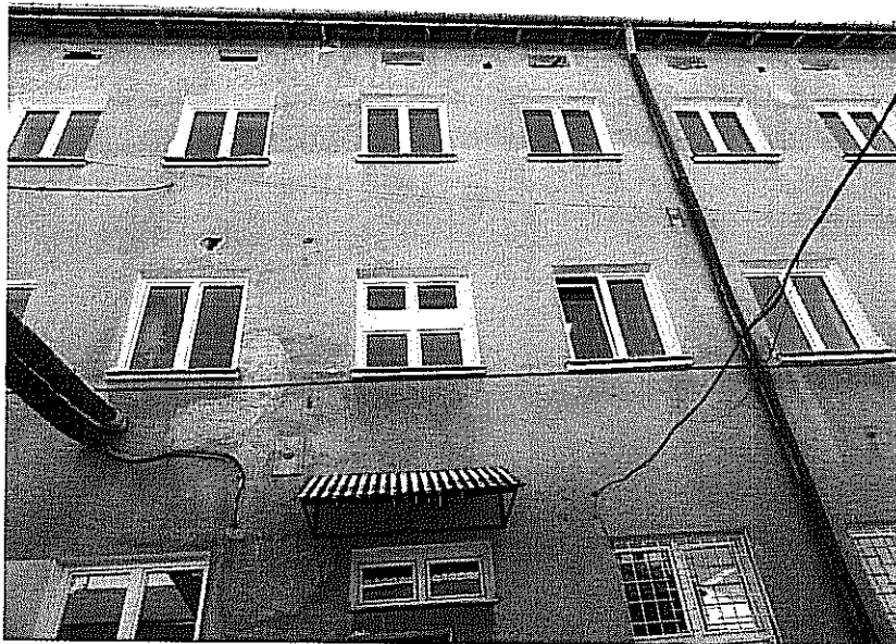
Fot. 4. Widok północnej części budynku warsztatów – w górnej części niezabezpieczone okna i otwory wentylacyjne
