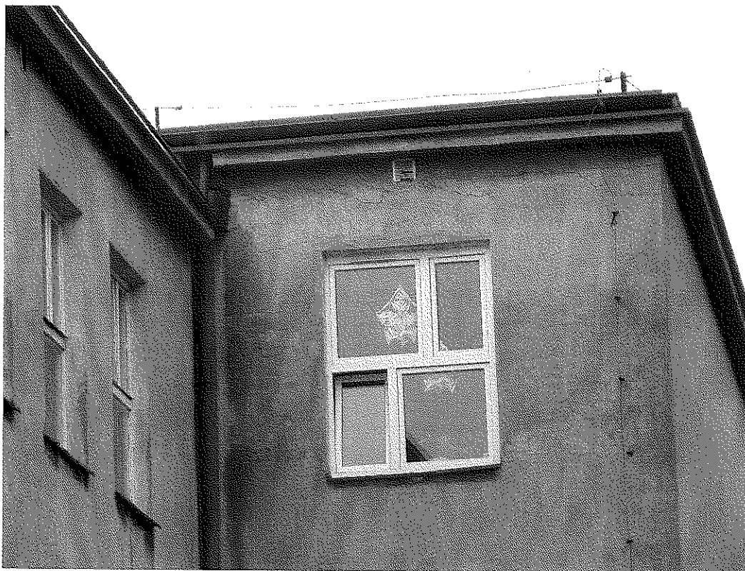
Fot. 7. Pęknięcia o szczeliny przy rynnach
