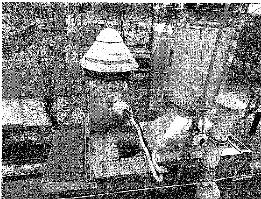
Fot. 6. Niezabezpieczony murowany komin – potencjalne miejsce lęgowe
