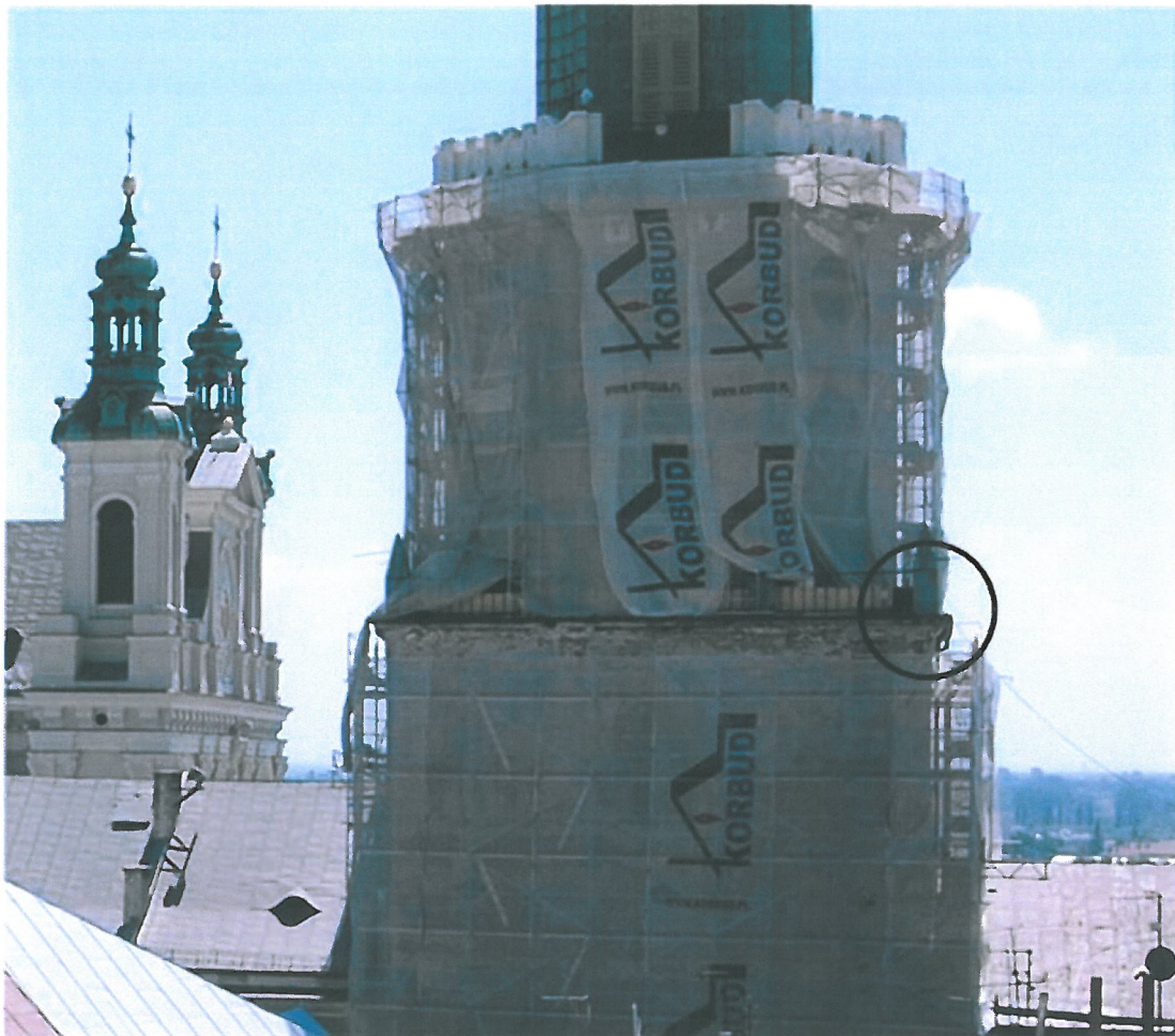
Miejsce instalacji urządzenia na Wieży Trynitarской zaznaczono czarnym okręgiem.
