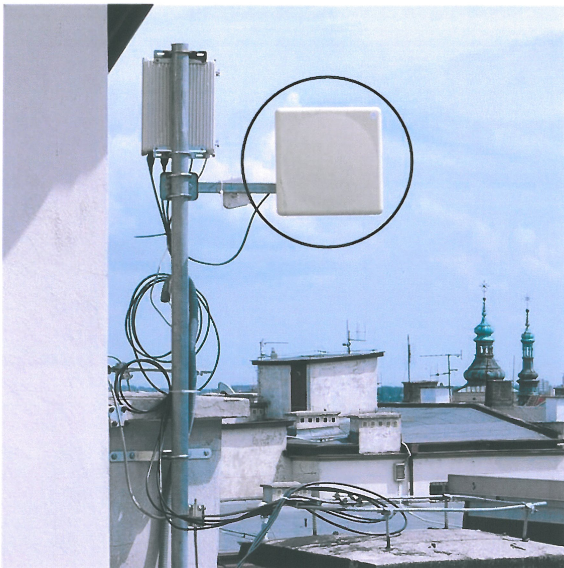
Miejsce instalacji urządzenia na dachu Poczty Głównej przy Krakowskim Przedmieściu 50 zaznaczono czarnym okręgiem.
