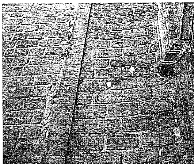
Fot. 2.3. Zniżenie nawierzchni opaski względem krawężnika na długości 4,0 m
