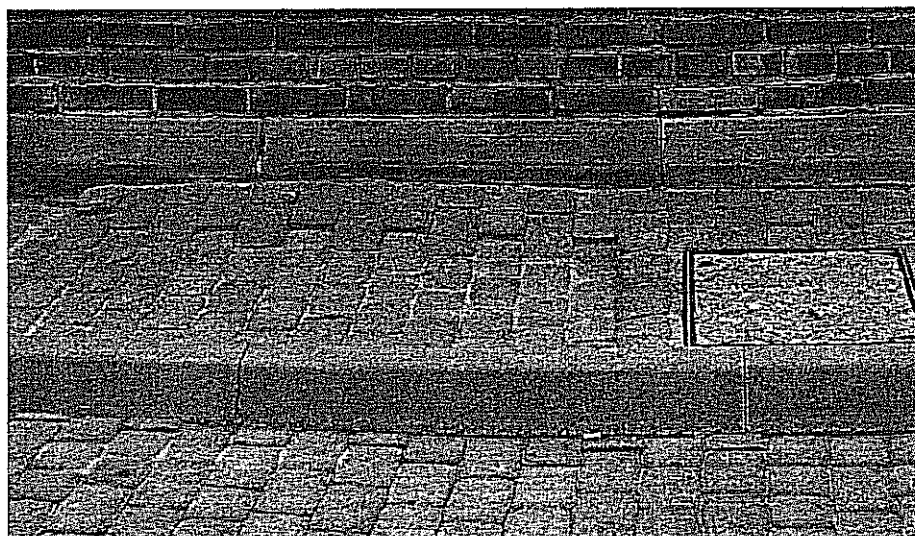
Fot. 2.5. Zapadanie się i wypiętrzanie elementów nawierzchni w pobliżu studzienek telekomunikacyjnych
