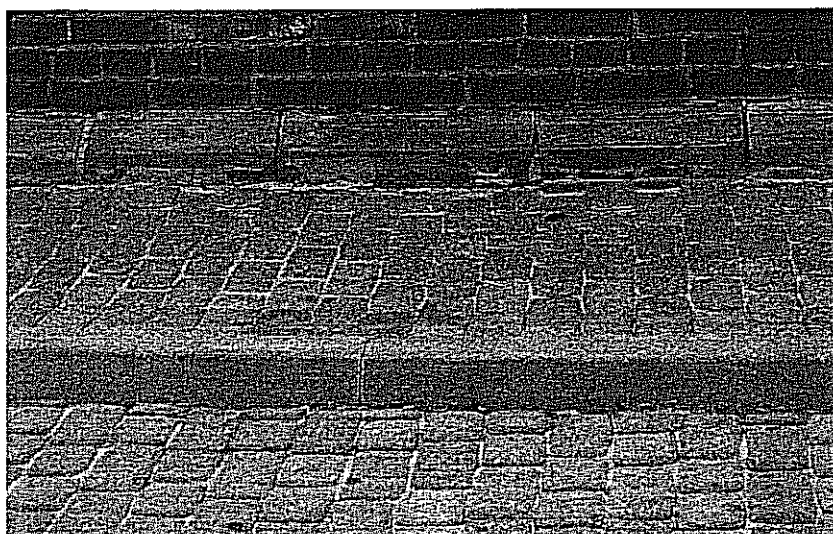
Fot. 2.6. Zaniżenie nawierzchni opaski względem krawężnika oraz deformacje podłużne i poprzeczne
