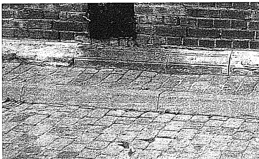
Fot. 2.2. Deformacja podłużna i poprzeczna nawierzchni opaski
