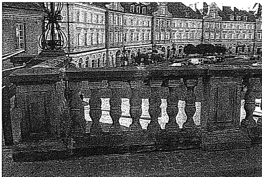
Fot. 2.18. Wychylenie słupków o 1,7/67 cm (lewy, do wewnątrz), 2,5/67 cm (prawy, na zewnątrz), pęknięcie poręczy, korozja biologiczna spoczników i ich odszczerbianie przy powierzchni opaski.
