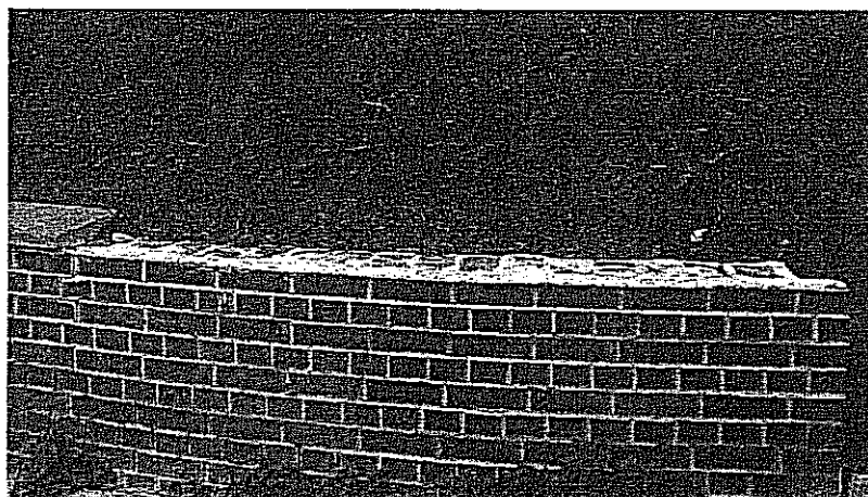
Fot. 2.41. Brak pokrycia muru oporowego nasypu
