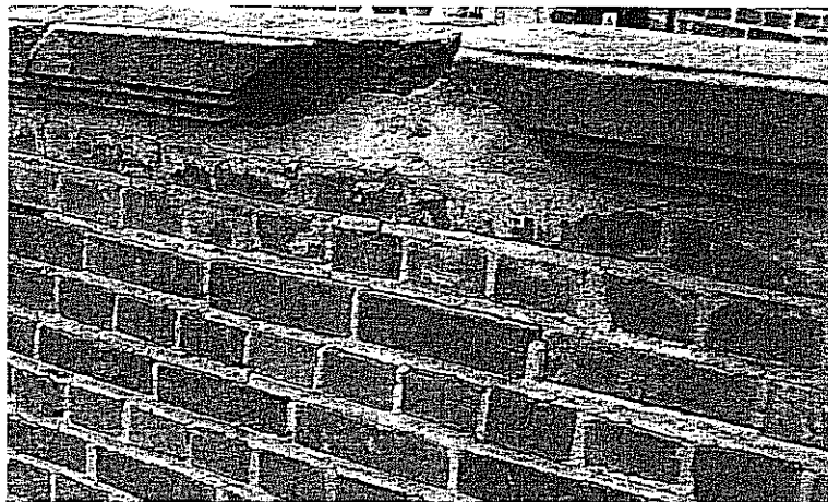
Fot. 2.39. Poziome pęknięcie muru
