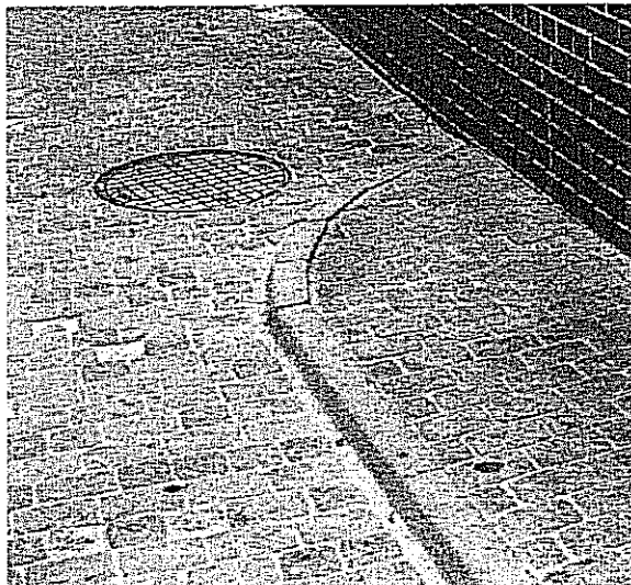
Fot. 2.1. Zniszczenie górnej powierzchni lub wciśnięcie elementów z kostki betonowej.
