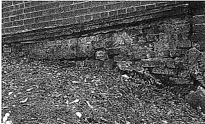
Fot 2.36. Pęknięcie muru w miejscu styku ze skrzydłem. Ubytki spoiwa i cegieł w murze .
