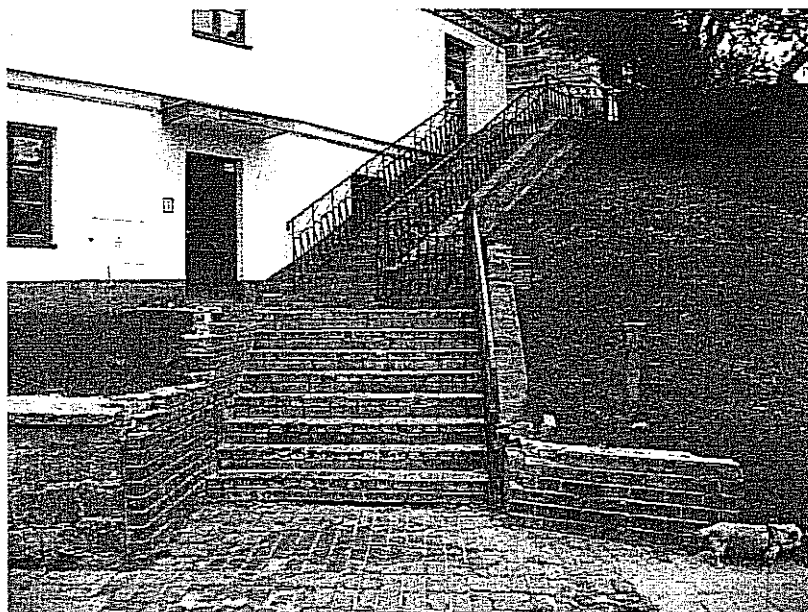
Fot. 2.70. Zniszczenie murku ograniczającego schody od nasypu
