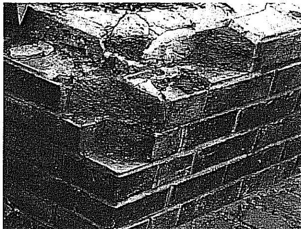
Zdj. 1.11. Uszkodzenie murku oporowego schodów
