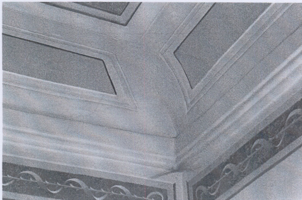
Fot. nr 7 - Budynek Trybunału Koronnego, Lublin, Rynek 1, sala 206 – pęknięcia ściany w narożniku i na fasecie. Luty. 2008, wyk. Maciej Baran.
