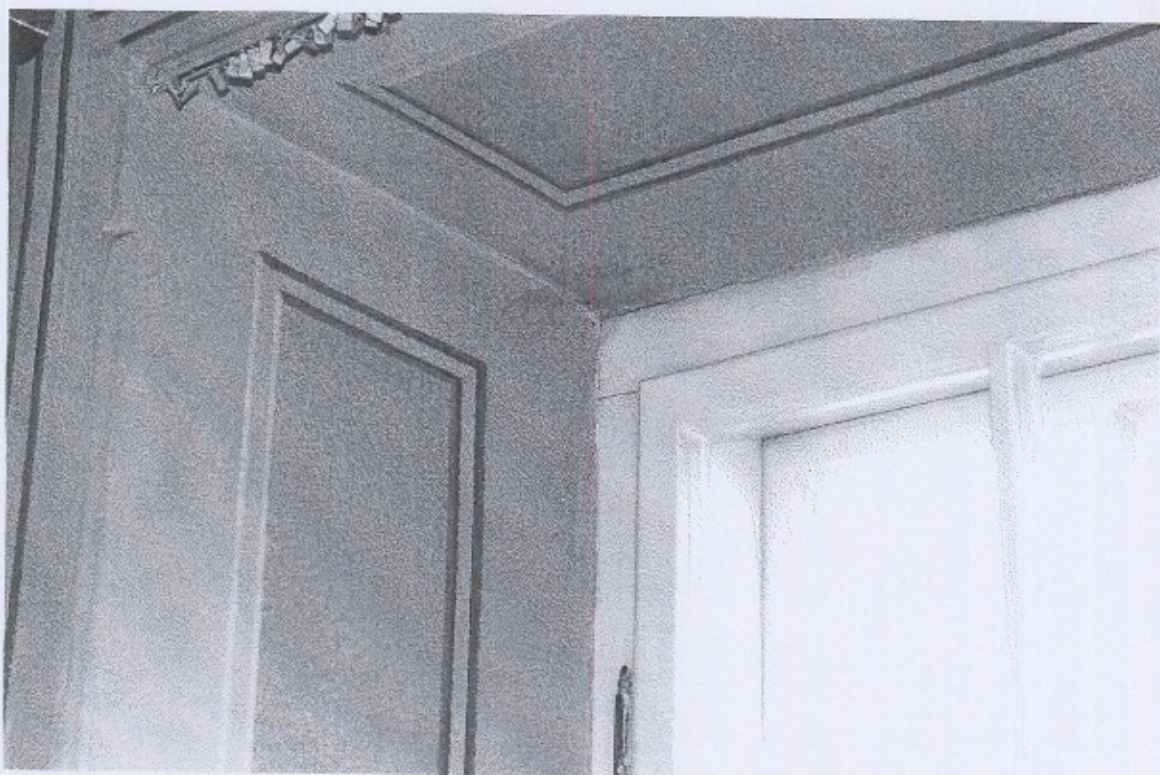
Fot. nr 9 - Budynek Trybunału Koronnego, Lublin, Rynek 1, sala 206 – zabrudzenia w glifie okiennym. Luty. 2008, wyk. Maciej Baran.
