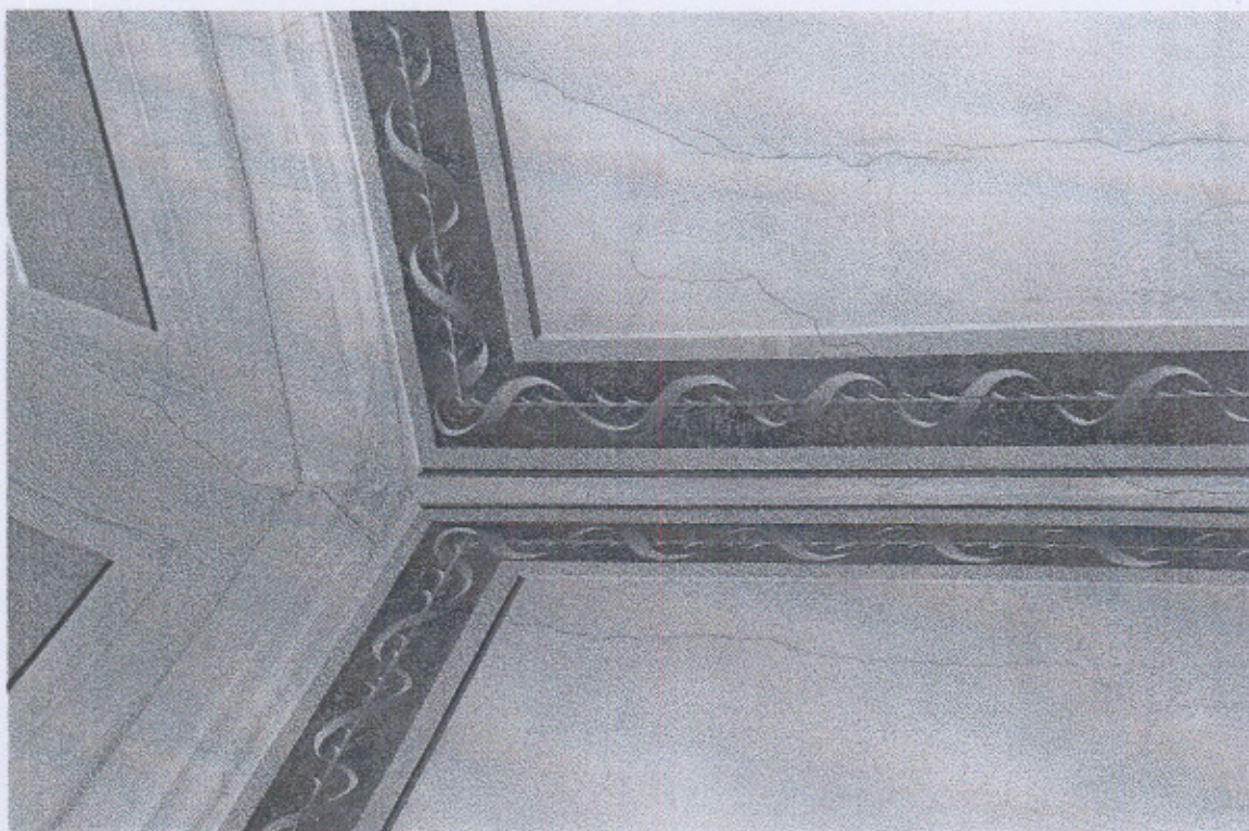
Fot. nr 6 - Budynek Trybunału Koronnego, Lublin, Rynek 1, sala 206 – pęknięcia ściany w narożniku. Luty. 2008, wyk. Maciej Baran.
