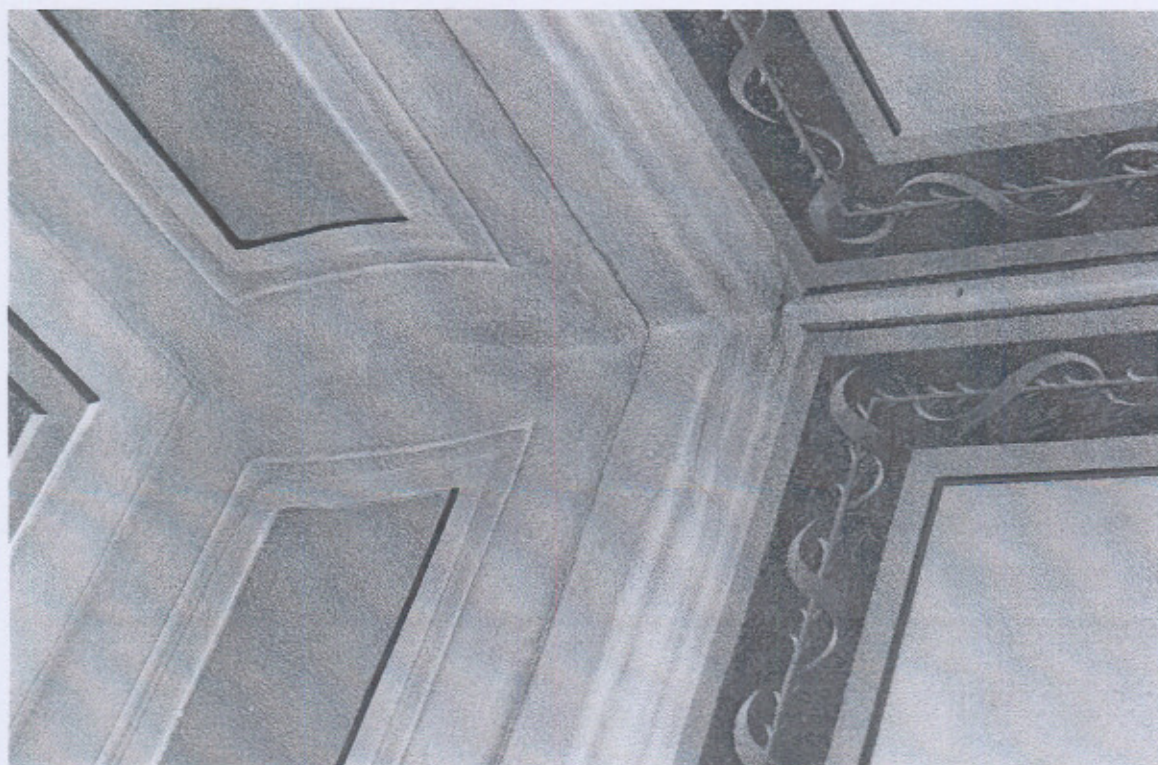
Fot. nr 8 - Budynek Trybunału Koronnego, Lublin, Rynek 1, sala 206 – zabrudzenia na fasecie. Luty. 2008, wyk. Maciej Baran.
