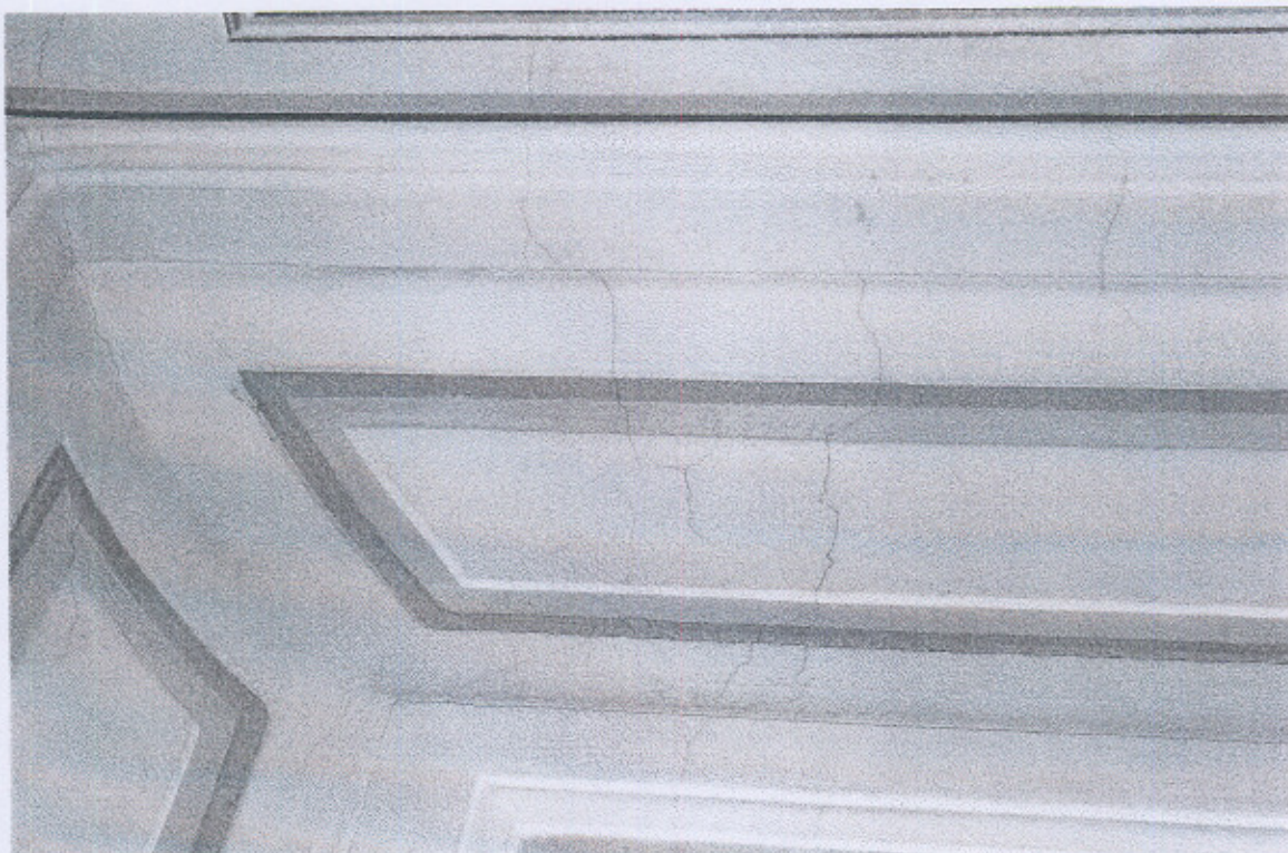
Fot. nr 13 - Budynek Trybunału Koronnego, Lublin, Rynek 1, sala 205 – spękania na fascie. Zdjęcie wyk. Luty. 2008, wyk. Maciej Baran.
