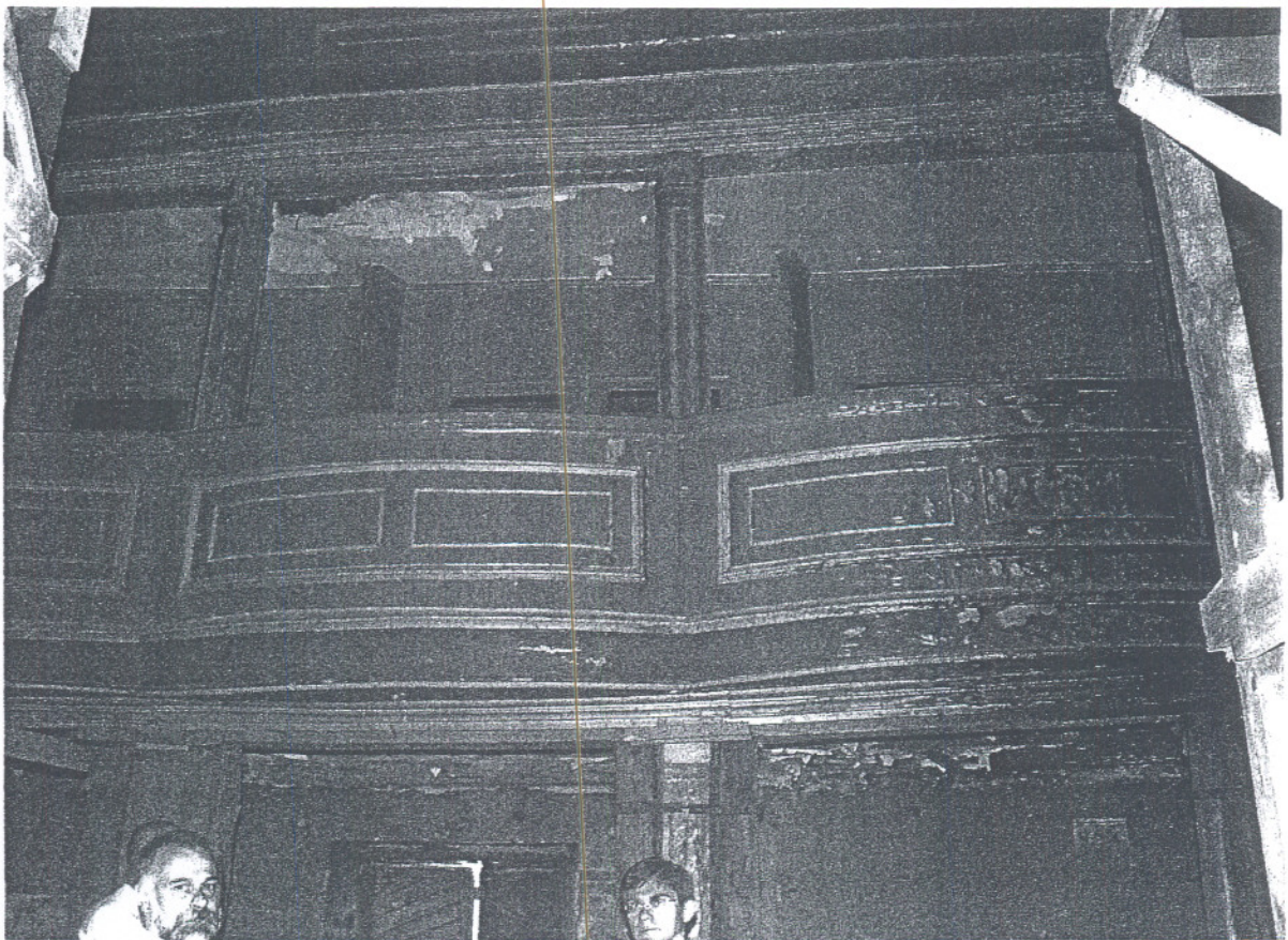
Fot. Nr 8 Teatr Stary w Lublinie, ul. Jezuicka18, drewniane loże, stan zachowania przed rozpoczęciem prac rozbiórkowych. II kondygnacja łóż - balkony. Widoczne nadpalone loże
