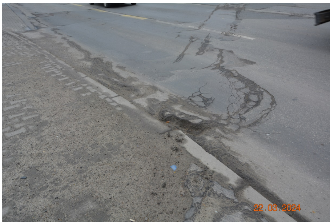
Fot. 22. Zanieczyszczenia, deformacje, zarysowania, przemieszczenia i wykruszenia nawierzchni jezdni na pomoście i dojazdach
