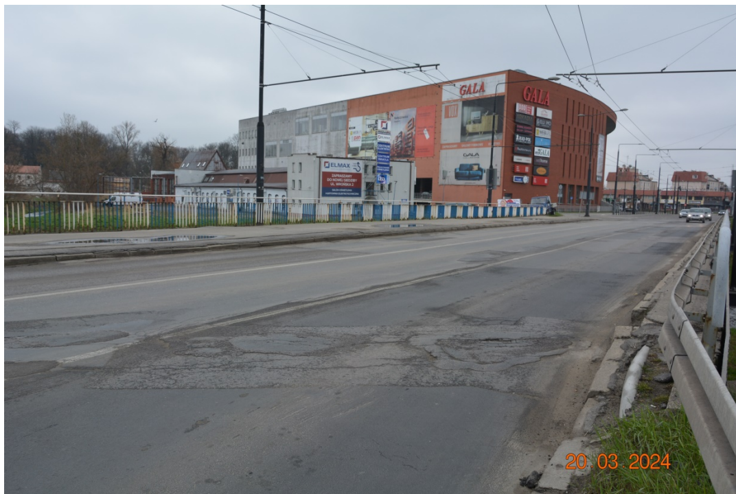
Fot. 21. Deformacje, zarysowania, przemieszczenia i wykruszenia nawierzchni jezdni w obszarach dojazdów i na pomoście. Widoczne zaniżenia terenu na dojazdach z powodu osiadania gruntu. Ubytki i przemieszczenia krawężników.
