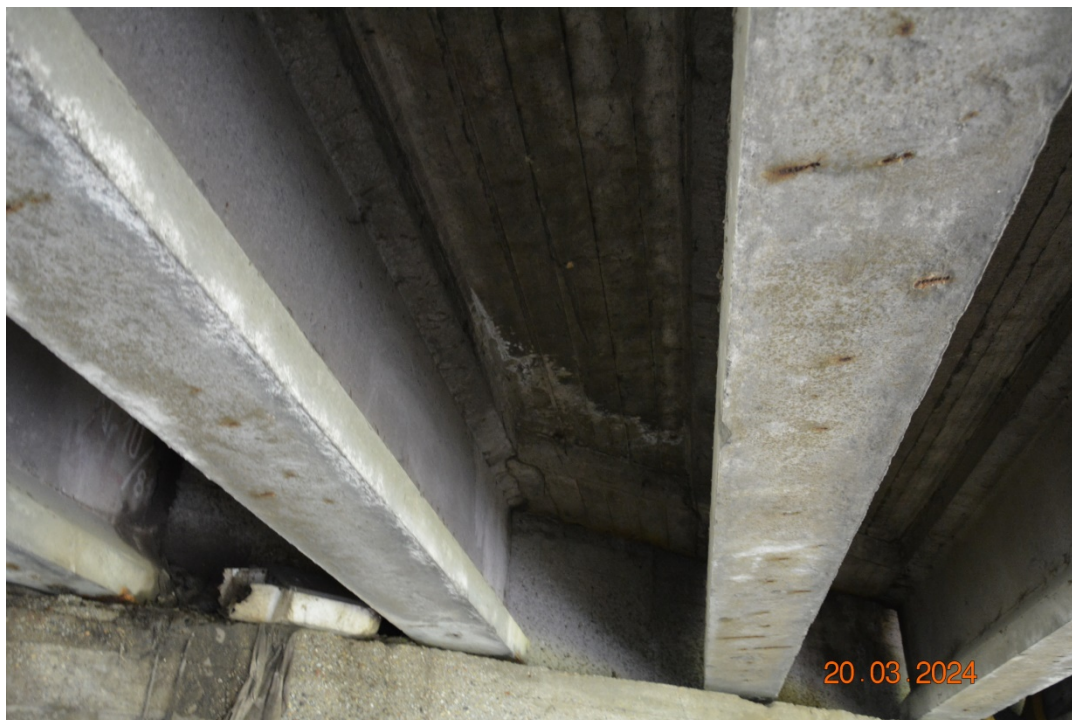
Fot. 31. Widoczne lokalne przecieki przez pomost świadczące o nieszczelności izolacji. Typowy stan pomostu i dźwigara: lokalne przecieki i wykwyty, lokalna korozja zbrojenia, odpryski otuliny. Widoczne przecieki przez dylatację nad podporą 4.
