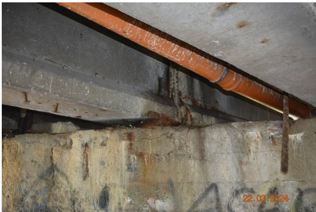
Fot. 38. Typowy stan podpór pośrednich 2 i 3. Uszkodzenia oczeput filarów: przecieki wody, wegetacja roślin, korozja zbrojenia w następstwie nieszczelności dylatacji.
