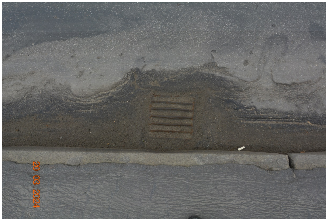
Fot. 29. Zanieczyszczenie wpustów powodujące lokalnie całkowitą niedrożność
