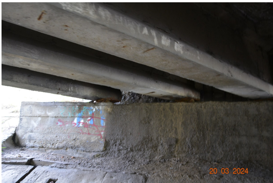
Fot. 40. Typowe uszkodzenia przyczółków, m.in.: przecieki wody i osady (świadczące o nieszczelności stref dylatacyjnych), pęknięcia, korozja zbrojenia, zanieczyszczenia graffiti.
