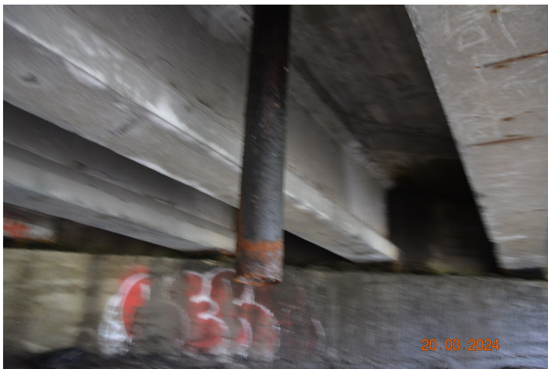
Fot. 30. Korozja rur spustowych
