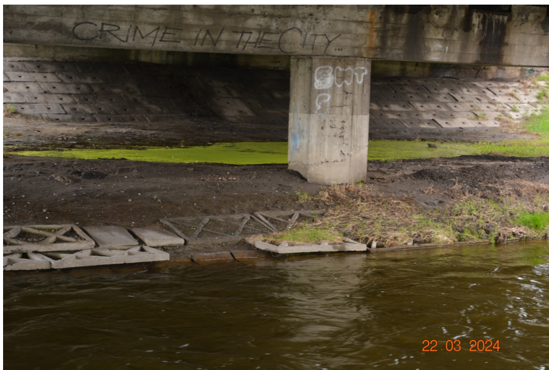
Fot. 42. Przemieszczenia i ubytki umocnień koryta
