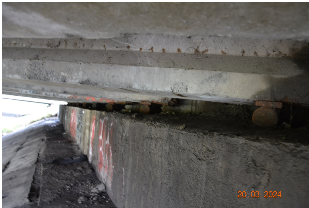
Fot. 35. Widoczne przecieki przez pomost w strefach dylatacyjnych. Typowy stan podpór: przecieki, zacieki, wykwyty, korozja zbrojenia miękkiego, odpryski otuliny, zanieczyszczenie graffiti.
