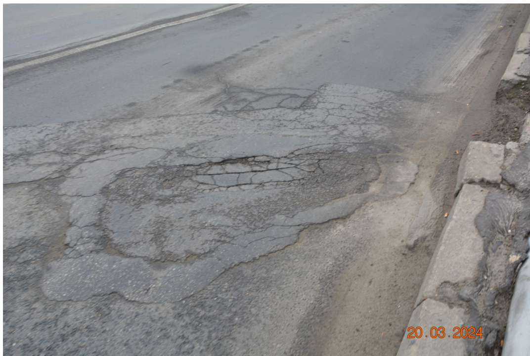
Fot. 23. Deformacje, zarysowania, przemieszczenia i wykruszenia nawierzchni jezdni w obszarach dojazdów i na pomoście. Widoczne zaniżenia terenu na dojazdach z powodu osiadania gruntu. Ubytki i przemieszczenia krawężników.
