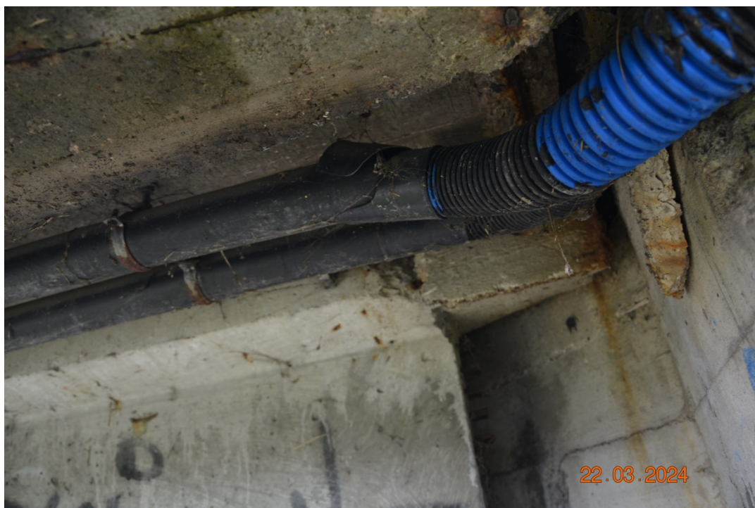
Fot. 44. Lokalne uszkodzenia kanałów osłonowych zasilania oświetlenia.
