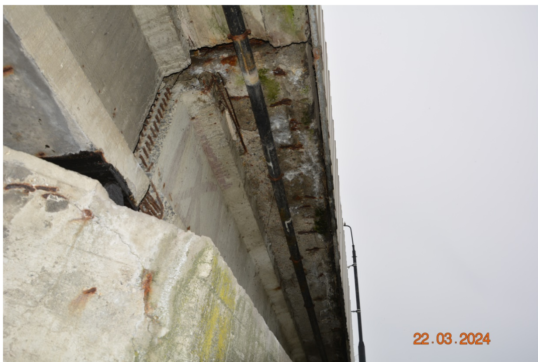
Fot. 28. Lokalnie korozja betonu, zarysowania, przecieki i ubytki betonu, korozja zbrojenia belek podporęczowych osłoniętych blachą maskującą
