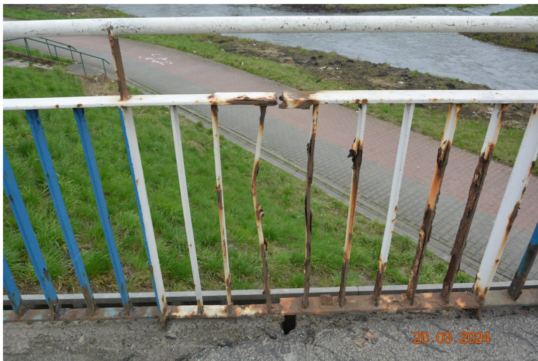
Fot. 26. Lokalna deformacja, korozja i zniszczenie powłok antykorozyjnych balustrad.
