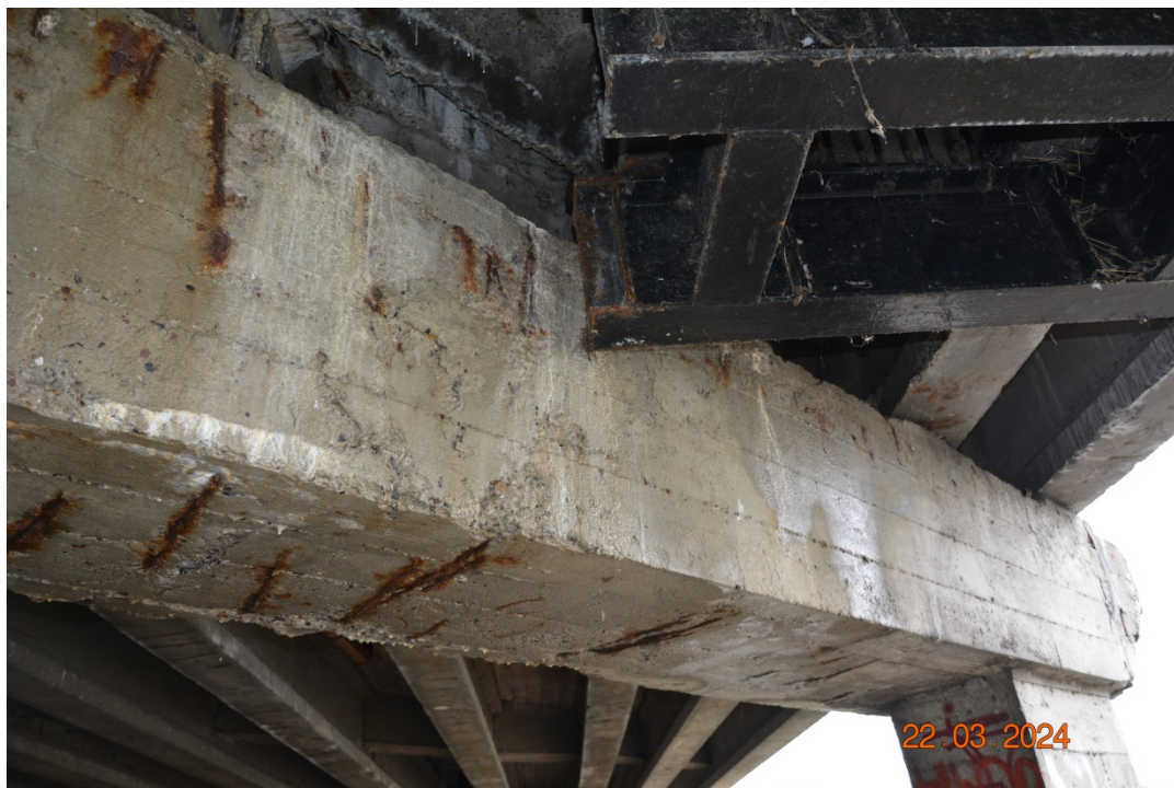
Fot. 43. Zniszczenia powłoki antykorozyjnej i korozja powierzchniowa wsporników trakecji trolejbusowej.
