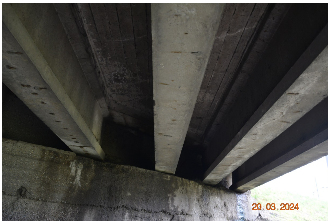
Fot. 32. Widoczne lokalne przecieki przez pomost świadczące o nieszczelności izolacji. Typowy stan pomostu i dźwigara: lokalne przecieki i wykwyty, lokalna korozja zbrojenia, odpryski otuliny. Widoczne przecieki przez dylatację nad podporą 4.
