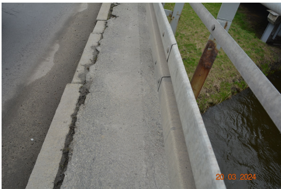
Fot. 24. Zanieczyszczenia, deformacje, zarysowania, przemieszczenia i wykruszenia nawierzchni jezdni na chodniku i kapie pobocza. Przemieszczenia krawężników. Lokalna korozja powierzchniowa barier i balustrad.
