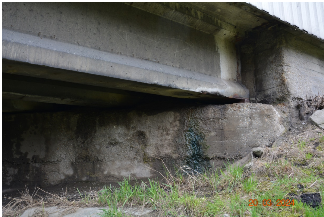
Fot. 39. Typowy stan przyczółków, m.in.: przecieki wody i osady (świadczące o nieszczelności stref dylatacyjnych), pęknięcia, korozja zbrojenia, zanieczyszczenia graffiti.
