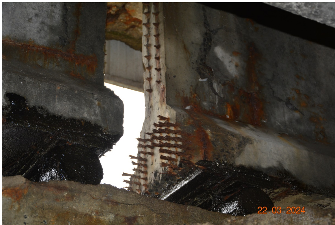
Fot. 41. Lokalne odspojenia i zarysowania otuliny belek dźwigara nad podporami z powodu przecieków przez dylatacje.
