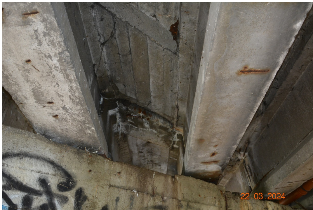
Fot. 33. Widoczne przecieki przez obszary dylatacyjne nad wszystkimi podporami.
