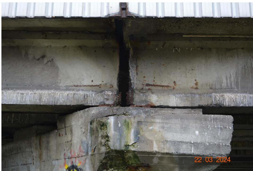
Fot. 34. Widoczne przecieki przez pomost w strefie dylatacyjnej. Typowy stan dźwigarów nad podporami: zacieki, wykwyty, korozja zbrojenia miękkiego, odpryski otuliny.
