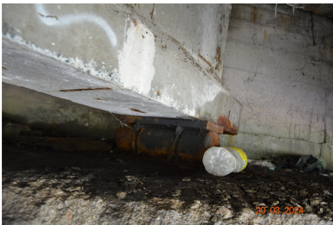
Fot. 36. Typowy stan łożysk części łożysk. Korozja łożysk i blokada przesuwu na skorodowanych łożyskach. Łożyska w trakcie czyszczenia i zabezpieczanie antykorozyjnego
