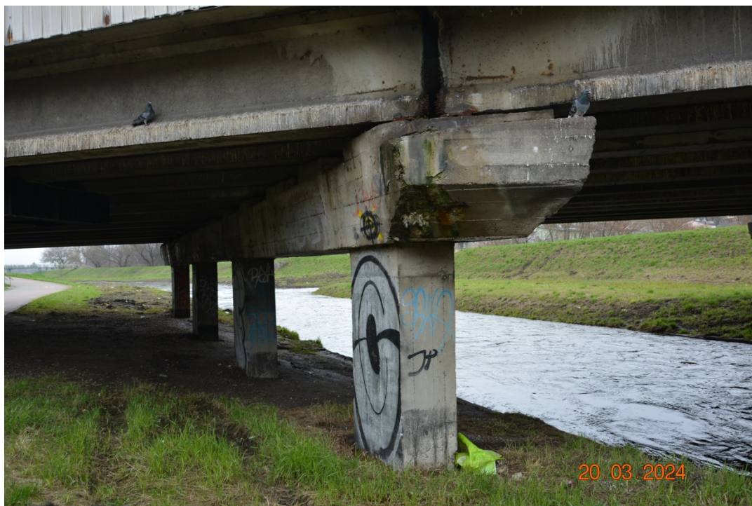
Fot. 37. Typowy stan podpór pośrednich 2 i 3. Uszkodzenia oczeput filara: przecieki wody, wegetacja roślin, korozja zbrojenia w następstwie nieszczelności dylatacji. Zarysowania słupów spowodowane korozją zbrojenia wywołaną zawilgoceniem od przeciekającej z pomostu wody, zanieczyszczenia graffiti.
