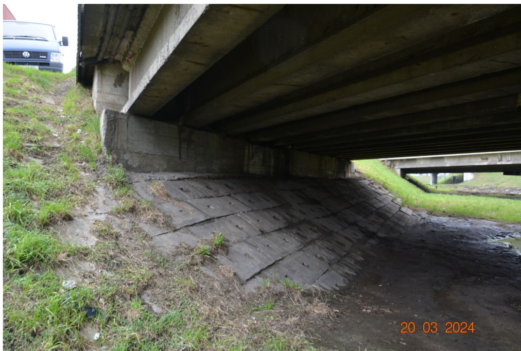
Fot. 19. Zarysowania, deformacje i ubytki betonu umocnienia skarp przy przyczółkach. Wegetacja roślinności na umocnieniach skarp przy przyczółkach. Lokalne ubytki i zanieczyszczenie terenu pod obiektem odpadami komunalnymi.
