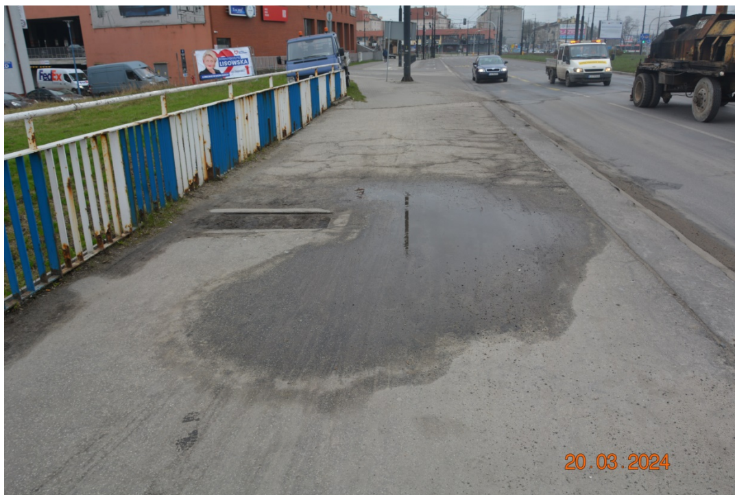
Fot. 25. Lokalna korozja i zniszczenie powłok antykorozyjnych balustrad. Zanieczyszczenia, deformacje, zarysowania, przemieszczenia i wykruszenia nawierzchni na chodniku.
