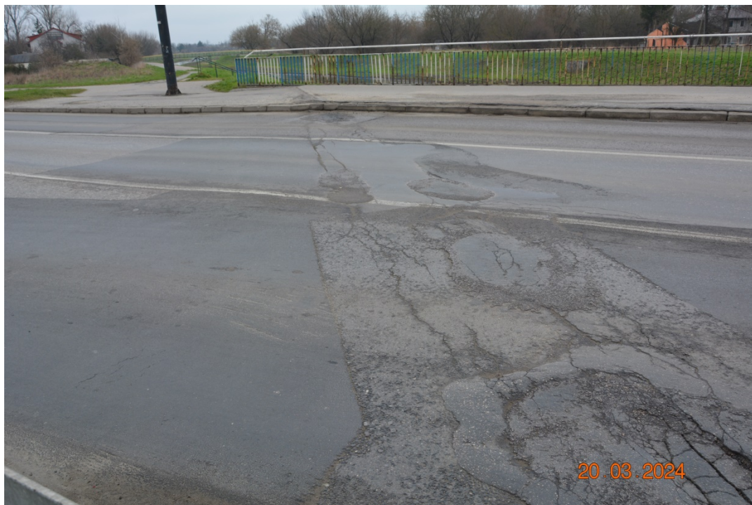
Fot. 20. Deformacje, zarysowania, przemieszczenia i wykruszenia nawierzchni jezdni w obszarach dojazdów i na pomoście. Widoczne zaniżenia terenu na dojazdach z powodu osiadania gruntu.
