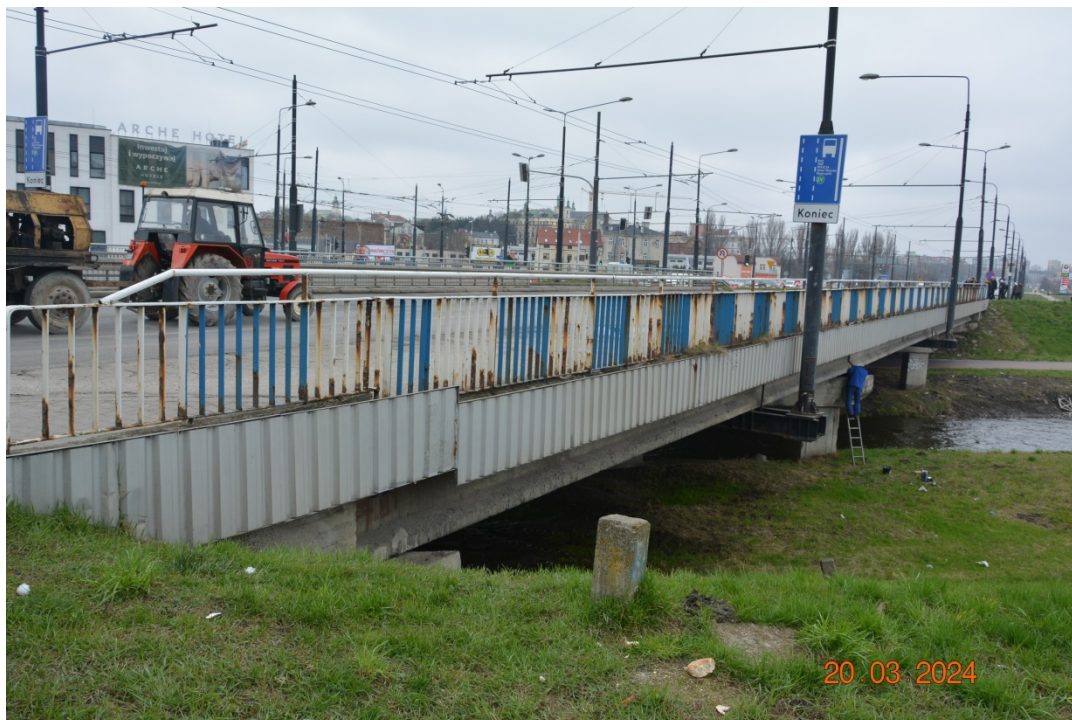
Fot. 27. Lokalnie korozja betonu, zarysowania, przecieki i ubytki betonu belek podporęczowych osłoniętych blachą maskującą.
