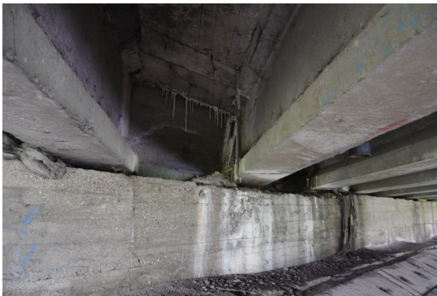
Fot. 11. Typowy stan podpór skrajnych pod nieuszczelnionymi dylatacjami. Zacieki, wykwit, ubytki, spękania i korozja betonu, lokalna korozja zbrojenia.
