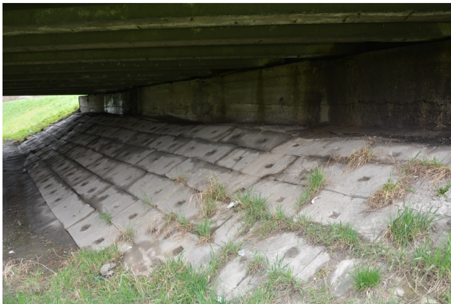
Fot. 5. Stan skarp i umocnień. Widoczne zanieczyszczenia, przemieszczenia elementów i wegetacja roślin na pomoście umocnieniach skarp.
