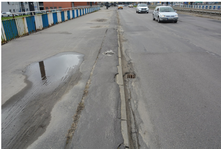
Fot. 8. Deformacje nawierzchni jezdni, utrudniają odpływ wody. Część wpustów niedrożna. Nawierzchnia chodnika i kapy zdeformowana, spękana, zarysowana z ubytkami. Występuje wegetacja roślin. Przemieszczenia i ubytki krawężników.
