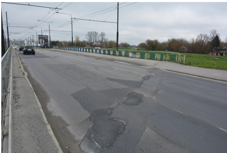
Fot. 6. Nawierzchnia na dojazdach zaniżona względem obiektu. Nawierzchnia jezdni, zdeformowana, spękana, zarysowana z ubytkami. Nad strefami dylatacji, nawierzchnia zarysowana i nieuszczelna.
