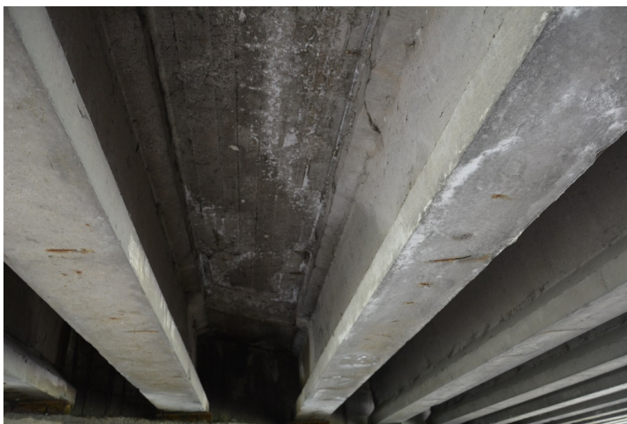
Fot. 9. Płyta pomostu z lokalnymi wykwitami, i korozją betonu, ubytkami i lokalną korozją zbrojenia. Korozja zbrojenia i ubytki otuliny oraz wykwit na betonie dźwigarów.
