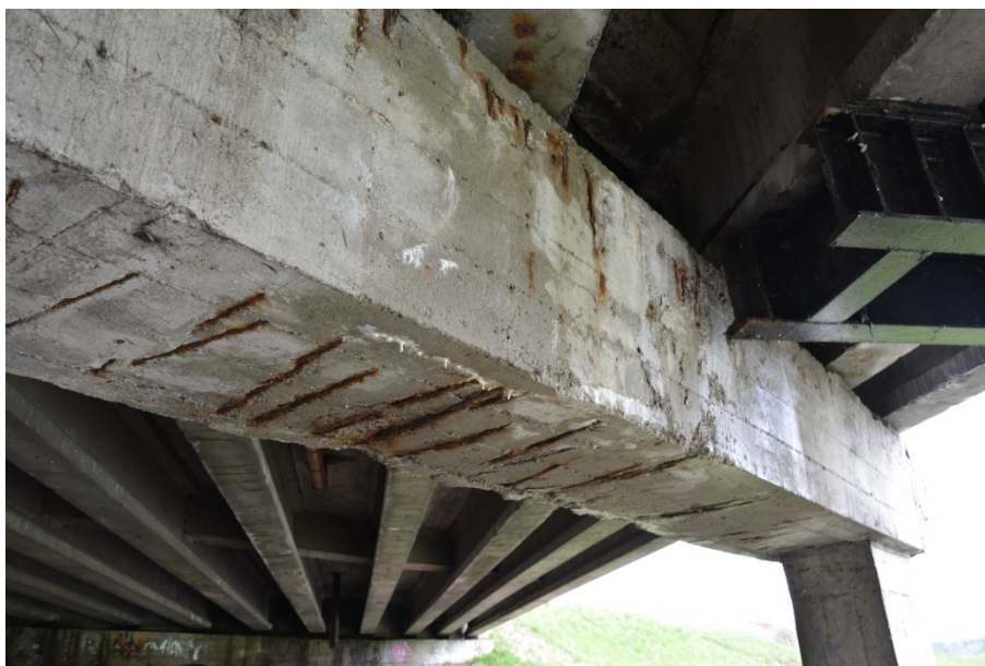
Fot. 12. Typowy stan podpór pośrednich pod nieuszczelnionymi dylatacjami. Zacieki, wykwit, ubytki, spękania i korozja betonu, lokalna korozja zbrojenia rozdzielczego.
