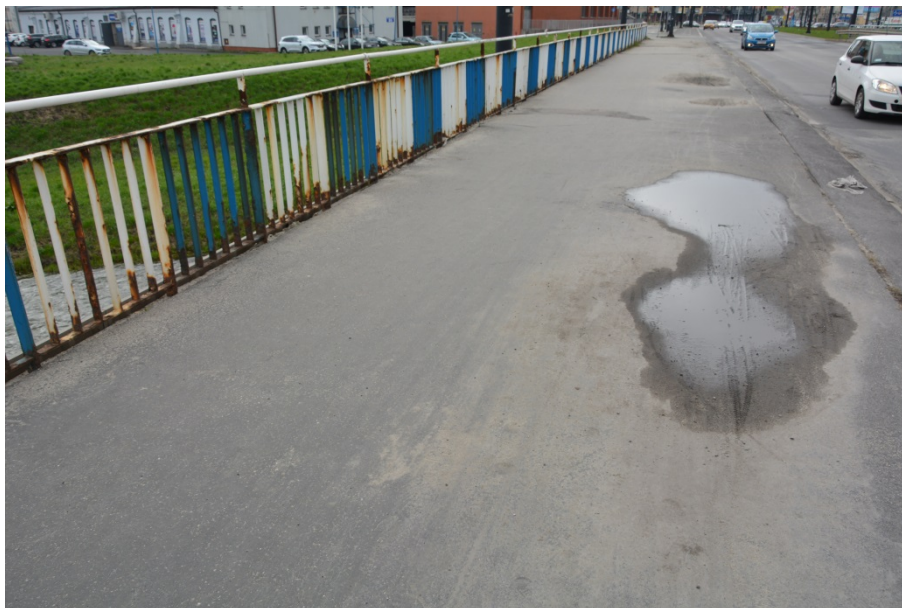
Fot. 7. Stan chodnika. Nawierzchnia zdeformowana, tworzą się zastoiska wody, zarysowana z ubytkami. Przemieszczenia i ubytki krawężników.
