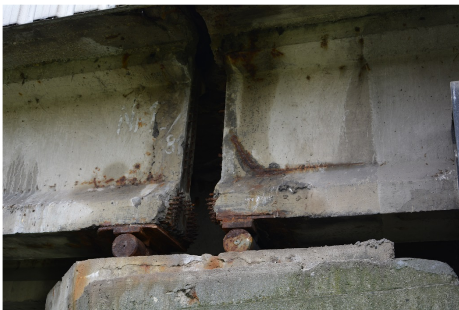
Fot. 10. Dźwigary z lokalną korozją zbrojenia i ubytkami otuliny, wykwitami i zaciekami na powierzchni betonu w strefach nadpodporowych.
