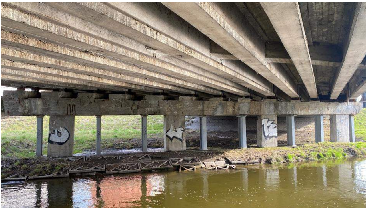
Fot. 69. Przęsło nr 2. Widoczne przebarwienia i wykwyty na powierzchni płyty, świadczące o przeciekach. Stan dźwigarów nie budzi większych zastrzeżeń, wpływa jedynie niekorzystnie na wrażenia estetyczne przez osiedlenie się tam ptactwa.
