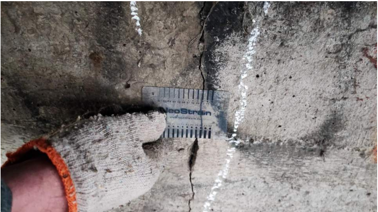
Fot. 7. Miejsce pomiarowe nr 4 na podporze P1. Pomierzona rysa 1,0 mm.
