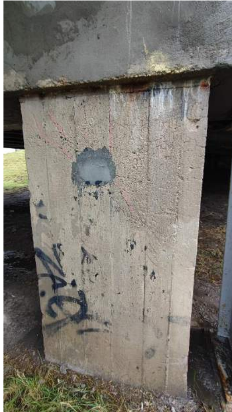
Fot. 17. Miejsce pomiarowe podpora P3. Pomierzona rysa 0,8 mm.
