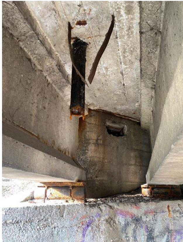
Fot. 63. Przecieki przez płytę pomostu powodujące wykwyty a) na płycie pomostu przy dźwigarze skrajnym nr 1. Intensywna korozja i niedrożność rury wpustowej..
