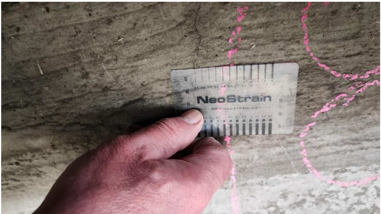
Fot. 56. Pomierzona rysa 0,1 mm.
