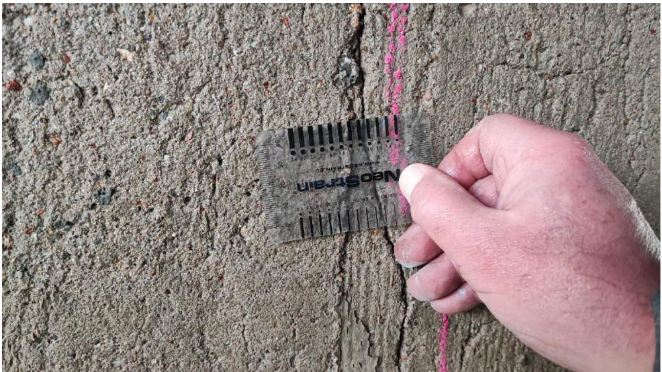
Fot. 30. Pomierzona rysa 1,75 mm.
