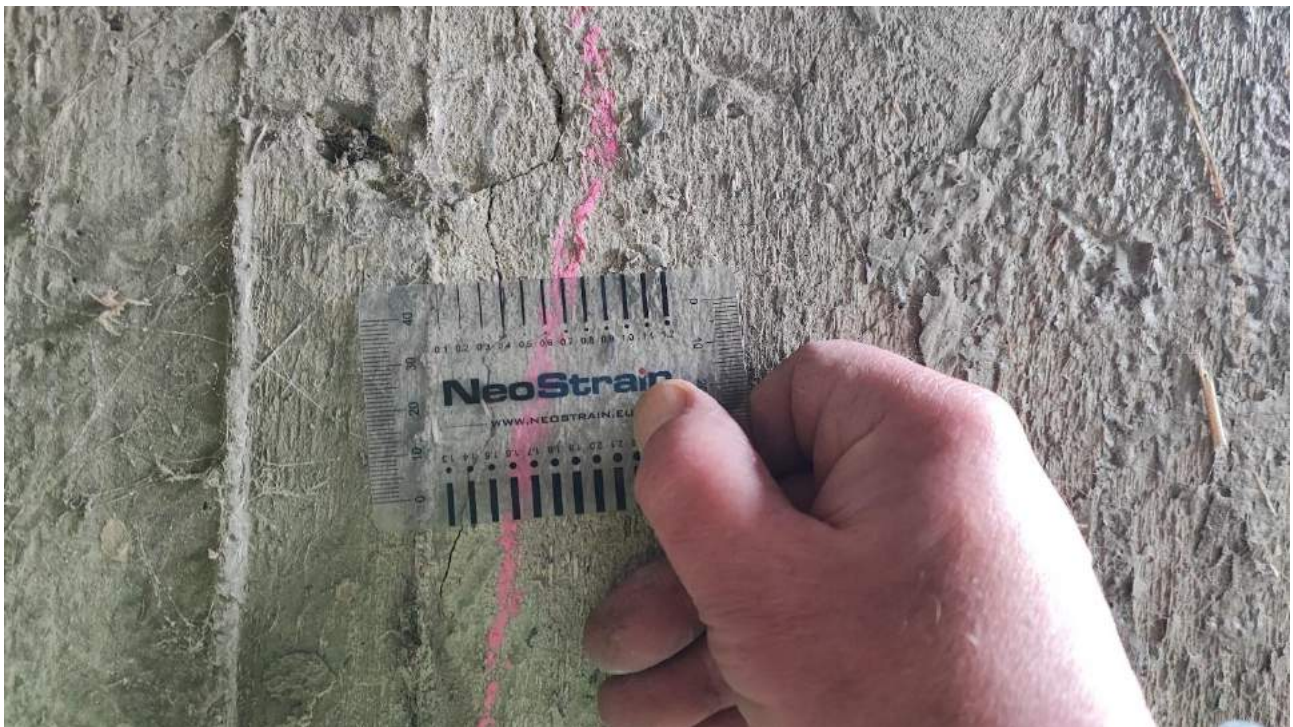
Fot. 22. Pomierzona rysa 0,4 mm.
