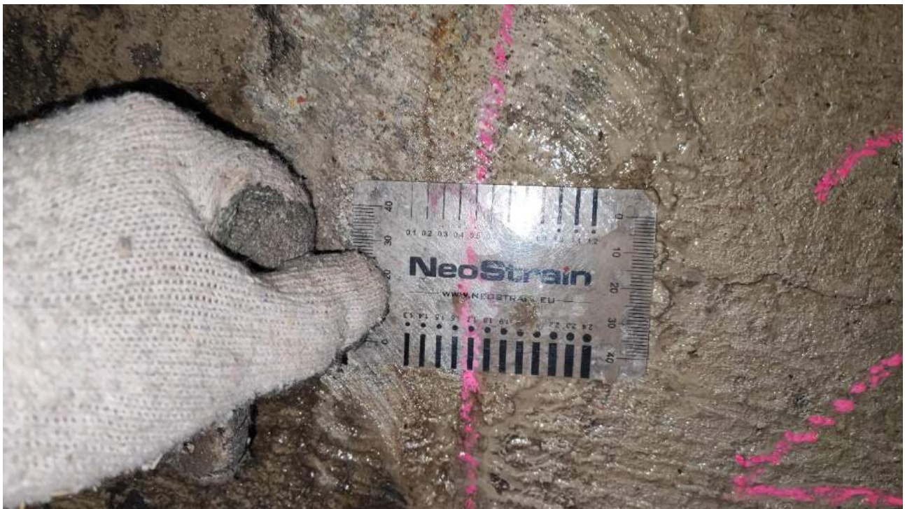
Fot. 46. Pomierzona rysa .. mm.
