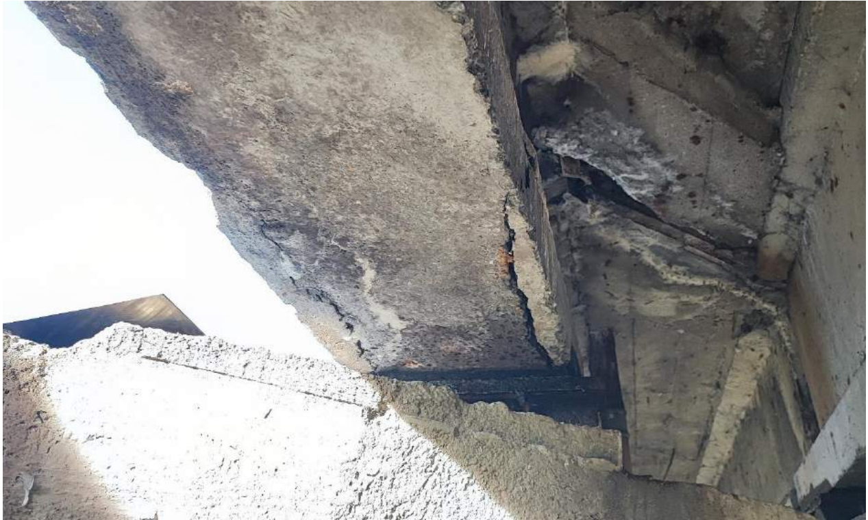
Fot. 41. Podpora P3. Uszkodzenie belki prawej od strony górnej wody - strefa podparcia
