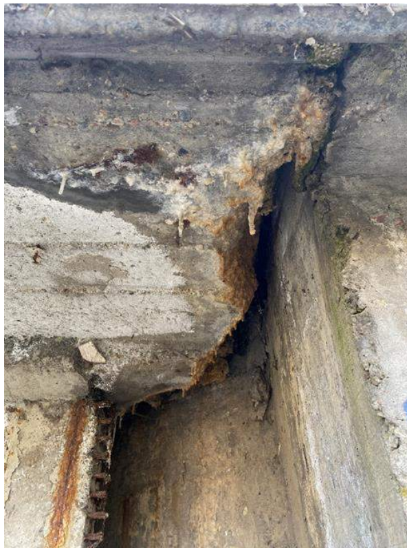
Fot. 68. Przęsło nr 1, belka skrajna od strony DW. Ubytki w otulinie zbrojenia, skorodowane i rozwarstwione zbrojenie sprężające. Ubytki w przekroju belki. Zacieki i wykwyty na belce. Intensywna korozja łożyska wałkowego.
