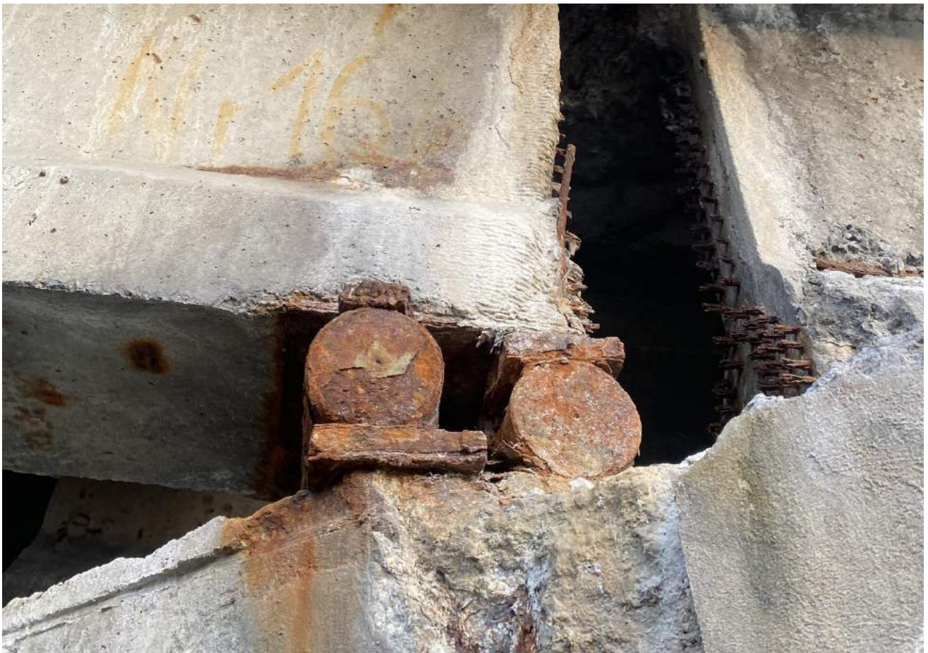
Fot. 42. Podpora P3. Podparcie belki środkowej od strony górnej wody
