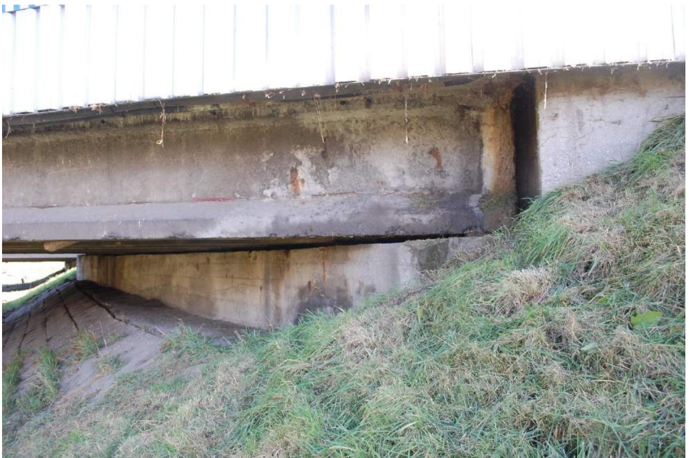
Fot. 58. Widok na podporę P4. Na ścianie czołowej i zapleczej osady i wykwity w wyniku przecieków dylatacji. Lokalna korozja betonu i zbrojenia w ścinie czołowej.
