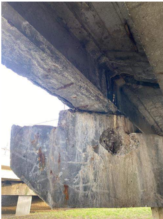
Fot. 13. Podpora P2. Intensywne przecieki na oczepie, spowodowane przeciekami przez dylatacje. Korozja betonu, ubytki w otulinie. Punktowa korozja zbrojenia oczepu.
