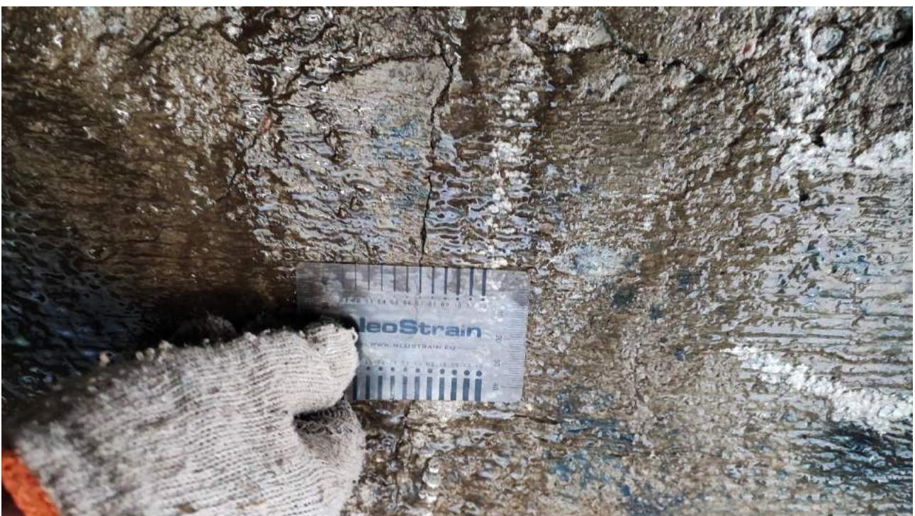
Fot. 8. Miejsce pomiarowe nr 5 na podporze P1. Pomierzona rysa 0,7 mm.
