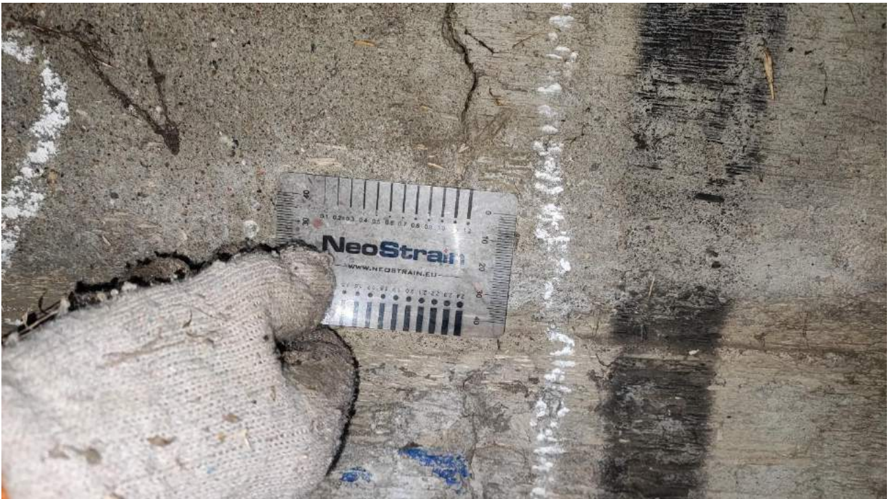
Fot. 5. Miejsce pomiarowe nr 2 na podporze P1. Pomierzona rysa 1,1 mm.
