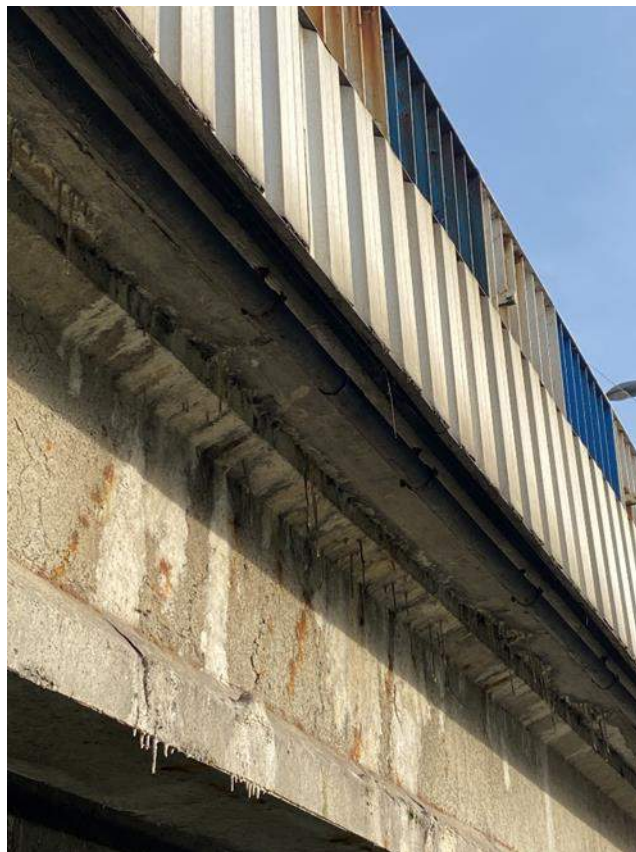
Fot. 64. Przęsło nr 1 wykwyty na skrajnym dźwigarze prawym.
