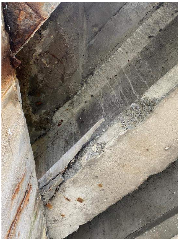
Fot. 70. Przęsło nr 2, belka druga nad podporą P2. Odspojenia otuliny na długości ok. 1m. Przebarwienia, zacieki i wykwyty w wyniku przecieków przez dylatacje. Lokalna korozja zbrojenia belek.
