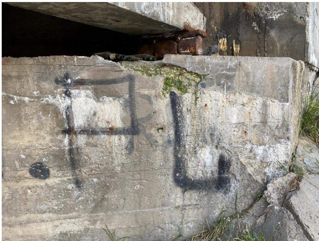
Fot. 10. Podpora P1 od strony DW. Zarysowania ukośne, przecieki, wykwyty i korozja biologiczna w narożu ściany czołowej od strony DW. Intensywna korozja betonu i punktowa korozja zbrojenia. Zawilgocenia, wykwyty na ścianie zapleczej. Intensywna korozja łożyska wałkowego.
