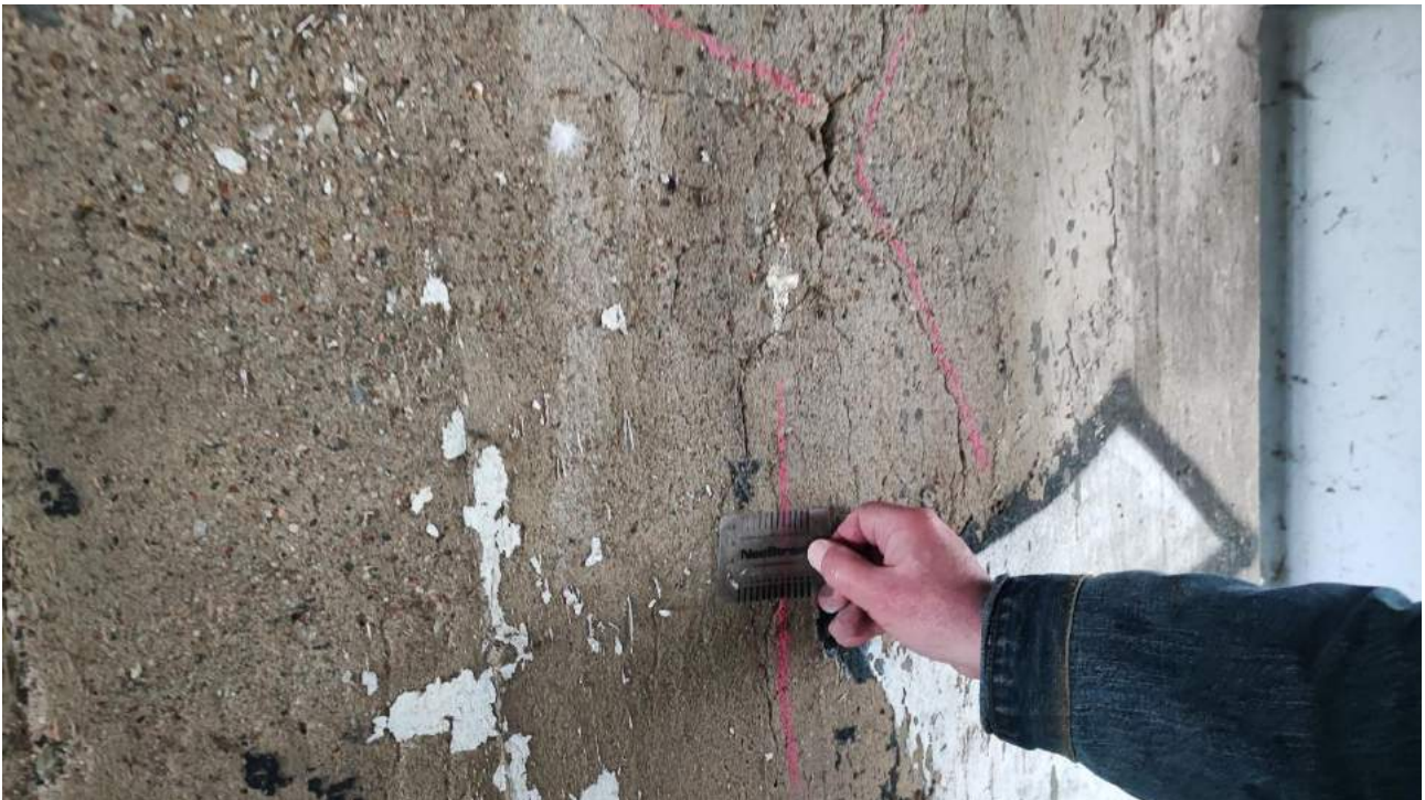
Fot. 32. Pomierzona rysa 0,7 mm.
