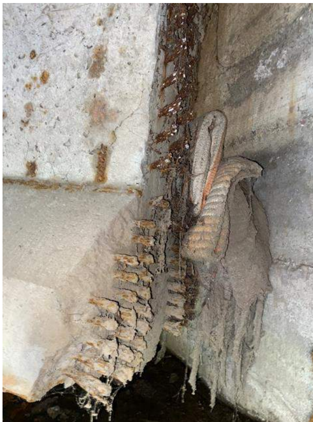
Fot. 65. Przęsło nr 1 belka w środku przęsła, skorodowane zbrojenie sprężające, ubytki w przekroju zbrojenie wynoszą 100% ..
