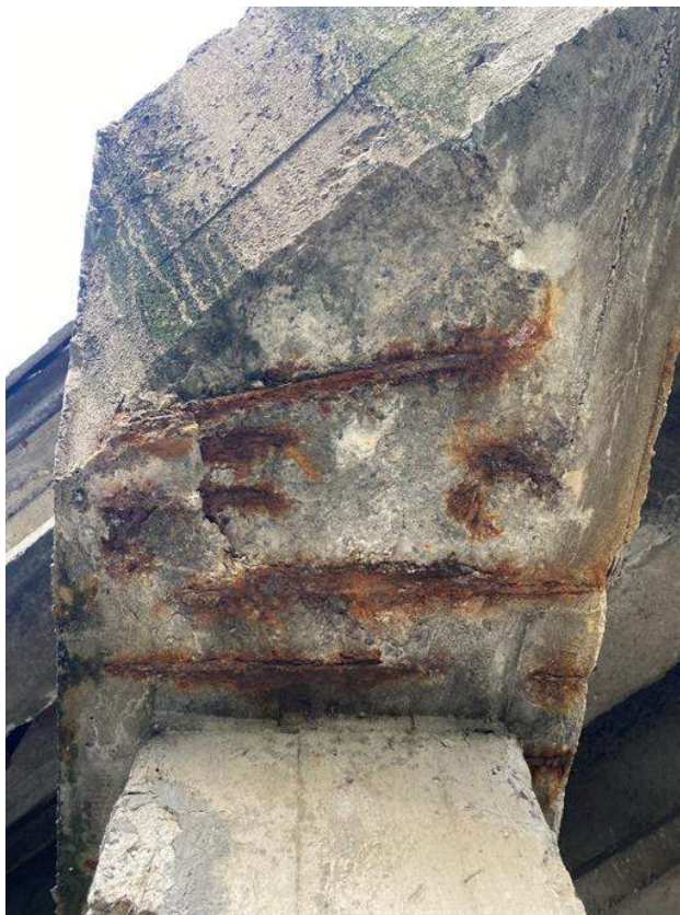
Fot. 15. Podpora P2 wspornik oczepu od strony GW - zacieki z dylatacji powodujące intensywną korozję betonu, jego odpryski w oczepie i słupie.
