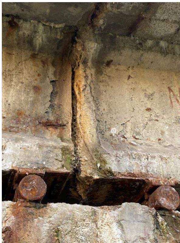
Fot. 72. Belka skrajna od strony DW, nad podporą P-3. Na obydwu belkach korozja betonu, przecieki i wykwit na płycie pomostu. Korozja zbrojenia pomostu oraz zbrojenia sprężającego belek.
