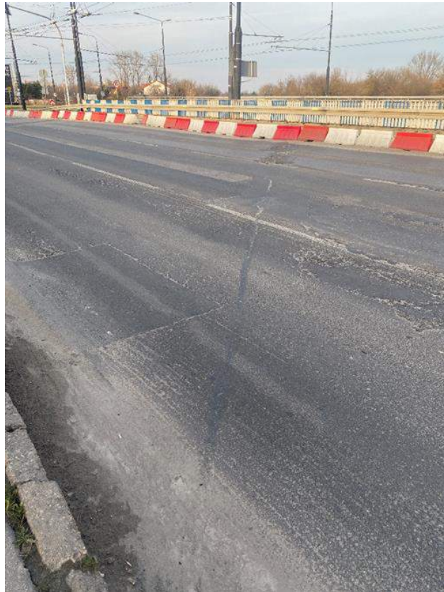
Fot. 79. Dylatacja nad podporą P2. Niewielkie spękania w obrębie dylatacji. Niewielkie koleiny i deformacje nawierzchni.
