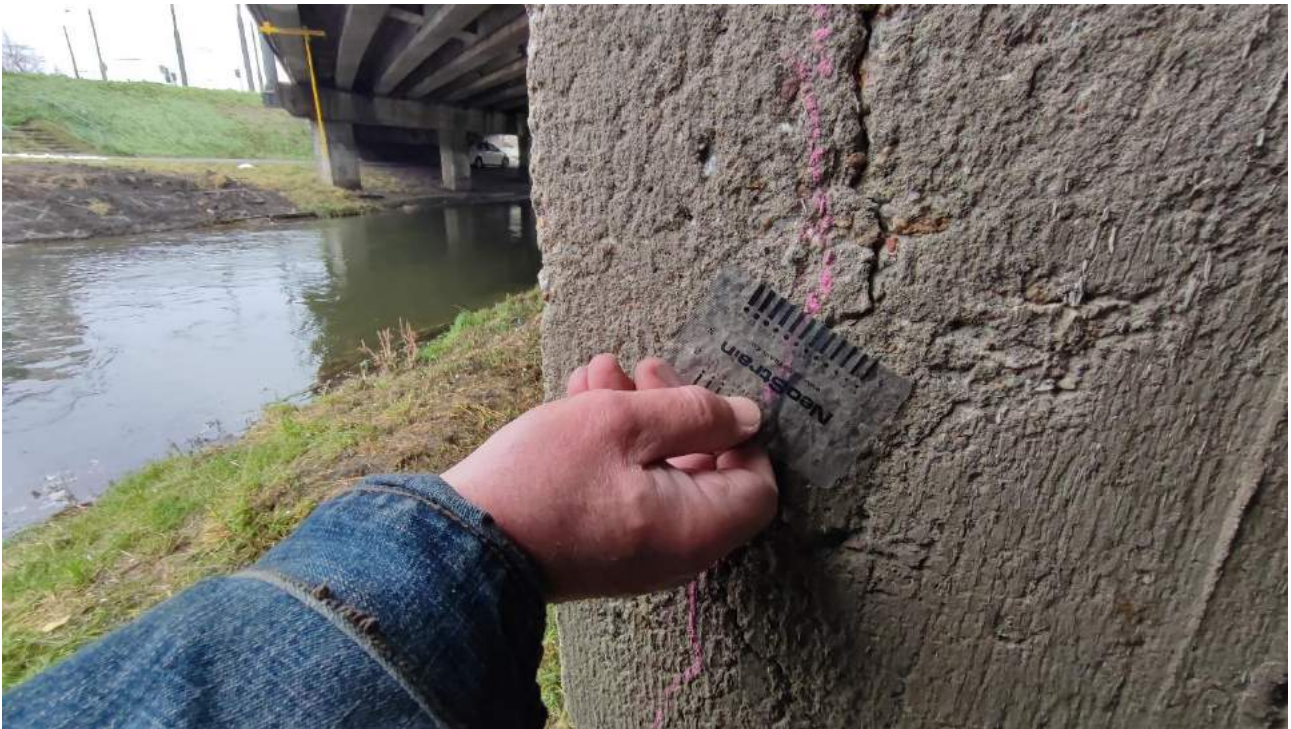
Fot. 19. Miejsce pomiarowe podpora P3 (fot.18). Pomierzona rysa 1,8 mm.
