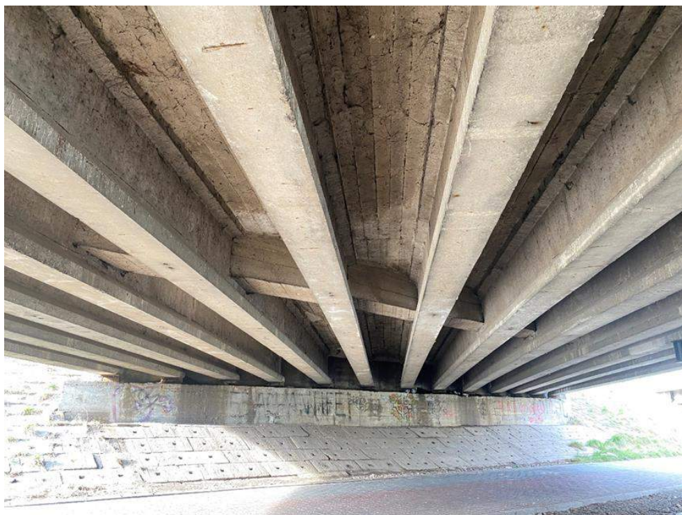
Fot. 61. Widok przęsła 1, w kierunku podpory P1. Na płycie i dźwigarach widoczne przecieki i wykwyty solne. Punktowa korozja zbrojenia w dźwigarach.
