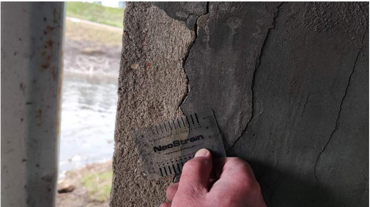
Fot. 20. Miejsce pomiarowe podpora P3. Pomierzona rysa 1,0 mm.
