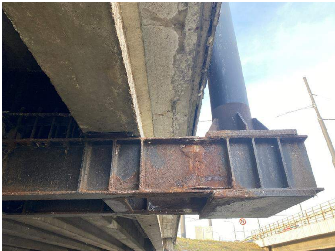
Fot. 76. Słup trakcji trolejbusowej zamocowany do belki skrajnej od strony DW. Korozja zamocowania słupa.
