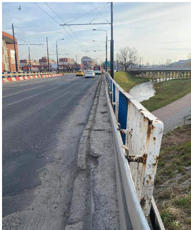
Fot. 81. Widok wzdłuż prawostronnej opaski. Ubytki, zniżenie i przerwana ciągłość krawężnika. Ubytki w nawierzchni opaski, odsłonięte urządzenia obce. Zanieczyszczenia pasa ruchu. Korozja balustrady, występująca na całej długości mostu.
