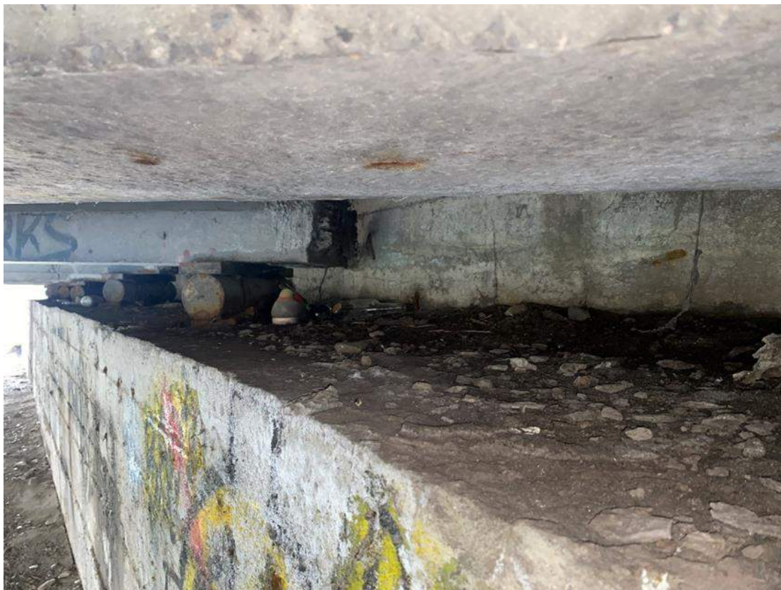
Fot. 9. Widok na stan ławy podłożyskowej. Ława podłożyskowa zanieczyszczona, widoczne zacieki na ścianie zapleczej, lokalna korozja zbrojenia.
