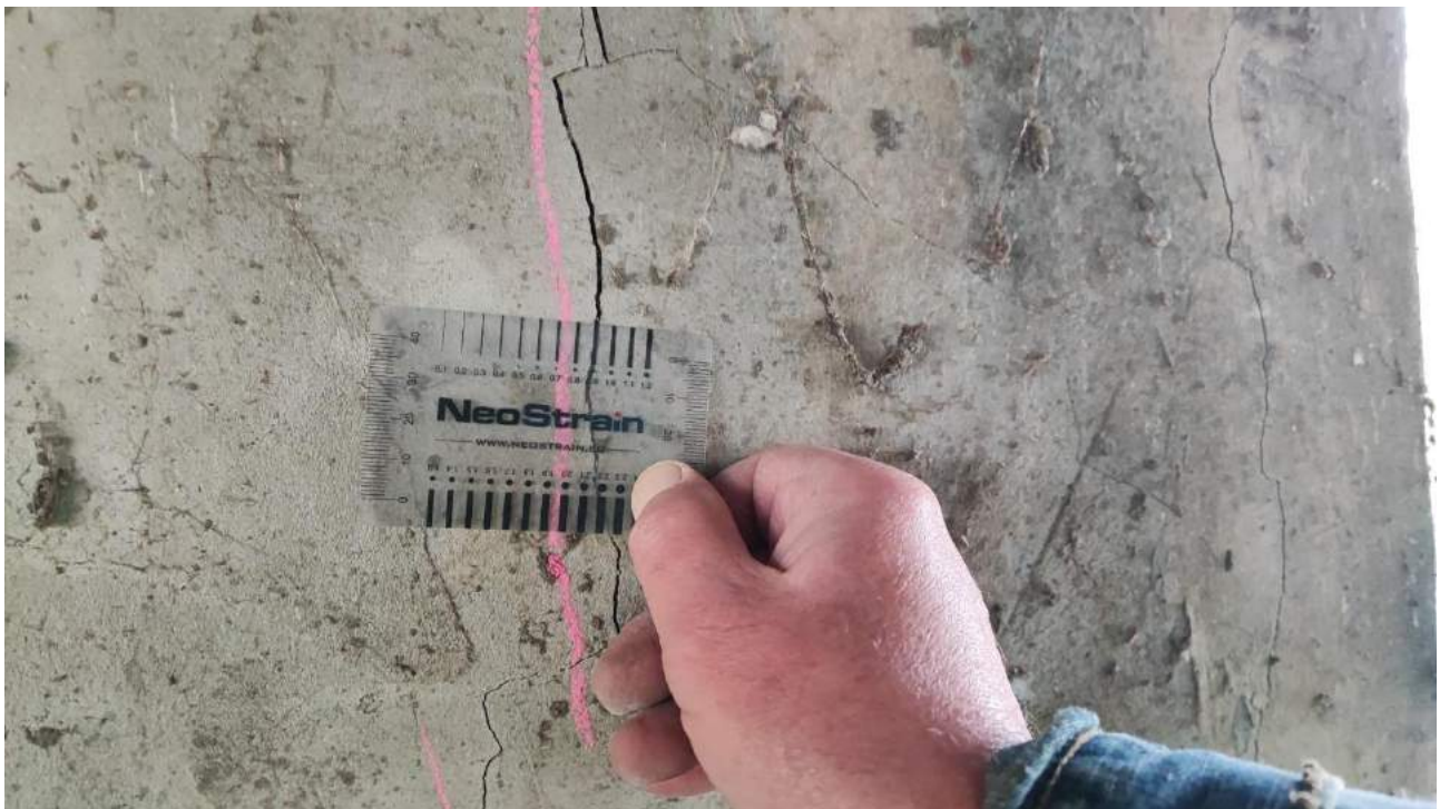
Fot. 26. Pomierzona rysa 0,9 mm.
