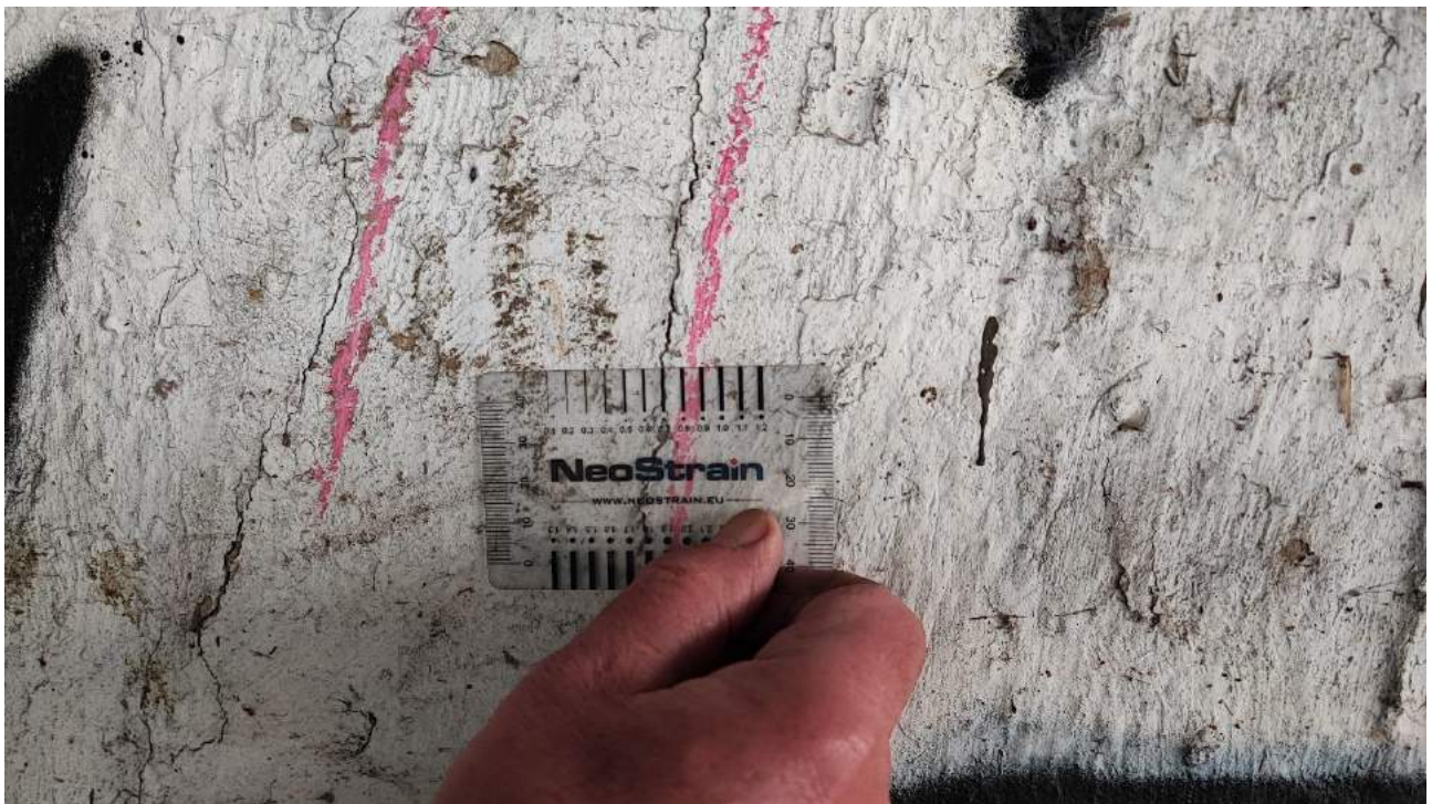
Fot. 28. Pomierzona rysa 0,8 mm.
