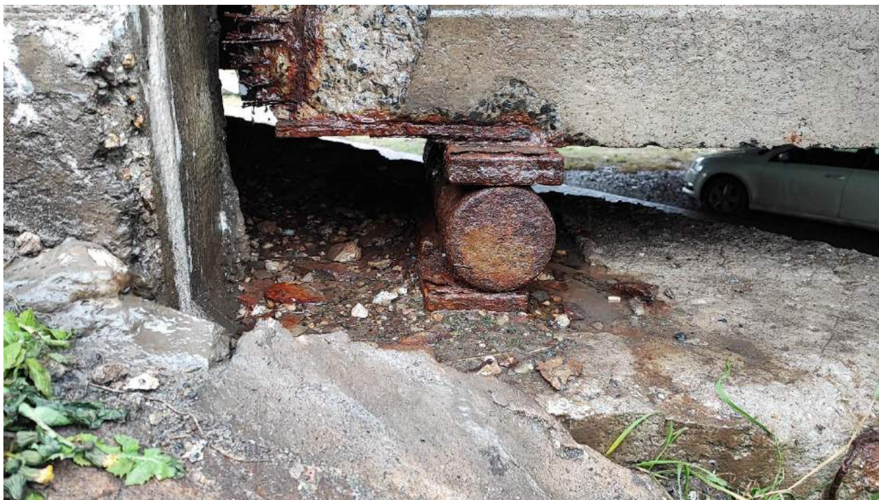
Fot. 12. Podpora P1 od strony GW. Intensywna korozja łożyska wałkowego. Korozja zbrojenia w dźwigarze skrajnym.
