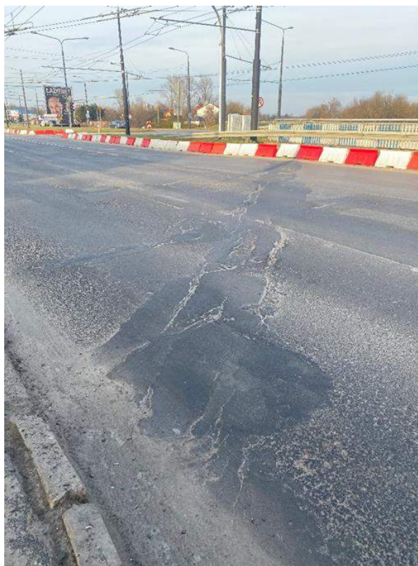
Fot. 77. Dojazd od str. Al. Solidarności, dylatacja nad podporą P1. Zaniżenie nawierzchni dojazdu o ok. 4 cm względem nawierzchni na moście. Deformacje podłużne i poprzeczne, spękania nawierzchni na dojeździe i na moście. Spękania i ubytki nawierzchni w obrębie dylatacji.
