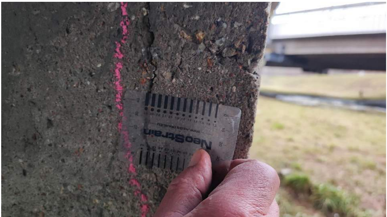
Fot. 34. Pomierzona rysa 2,4 mm.
