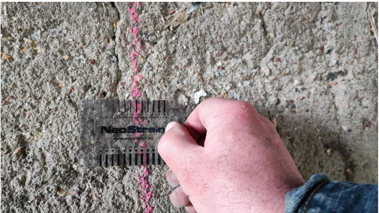
Fot. 36. Pomierzona rysa 0,4 mm.
