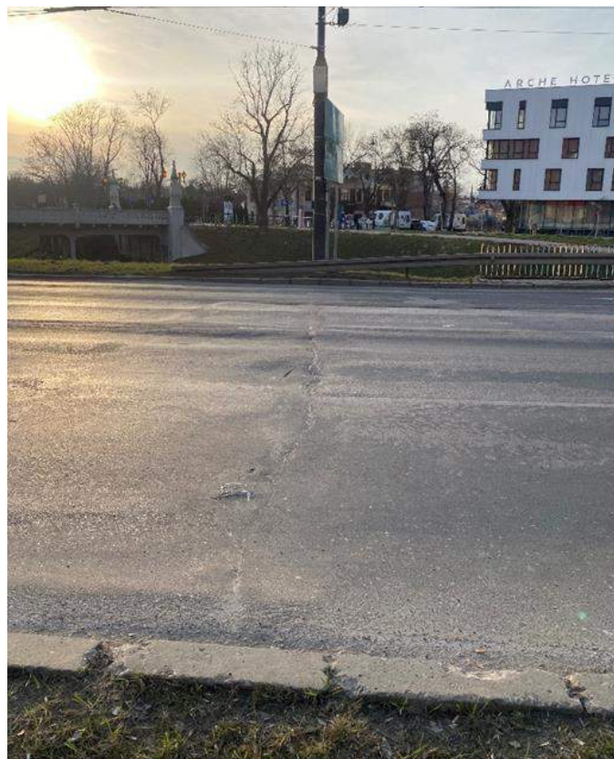
Fot. 80. Dylatacja nad podporą P4. Spękania w obrębie dylatacji. Niewielkie koleiny i deformacje nawierzchni.
