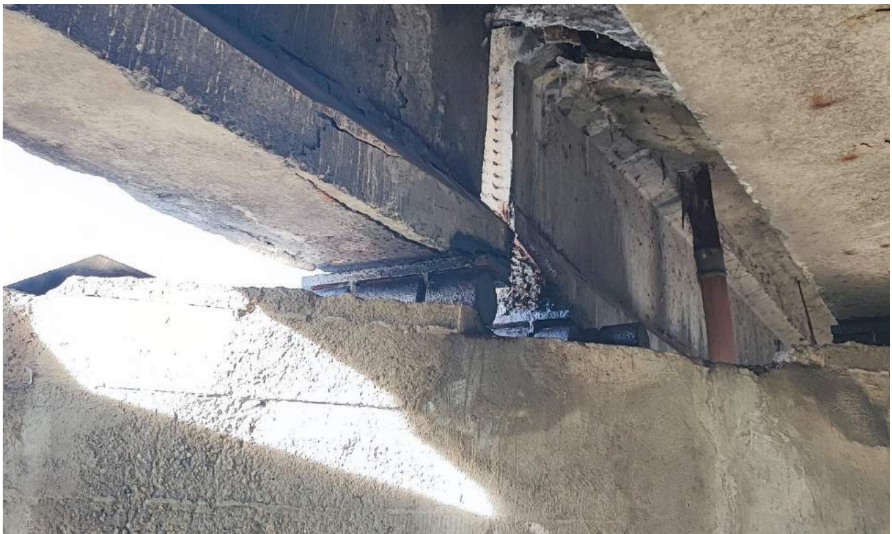
Fot. 40. Podpora P3. Uszkodzenie belki prawej od strony górnej wody
