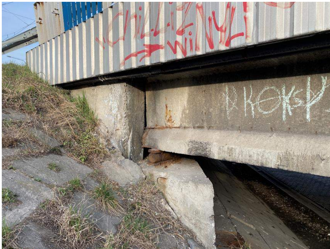
Fot. 11. Podpora P1 od strony GW. Zawilgocenia i wykwyty na ścianie zapleczej. Intensywna korozja łożyska wałkowego. Korozja zbrojenia w dźwigarze skrajnym.
