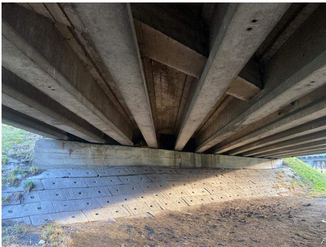
Fot. 73. Przęsło nr 3. Widoczne przebarwienia i wykwyty na powierzchni płyty, świadczące o przeciekach. Stan dźwigarów nie budzi większych zastrzeżeń.
