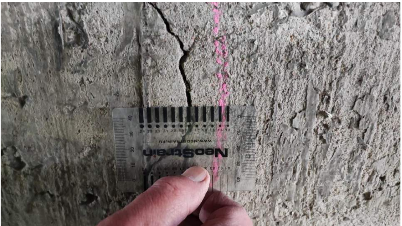
Fot. 24. Pomierzona rysa 1,8 mm.
