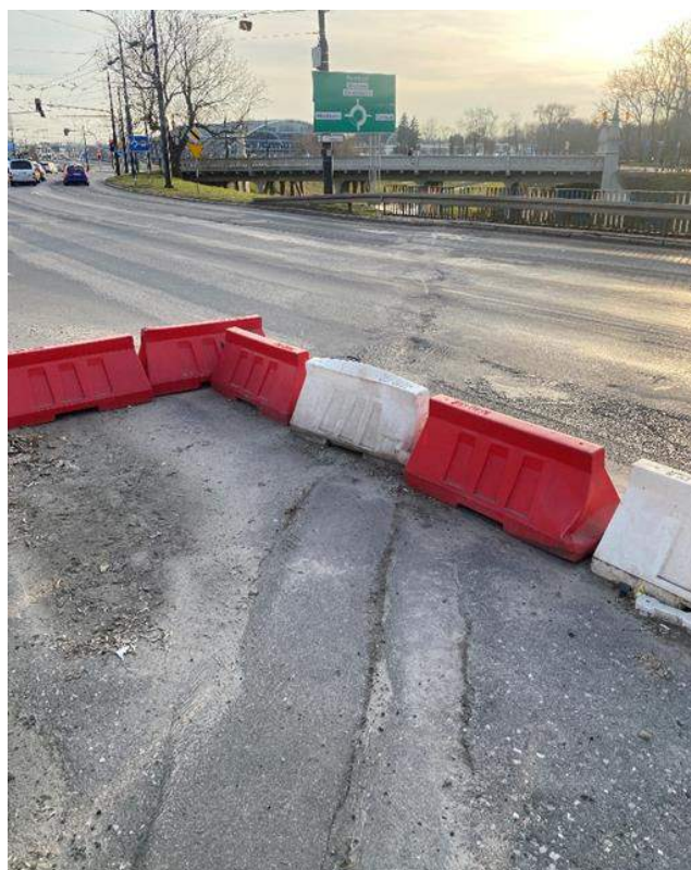
Fot. 78. Dylatacja nad podporą P3. Koleiny i lokalne deformacje o głębokości do ok. 5 cm oraz spękania siatkowe nawierzchni jezdni. Spękania wzdłuż dylatacji.
