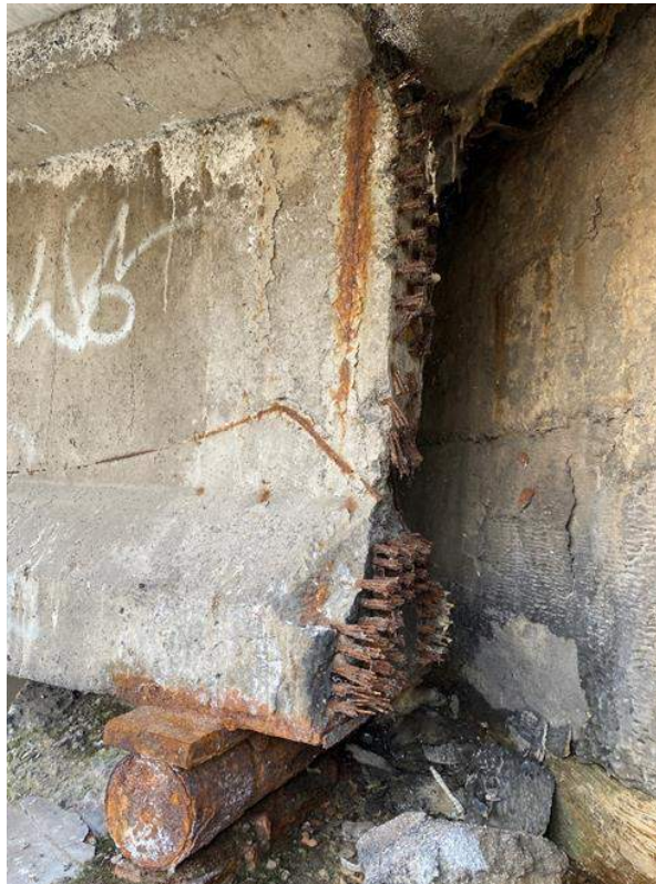
Fot. 67. Przęsło nr 1, belka skrajna od strony DW. Ubytki w otulinie zbrojenia, skorodowane i rozwarstwione zbrojenie sprężające. Ubytki w przekroju belki. Zacieki i wykwyty na belce. Intensywna korozja łożyska wałkowego.
