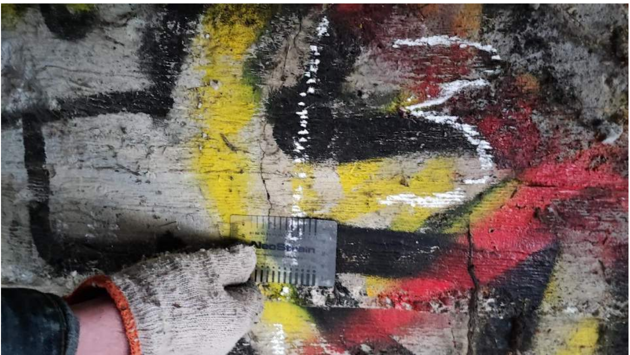
Fot. 6. Miejsce pomiarowe nr 3 na podporze P1. Pomierzona rysa 0,4 mm.
