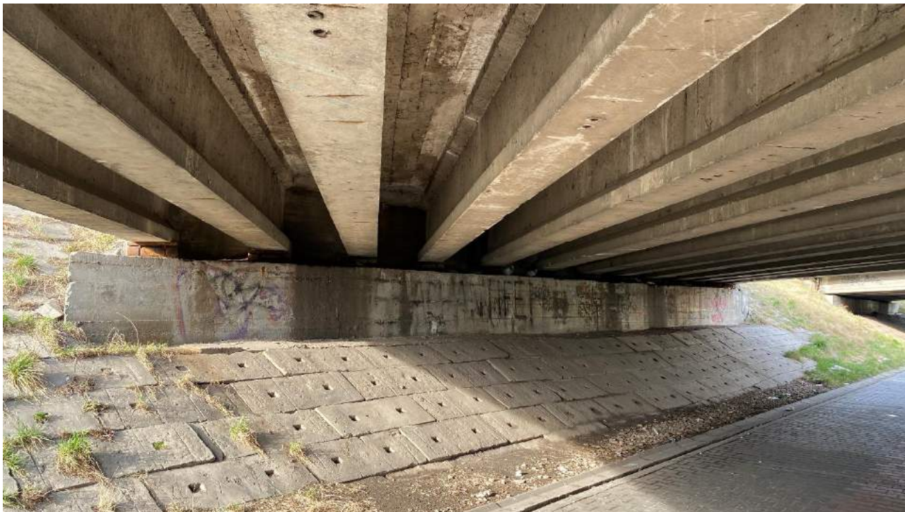
Fot. 1. Uszkodzenia podpory P1. Na ścianie czołowej widoczne rysy pionowe. Na ścianie zapleczej, ławie podłożyskowej i ścianie czołowej osady i przebarwienia betonu w wyniku przecieków przez dylatację. Lokalna korozja betonu i zbrojenia w ścianie czołowej
