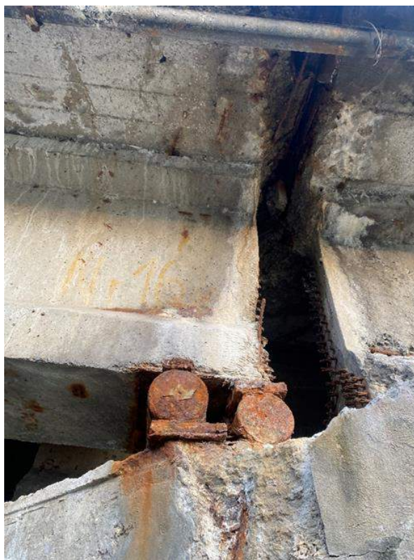
Fot. 71. Belka skrajna od strony GW, nad podporą P-3. Na belkach korozja betonu, przecieki i wykwit na płycie pomostu. Korozja zbrojenia pomostu oraz zbrojenia sprężającego belek. Niewłaściwie ułożone, skorodowane łożyska wałkowe.
