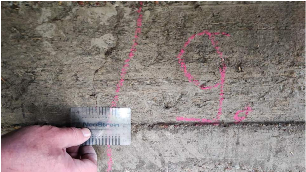
Fot. 57. Miejsce pomiarowe nr 9 na podporze P4. Pomierzona rysa 0,5 mm.
