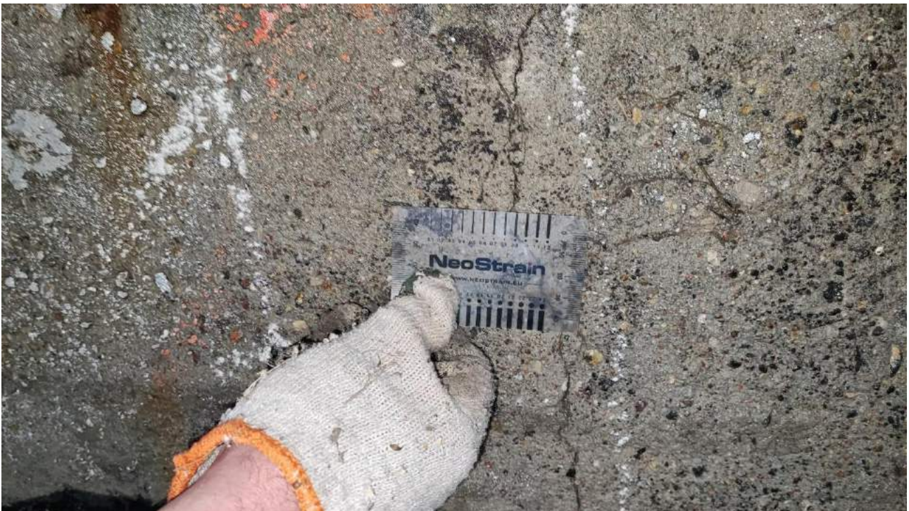
Fot. 4. Miejsce pomiarowe nr 1 na podporze P1. Pomierzona rysa 0,8 mm.
