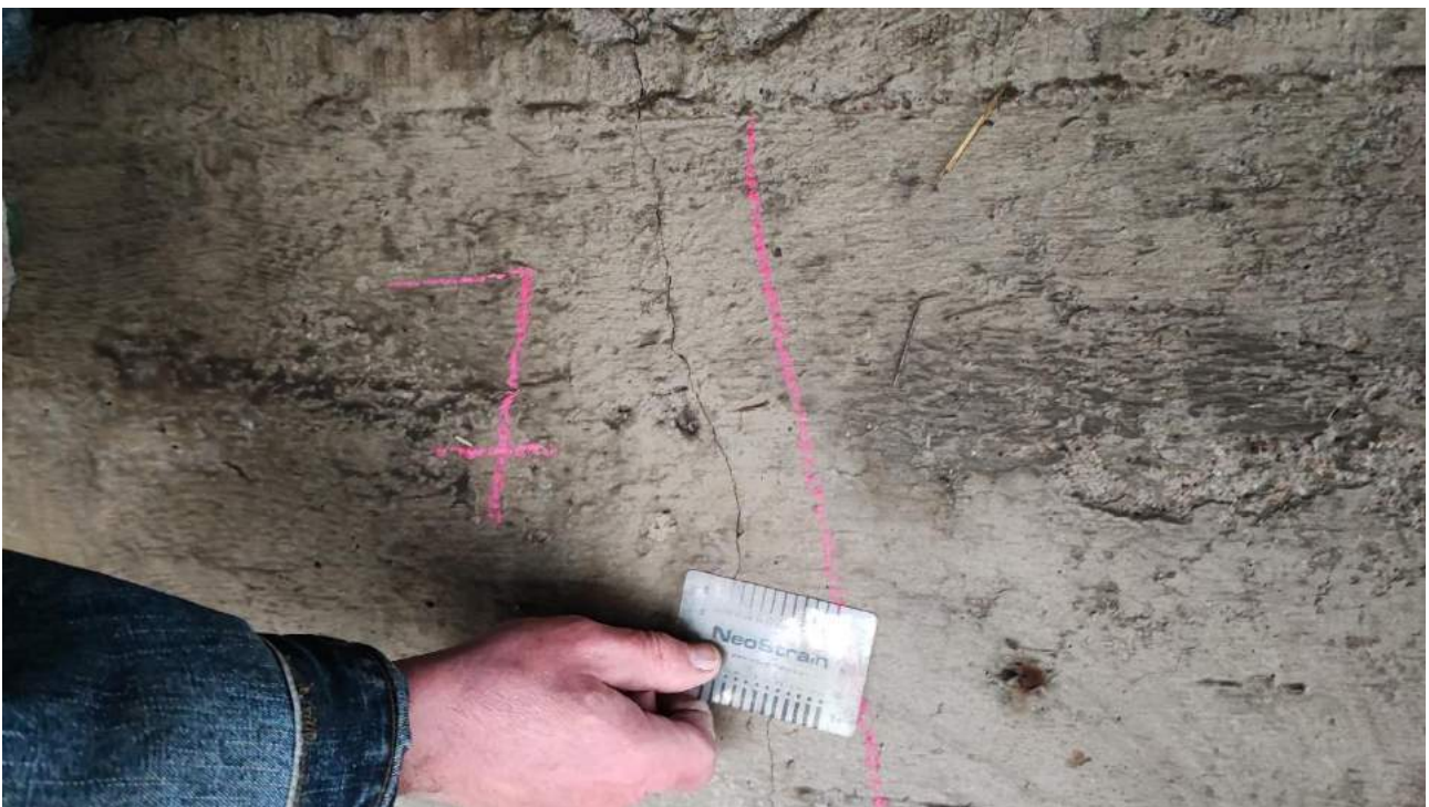
Fot. 54. Miejsce pomiarowe nr 7 na podporze P4. Pomierzona rysa 0,3 mm.
