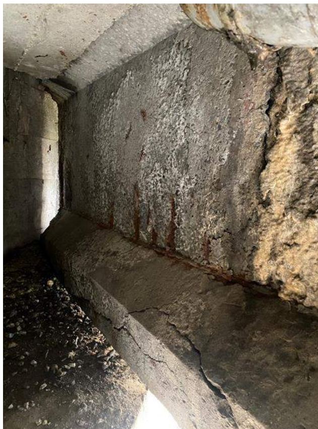
Fot. 74. Przęsło nr 3, belka skrajna od strony GW. Widoczne ubytki w otulinie zbrojenia belki oraz jej spękania. Skorodowane odsłonięte zbrojenie belki. Wykwity na belce spowodowane przeciekami.
