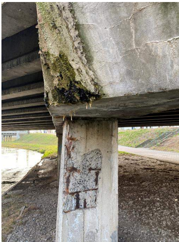
Fot. 16. Podpora P2 słup skrajny od strony DW - spękania i odpryski otuliny spowodowana intensywną korozją zbrojenia głównego i strzemion.
