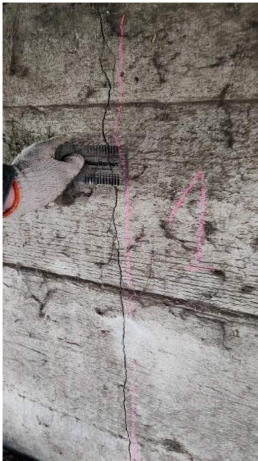
Fot. 44. Pomierzona rysa 0,9 mm.
