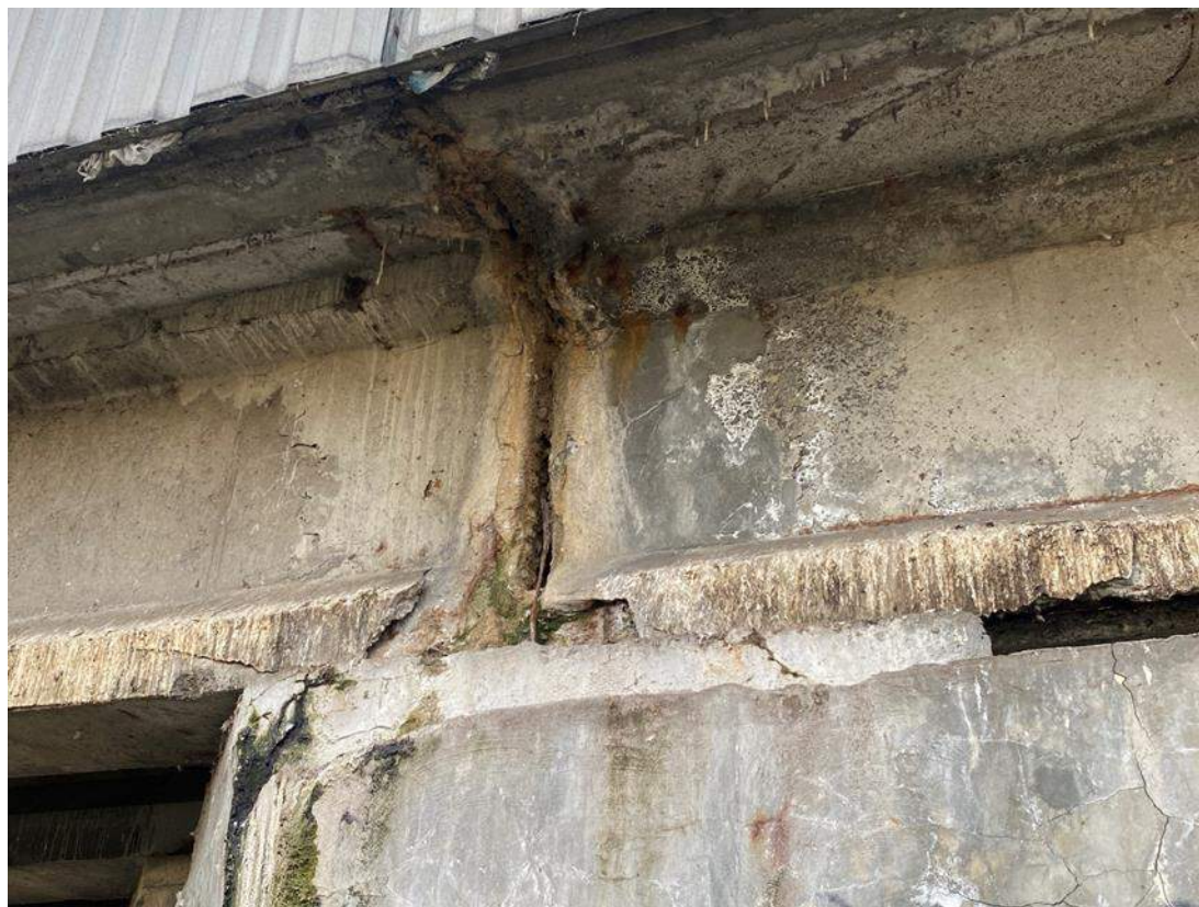
Fot. 14. Podpora P2. Belki skrajne od strony DW nad podporą P-2. Przecieki, wykwyty i korozja betonu w belkach i płycie pomostu, spowodowane przeciekami przez dylatację. Odspojenia i ubytki betonu w belkach. Korozja zbrojenia sprężającego dźwigarów.
