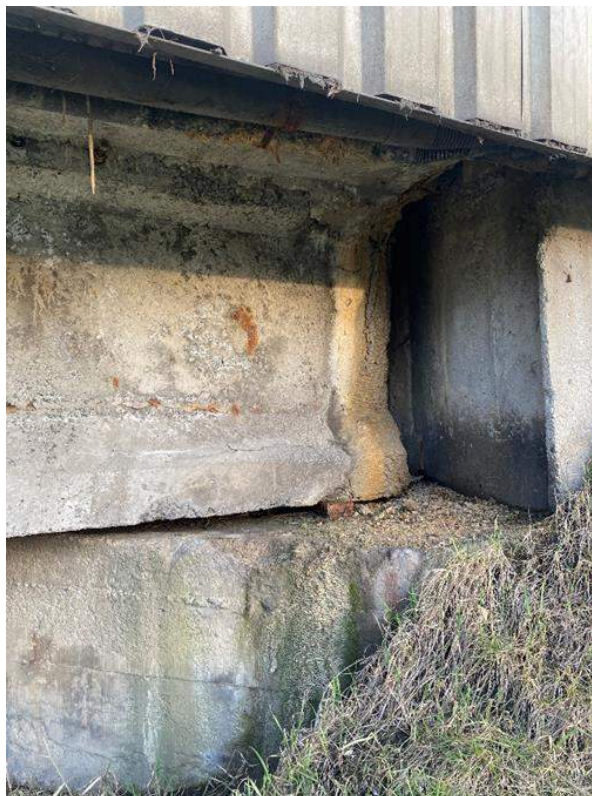
Fot. 59. Podpora P4, widok od strony GW. Zawilgocenia, zacieki i wykwity betonu ścianki czołowej i zapleczej, spowodowane przeciekami przez dylatacje. Korozja betonu i punktowa korozja stali zbrojeniowej w dźwigarach głównych.
