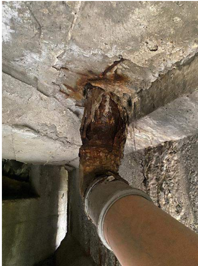
Fot. 75. Przęsło nr 3, belka skrajna od strony GW. Uszkodzone elementy odwodnienia, skorodowana dziurawa rura wpustowa. Odspojenia otuliny i korozja zbrojenia w miejscu wyprowadzenia rury.
