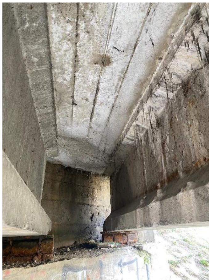
Fot. 62. Widok przęsła 1, w kierunku podpory P1. Na płycie i dźwigarach widoczne przecieki i wykwyty solne. Punktowa korozja zbrojenia w dźwigarach.
