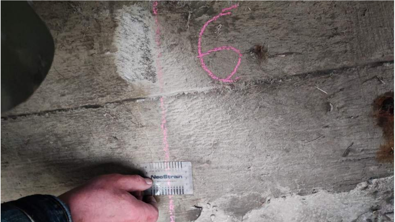
Fot. 53. Miejsce pomiarowe nr 6 na podporze P4. Pomierzona rysa 0,2 mm.
