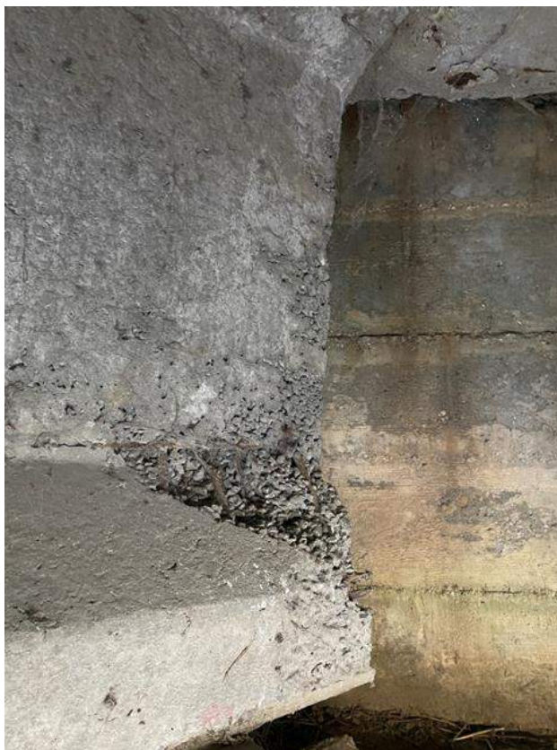
Fot. 66. Przęsło nr 1 belka w środku przęsła, ubytki betonu w belce, widoczne kruszywo betonu, odsłonięte skorodowane zbrojenie belki.
