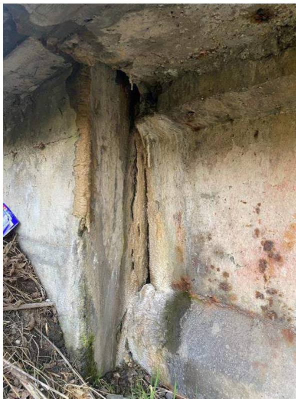
Fot. 60. Podpora P4, widok od strony DW. Zawilgocenia, zacieki i wykwity betonu ścianki czołowej i zapleczej, spowodowane przeciekami przez dylatacje. Korozja betonu i punktowa korozja stali zbrojeniowej w dźwigarach głównych.
