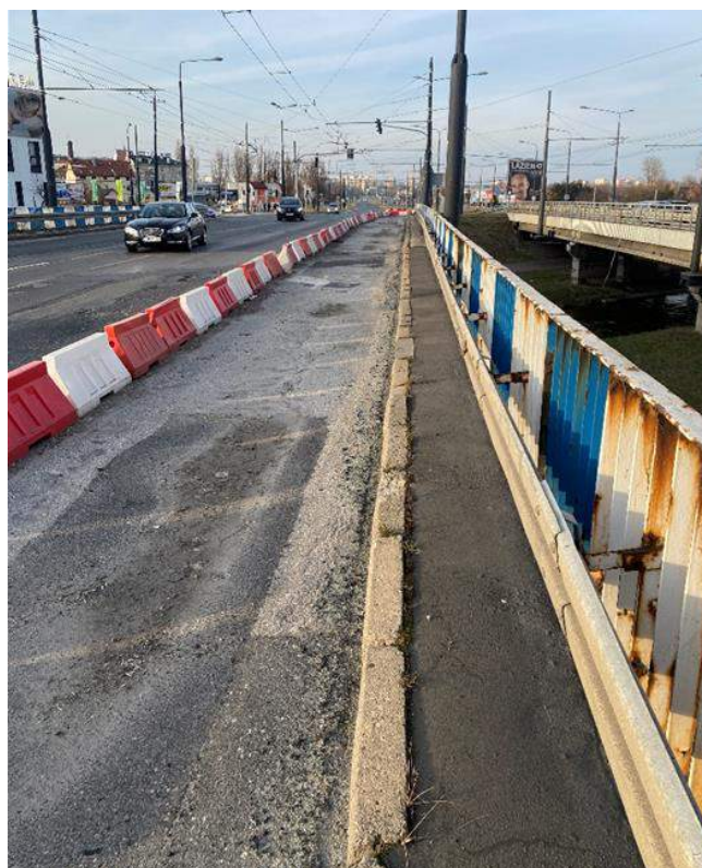
Fot. 82. Widok wzdłuż lewostronnej opaski. Przerwana ciągłość krawężnika. Korozja balustrady, występująca na całej długości.
