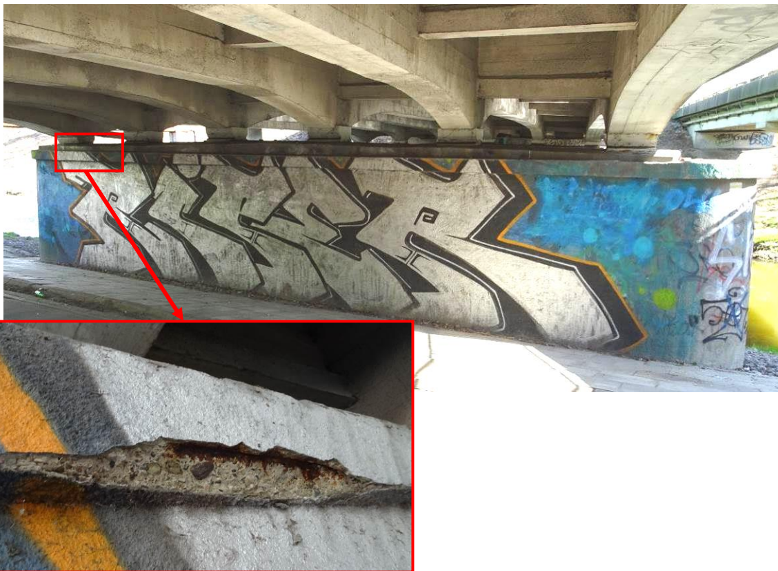
Fot. 25. Filar lewobrzeżny. Punktowy odprysk betonu w kapinosie ławy podłożyskowej spowodowany korozją zbrojenia. Poza tym brak uszkodzeń.
