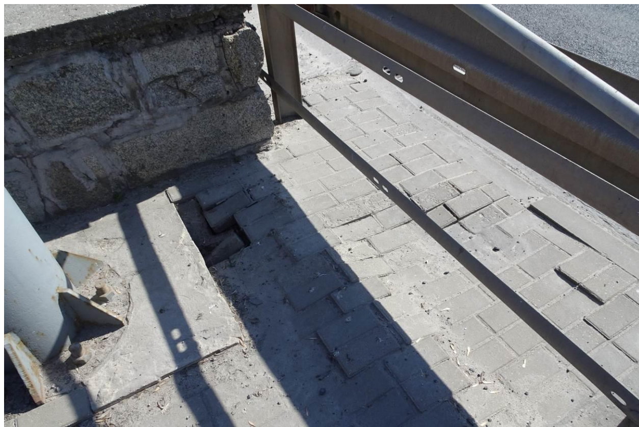
Fot. 32. Zdeformowana i zapadnięta nawierzchnia chodnika od str. DW na dojeździe od str. zachodniej.
