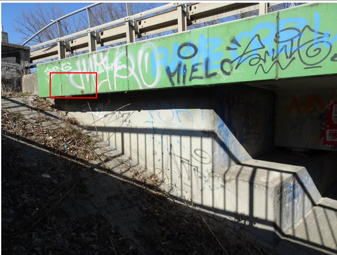
Fot. 20. Przyczółek lewobrzeżny, widok od str. GW. Korpus i skrzydło bez uszkodzeń. Korozja zbrojenia w belce gzymsowej. Śmieci i pozostałości wegetacji roślinnej na umocnieniu skarpy.
