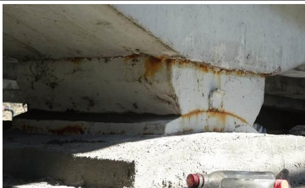
Fot. 27. Typowy stan łożysk stałych na filarze lewobrzeżnym. Lokalna korozja powierzchniowa elementów łożysk.
