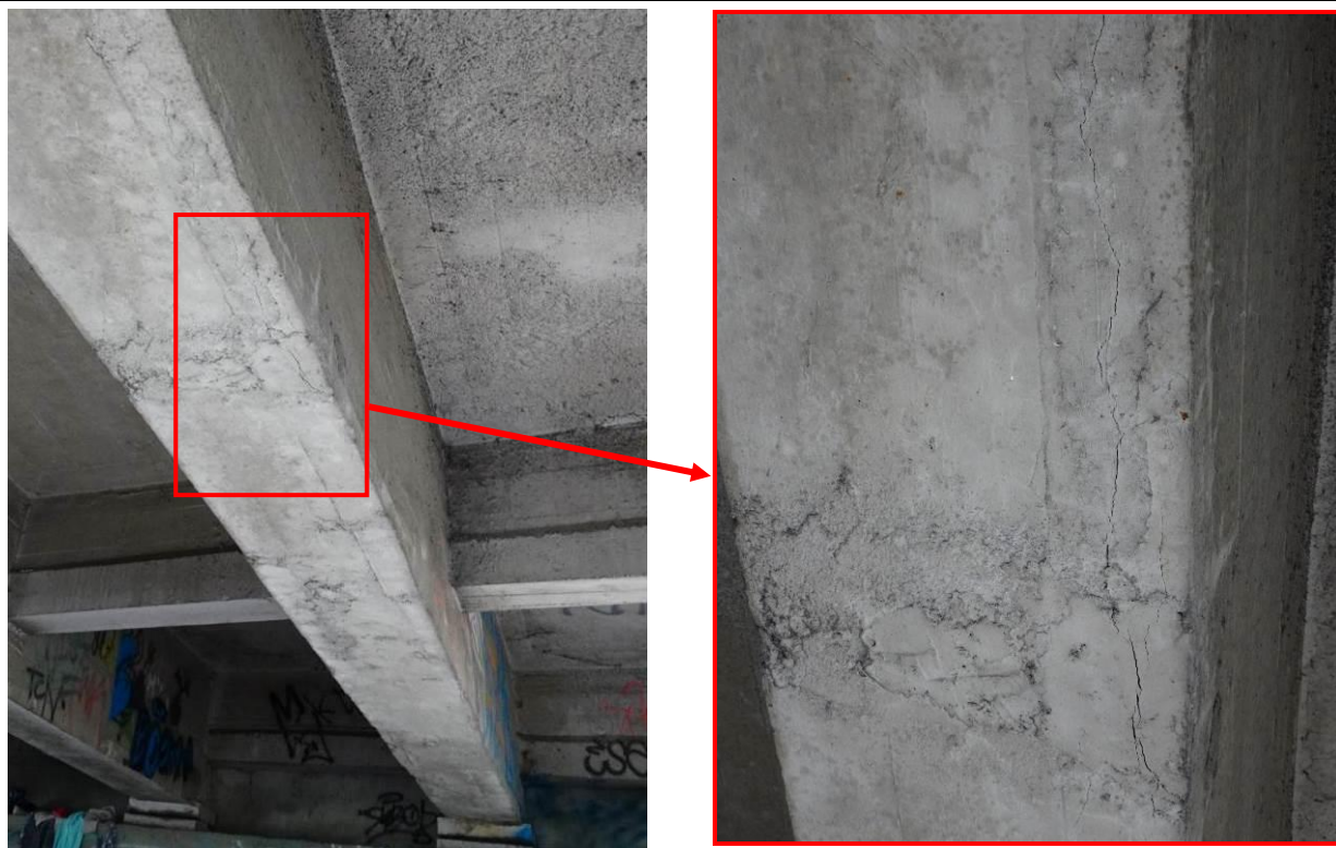
Fot. 18. Przęsło skrajne prawobrzeżne, dźwigar przedskrajny od str. GW. Rysa podłużna o rozwartości do 0,5 mm i długości ok. 1,5 mb, spowodowana korozją zbrojenia.
