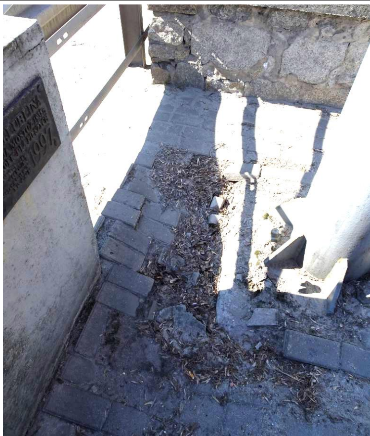
Fot. 33. Zdeformowana i zapadnięta nawierzchnia chodnika od str. DW na dojeździe od str. wschodniej.
