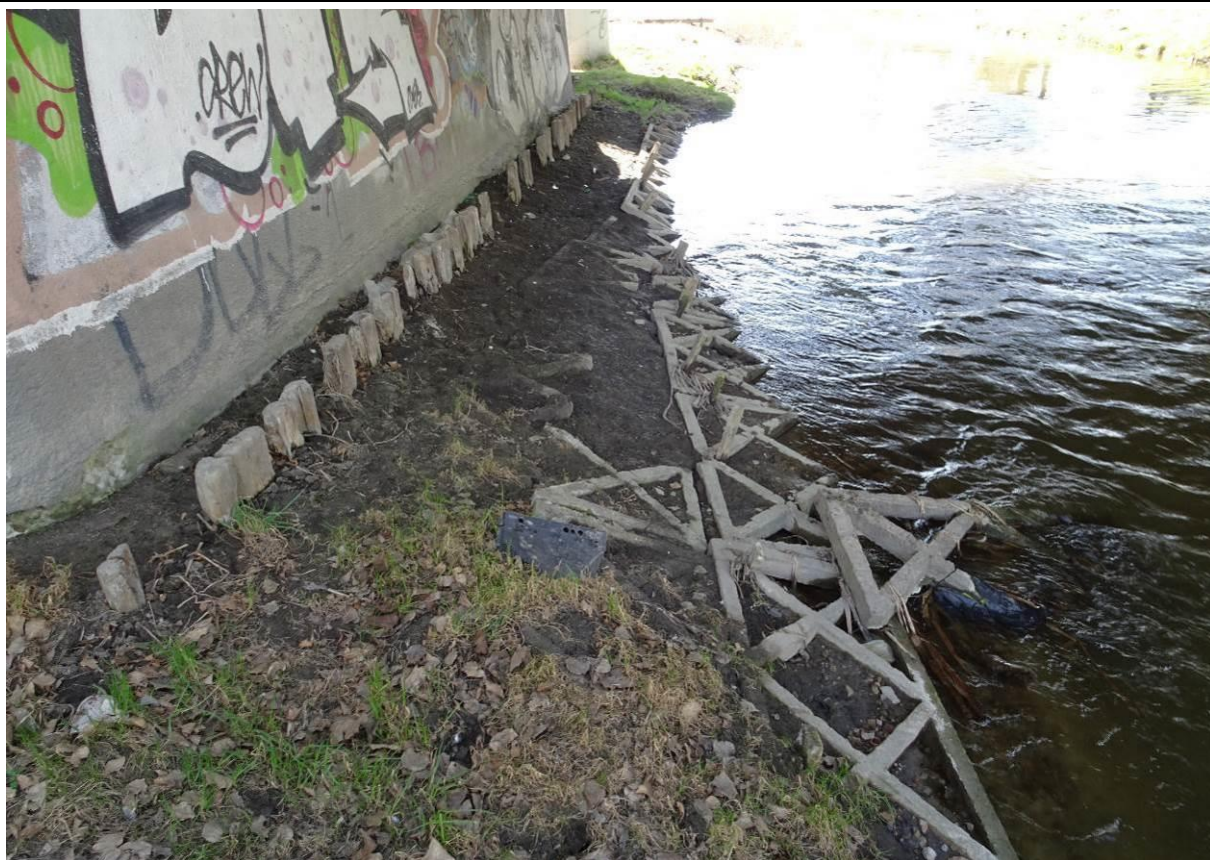
Fot. 31. Koryto rzeki pod mostem. Deformacjami umocnienia betonowego na prawym brzegu oraz pozostałości drewnianej ścianki szczelnej wokół fundamentu filara.
