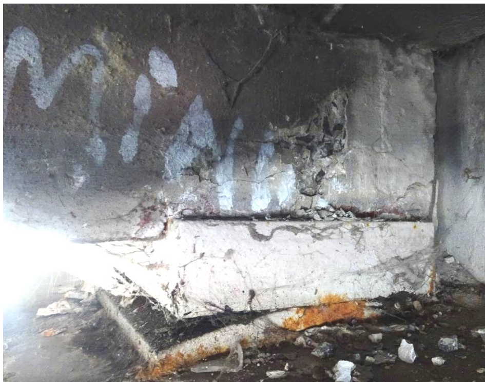
Fot. 14. Dźwigar środkowy nad przyczółkiem lewobrzeżnym. Odpryski otuliny spowodowane korozją zbrojenia. Korozja powierzchniowa łożyska.
