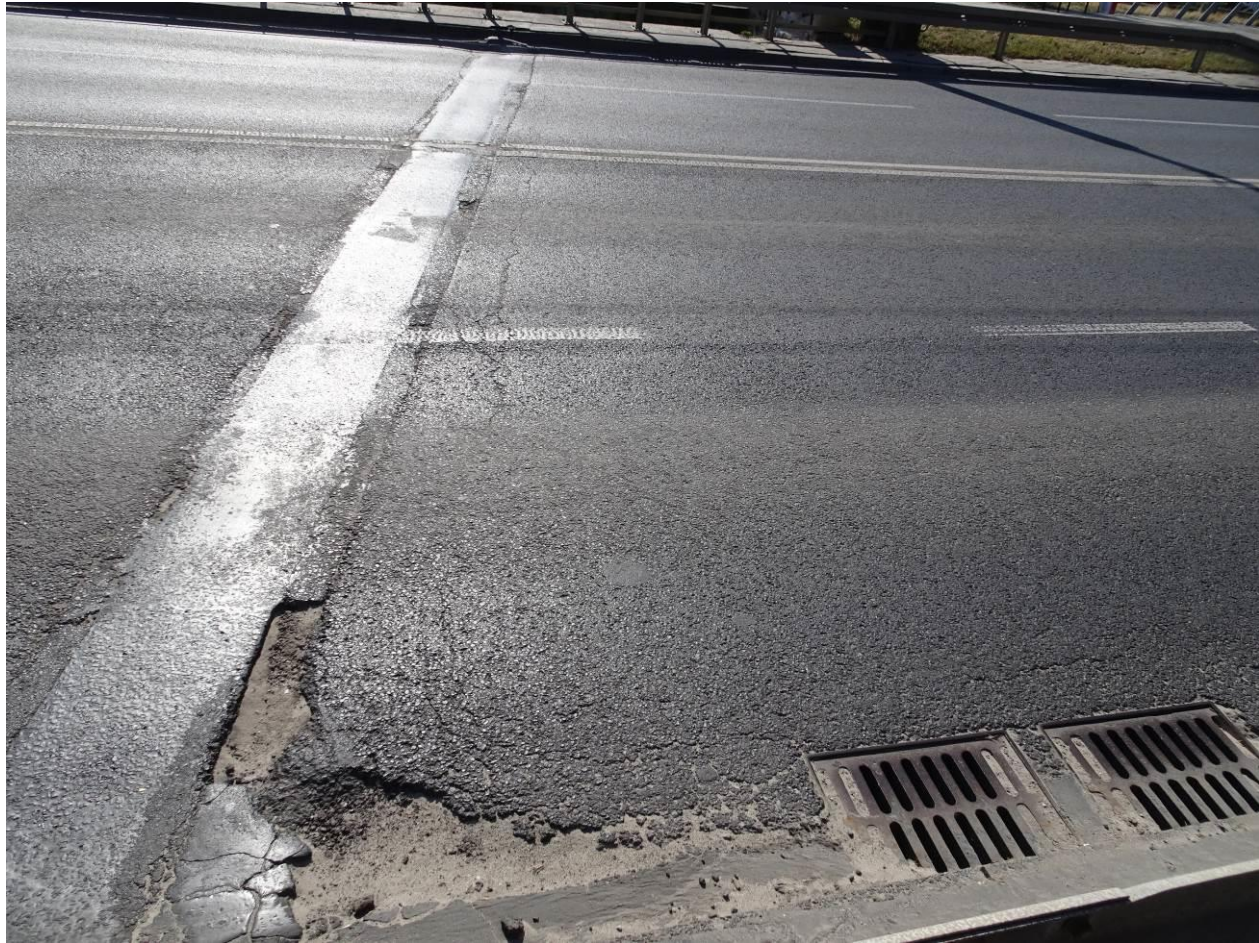
Fot. 11. Dylatacja bitumiczna jezdni nad przycółkiem lewobrzeżnym. Liczne spękania dylatacji oraz spękania i ubytki nawierzchni jezdni.
