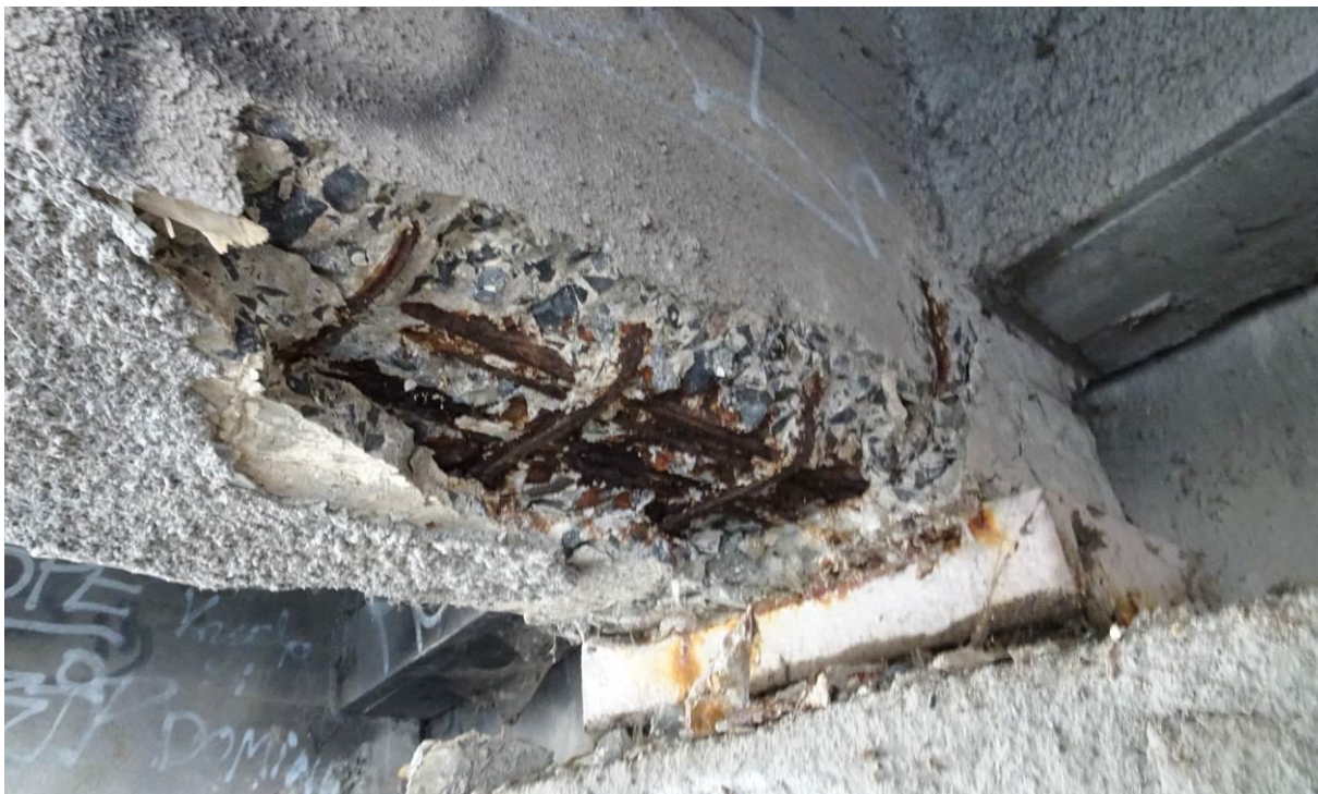
Fot. 15. Dźwigar przedskrajny od DW nad przyczółkiem lewobrzeżnym. Odpryski otuliny spowodowane intensywną korozją zbrojenia głównego i strzemion.
