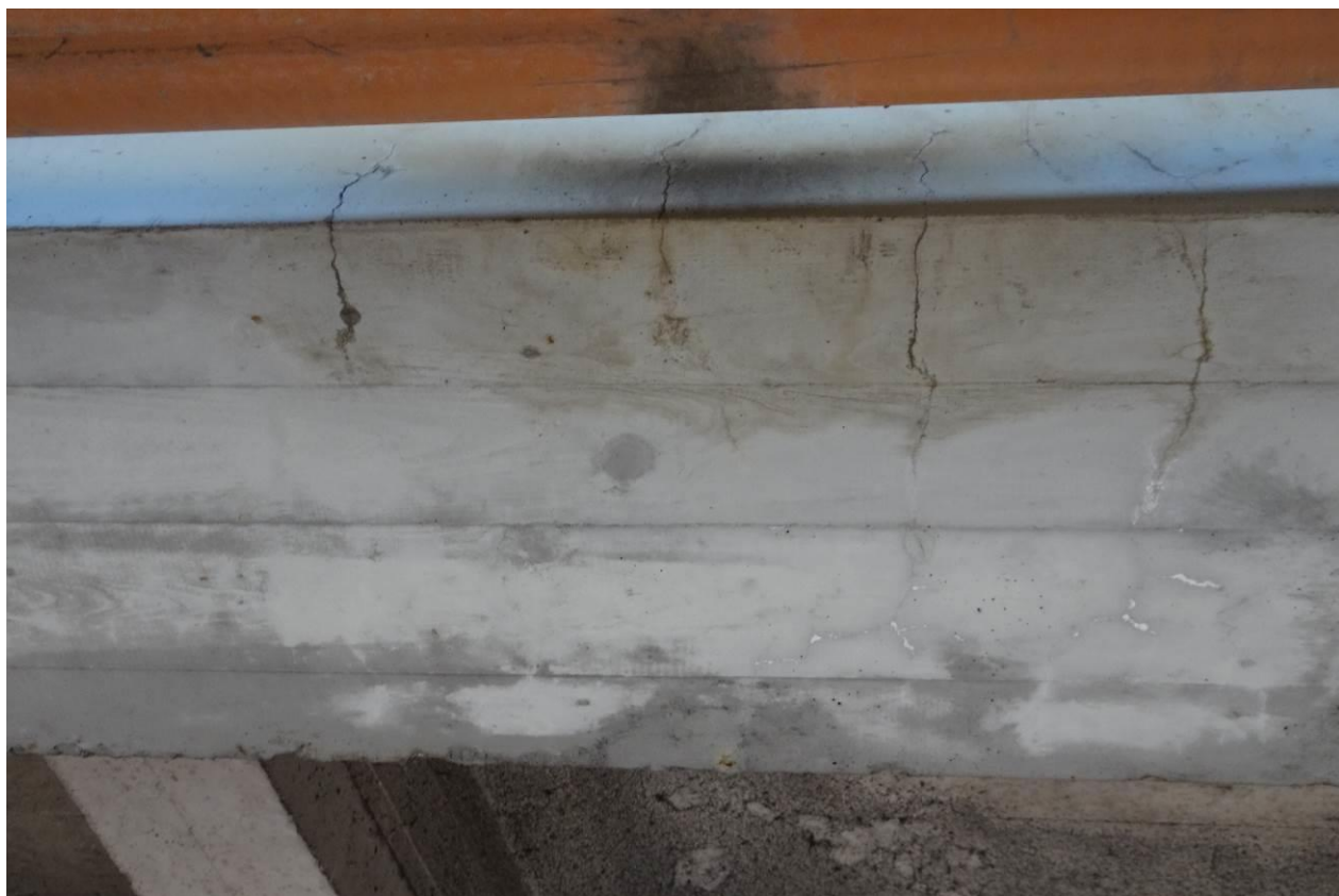
Fot. 17. Przęsło skrajne prawobrzeżne. Rysy poprzeczne o rozwartości do 0,2 mm na dolnej powierzchni belki skrajnej od str. DW, w środku rozpiętości przęsła. Podobne rysy widoczne są również w belce skrajnej od str. GW.
