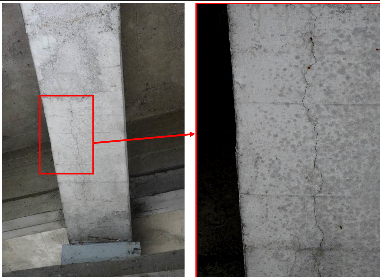
Fot. 16. Przęsło środkowe, dźwigar przedskrajny od str. GW przy filarze lewobrzeżnym. Rysa podłużna o rozwarości do 0,5 mm i długości ok. 3 mb, spowodowana korozją zbrojenia.
