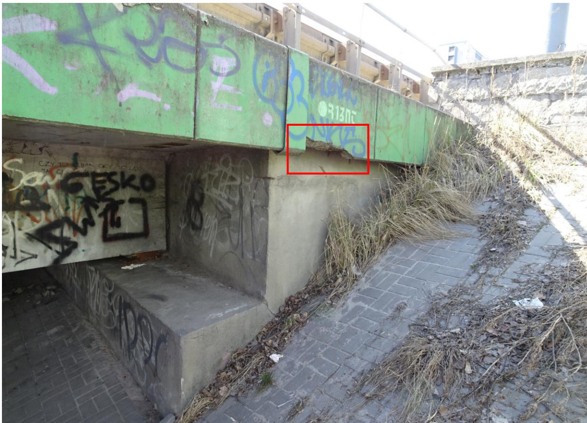
Fot. 21. Przyczółek lewobrzeżny, widok od str. DW. Korpus i skrzydło bez uszkodzeń. Odprysk betonu w belce gzymsowej spowodowany korozją zbrojenia. Śmieci i pozostałości wegetacji roślinnej na umocnieniu skarpy.
