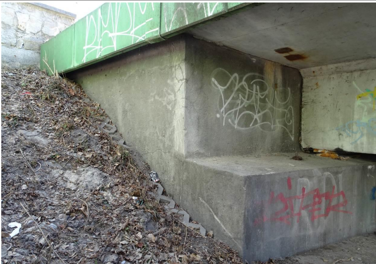
Fot. 22. Przyczółek prawobrzeżny, widok od str. DW. Korpus i skrzydło bez uszkodzeń. Deformacje betonowego umocnienia skarpy.
