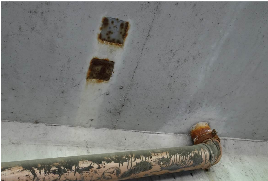
Fot. 19. Korozja blach na wsporniku podchodnikowym płyty pomostu w miejscu otworów technologicznych do mocowania deskowania. Uszkodzenie typowe, występuje we wszystkich blachach na obydwu wspornikach płyty. Widoczna również skorodowana obejma mocująca kolektor odwodnienia do wpustu.
