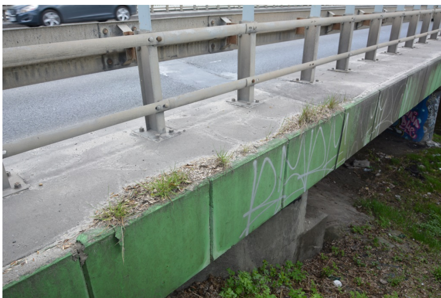
Fot. 6. Zanieczyszczenie, zacieki, zniszczenia powłok antykorozyjnych i ubytki betonu w gzymsach. Wegetacja roślinności, zarysowania i deformacje nawierzchni kap.
