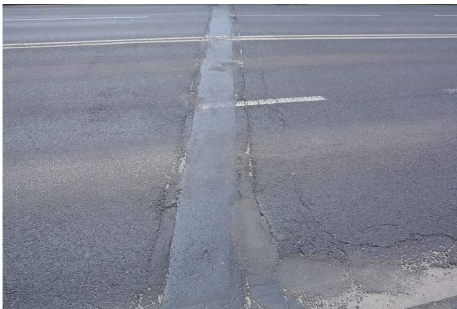
Fot. 5. Deformacje, zarysowania i spękania siatkowe na dylatacjach bitumicznych oraz na dojazdach.
