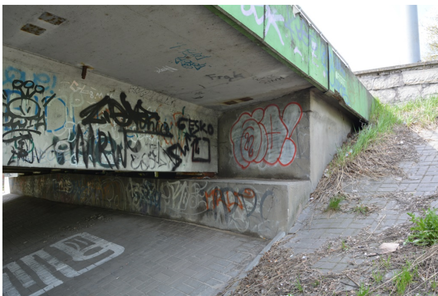
Fot. 8. Przyczółek od strony ul. Lipowej od strony DW. Korpus i skrzydło bez uszkodzeń, zanieczyszczenia graffiti na całej powierzchni. Odprysk betonu w belce gzymsowej spowodowany korozją zbrojenia. Śmieci i pozostałości wegetacji roślinnej na umocnieniu skarpy. Stan obu przyczółków podobny.
