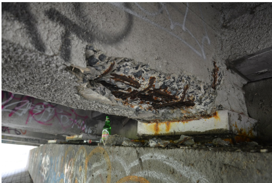
Fot. 7. Dźwigar przyskrajny od DW od strony ul. Lipowej. Odpryski otuliny spowodowane intensywną korozją zbrojenia głównego i strzemion. Korozja i ograniczenie przesuwu łożysk.
