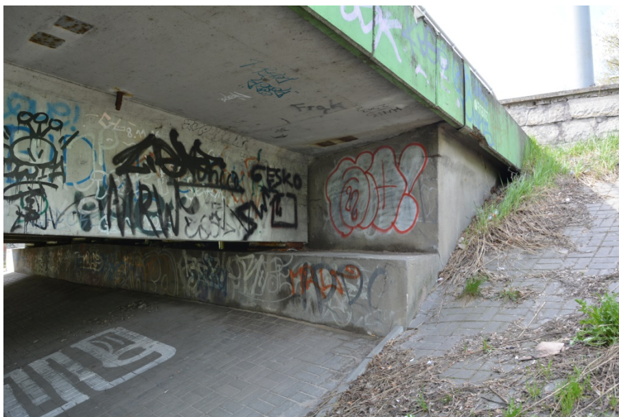
Fot. 8. Przyczółek od strony ul. Lipowej od strony DW. Korpus i skrzydło bez uszkodzeń, zanieczyszczenia graffiti na całej powierzchni. Odprysk betonu w belce gzymsowej spowodowany korozją zbrojenia. Śmieci i pozostałości wegetacji roślinnej na umocnieniu skarpy. Stan obu przyczółków podobny.
