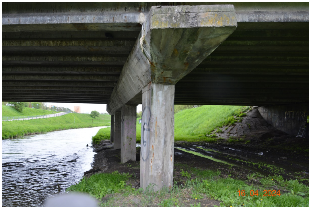
Fot. 35. Typowy stan podpór pośrednich 2 i 3. Uszkodzenia oczełu filara: przecieki wody, wegetacja roślin, korozja zbrojenia w następstwie nieszczelności dylatacji. Zarysowania słupów spowodowane korozją zbrojenia wywołaną zawilgoceniem od przeciekającej z pomostu wody, zanieczyszczenia graffiti.
