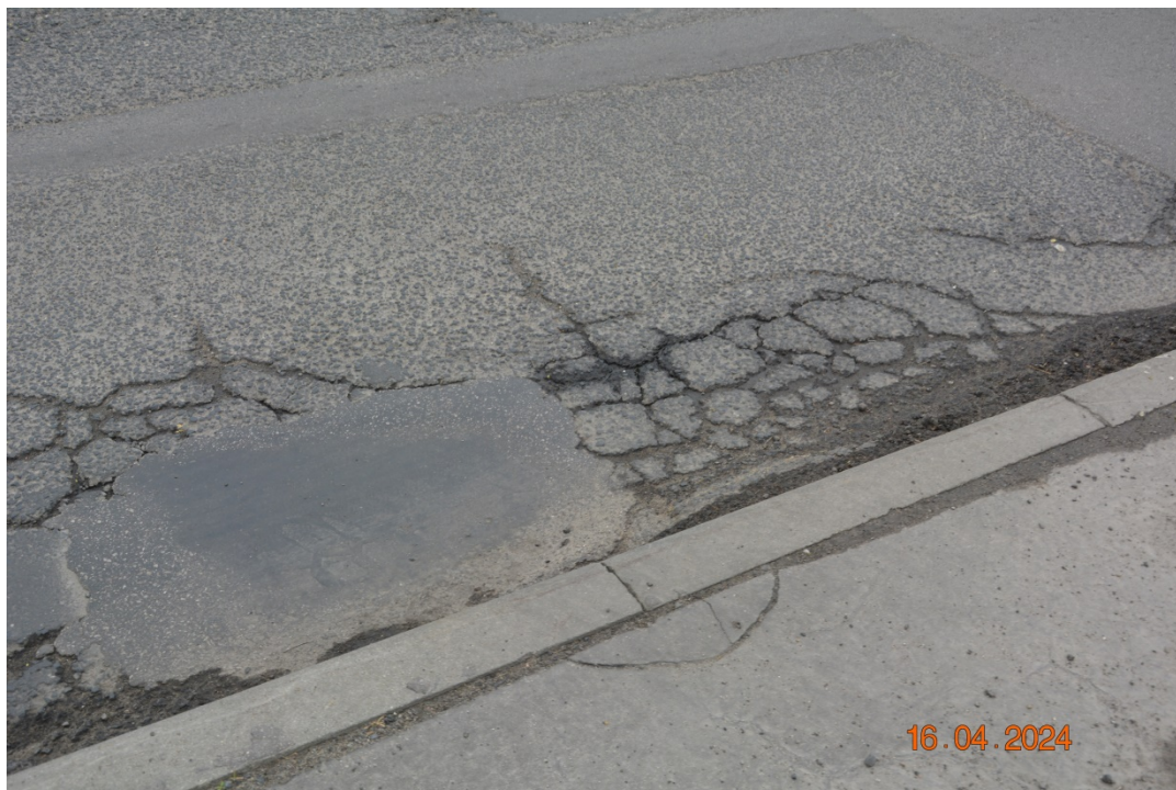
Fot. 21. Lokalne deformacje, zarysowania i wykruszenia nawierzchni jezdni w przęśle 1
