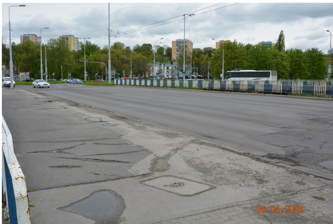
Fot. 22. Deformacje, zarysowania, przemieszczenia i wykruszenia nawierzchni chodnika w na pomoście i dojazdach
