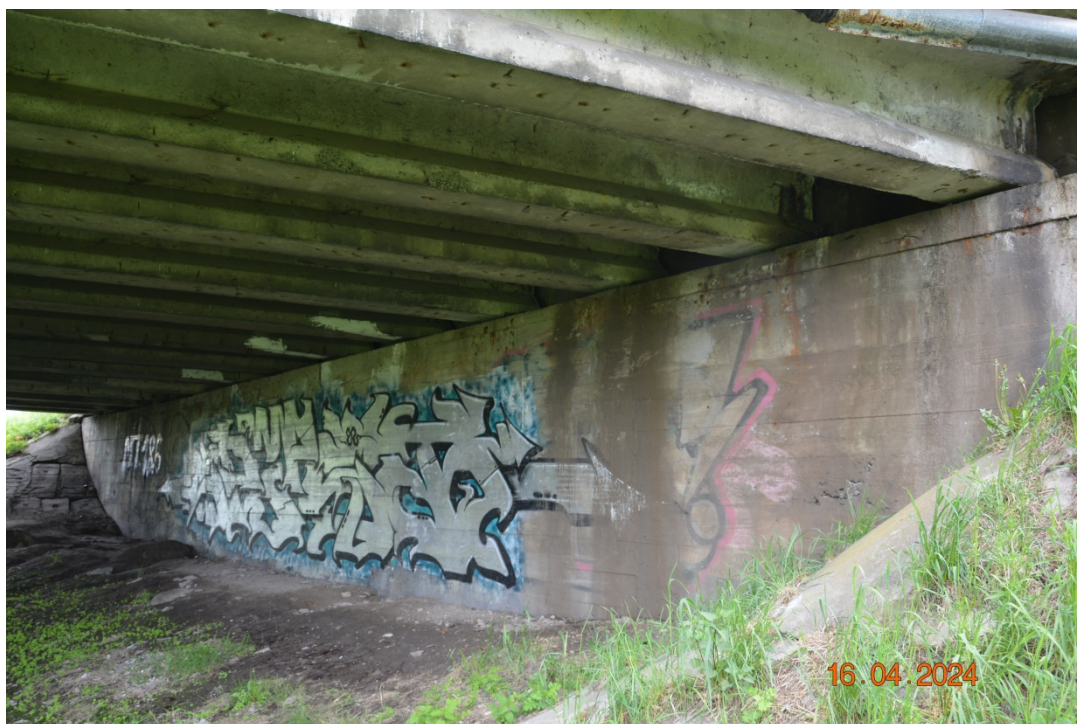
Fot. 38. Typowe uszkodzenia przyczółków, m.in.: przecieki wody i osady (świadczące o nieszczelności stref dylatacyjnych), pęknięcia, zanieczyszczenia graffiti.
