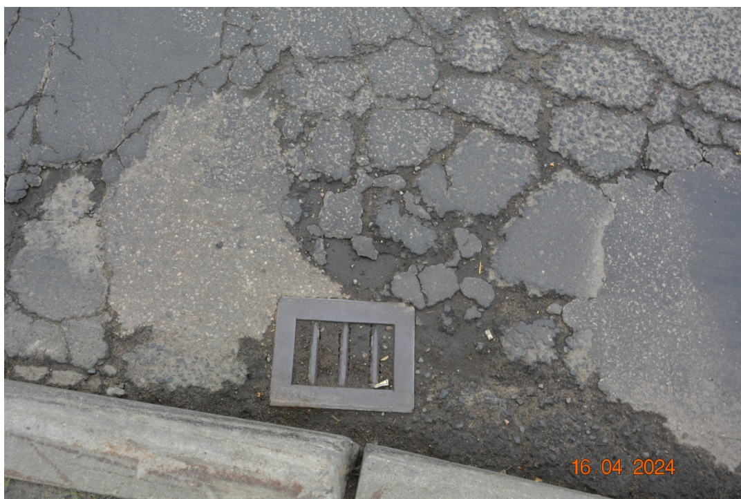
Fot. 26. Zanieczyszczenie wpustów z całkowitą utratą drożności wpustu w przejściu 1.
