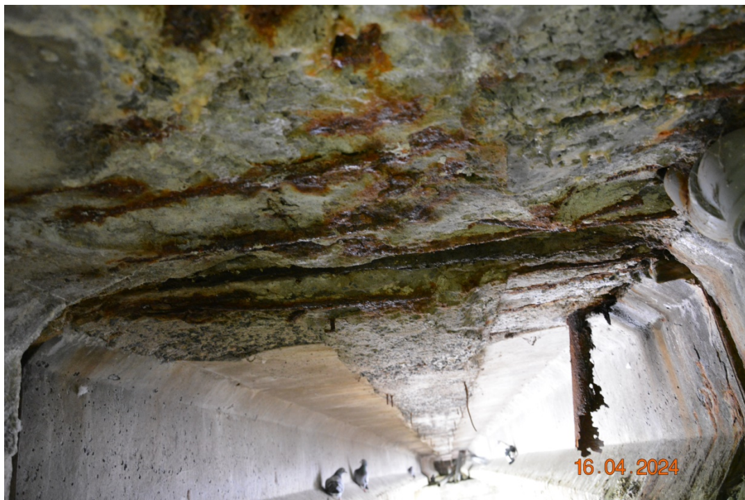
Fot. 33. Widoczne przecieki przez pomost w strefie dylatacyjnej. Typowy stan pomostu nad podporami pośrednimi: przecieki, zacieki, wykwyty, korozja zbrojenia miękkiego, odpryski otuliny. Widoczna korozja sączka..
