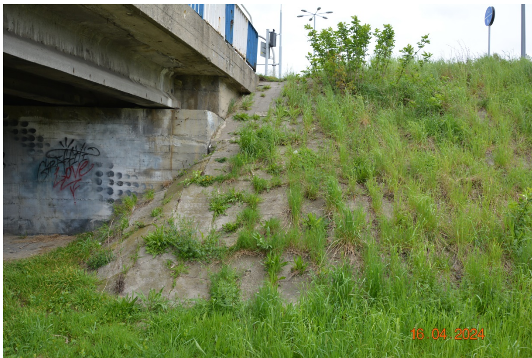
Fot. 19. Zarysowania, deformacje i ubytki betonu umocnienia skarp przy przyczółkach. Wegetacja roślinności na umocnieniach skarp przy przyczółkach.
