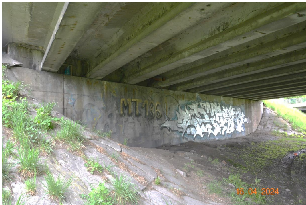
Fot. 29. Widoczne przecieki przez zamki pomostu świadczące o nieszczelności izolacji. Typowy stan pomostu: przecieki, wykwyty, korozja zbrojenia zamków, odpryski otuliny. Blokada przęseł na podporach skrajnymi.
