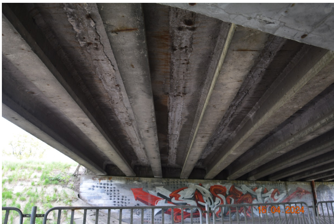
Fot. 30. Widoczne przecieki przez zamki pomostu świadczące o nieszczelności izolacji. Typowy stan pomostu: przecieki, wykwyty, korozja zbrojenia zamków, odpryski otuliny. Blokada przęseł na podporach skrajnymi.
