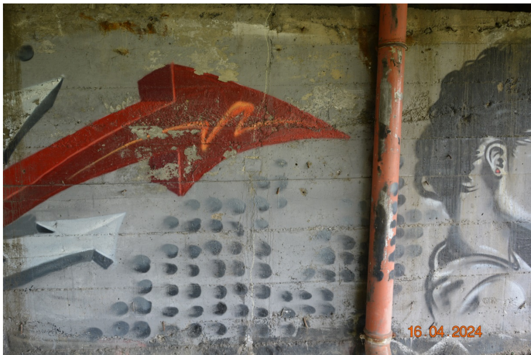
Fot. 37. Typowy stan przyczółków, m.in.: przecieki wody i osady (świadczące o nieszczelności stref dylatacyjnych), pęknięcia, korozja zbrojenia, zanieczyszczenia graffiti.
