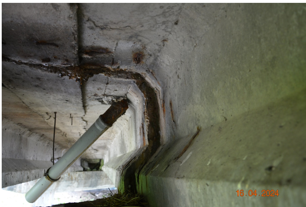
Fot. 28. Korozja rur spustowych wpustów.
