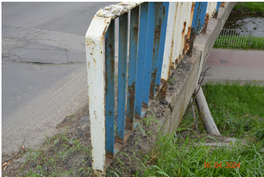
Fot. 23. Lokalne deformacje, korozja i zniszczenie powłok antykorozyjnych balustrad. Zanieczyszczenia, korozja betonu, lokalne ubytki betonu belek podporęczowych.
