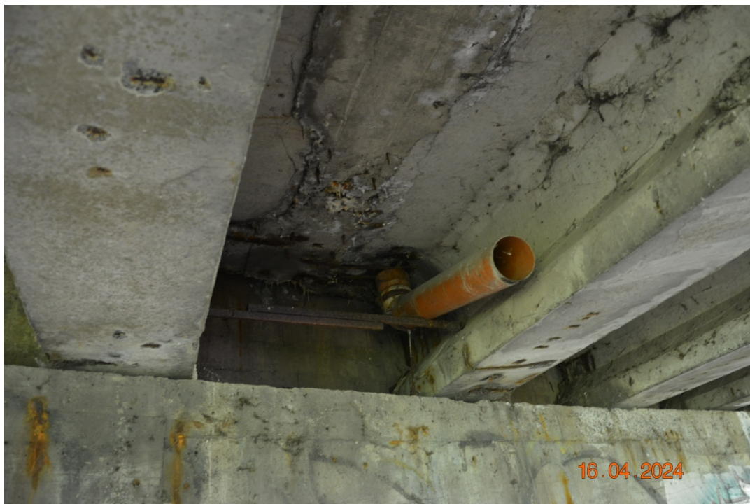
Fot. 31. Widoczne przecieki przez zamki pomostu świadczące o nieszczelności izolacji. Typowy stan dźwigarów: zacieki, wykwity, korozja zbrojenia miękkiego, odpryski otuliny. Blokada przepel na podporami skrajnymi.
