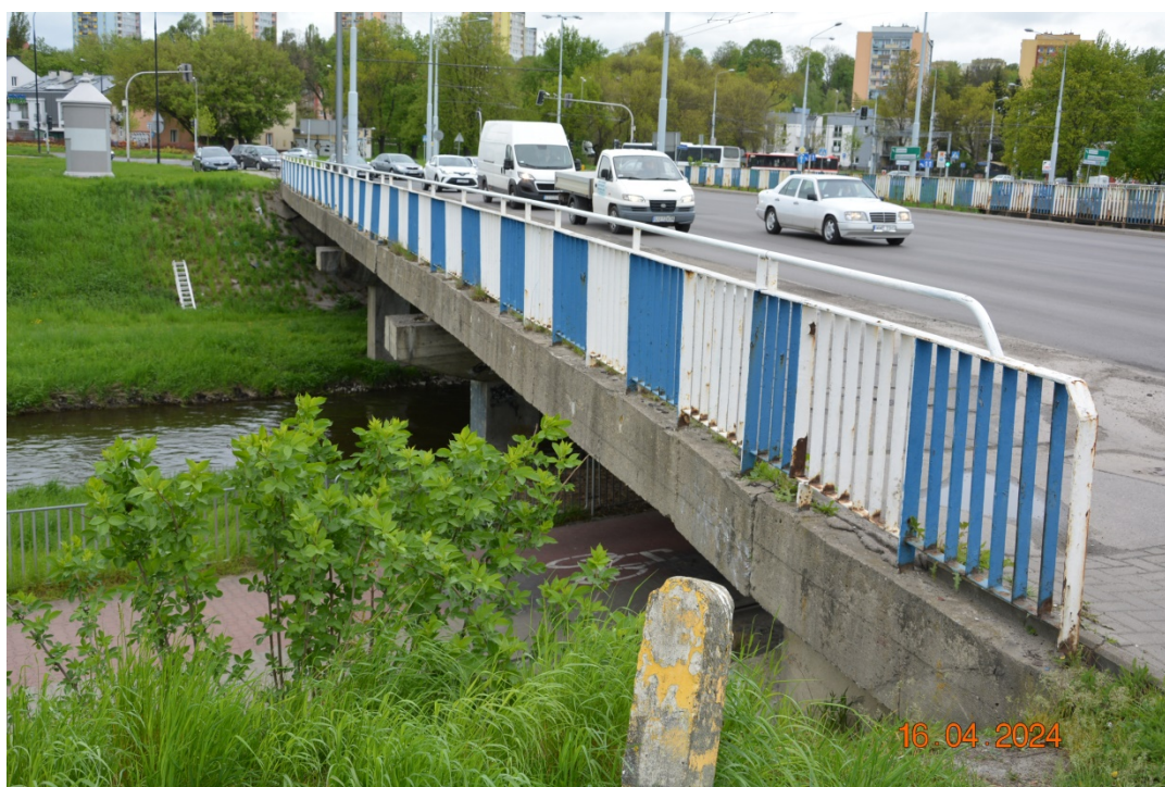
Fot. 24. Zanieczyszczenia, wegetacja roślinności, korozja betonu, lokalne zarysowania przecieki i ubytki betonu belek podporęczowych.
