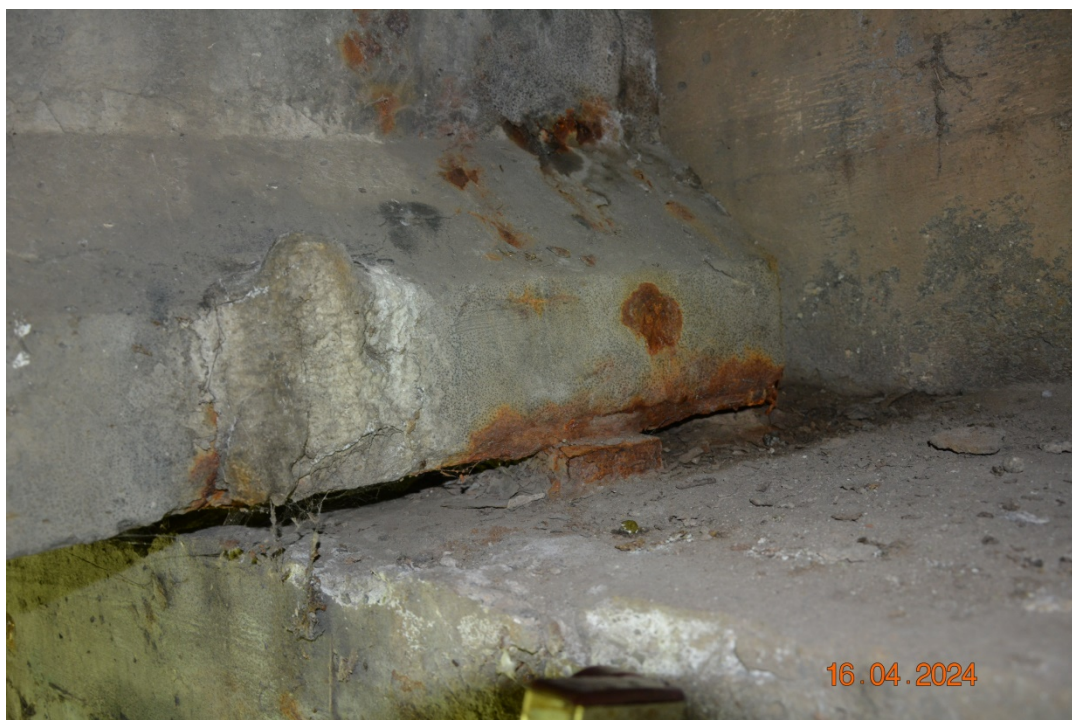
Fot. 34. Typowy stan łożysk. Korozja łożysk i blokada przesuwu na skorodowanych łożyskach.
