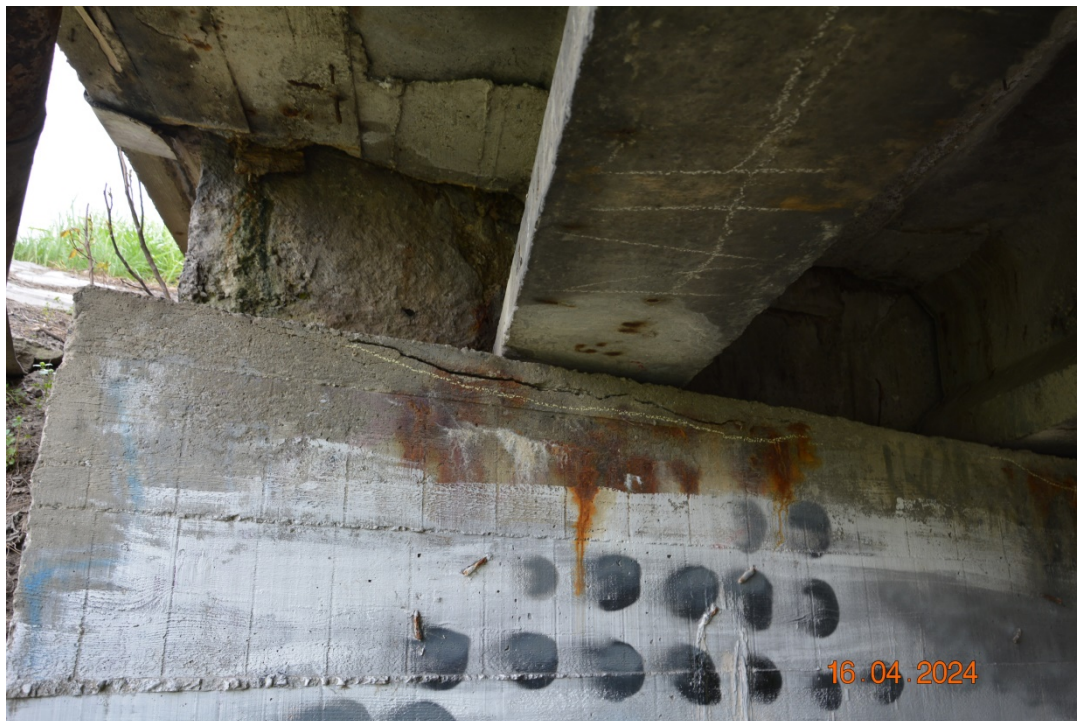
Fot. 36. Typowe uszkodzenia przyczółków, m.in.: przecieki wody i osady (świadczące o nieszczelności stref dylatacyjnych), pęknięcia, korozja zbrojenia, zanieczyszczenia graffiti.
