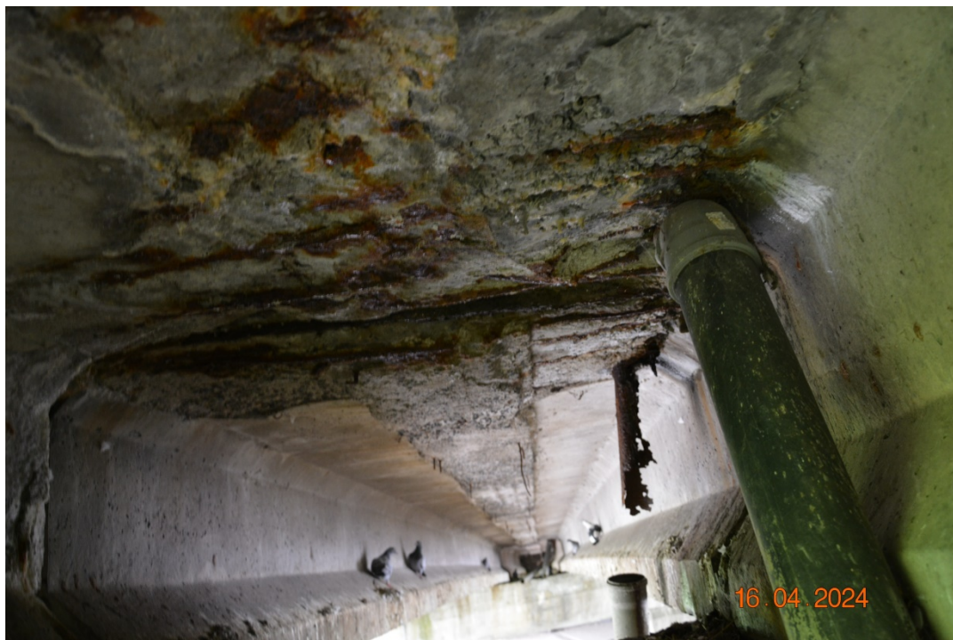
Fot. 27. Lokalna całkowita korozja sączka i nieprawidłowe odprowadzenie wody z sączka
