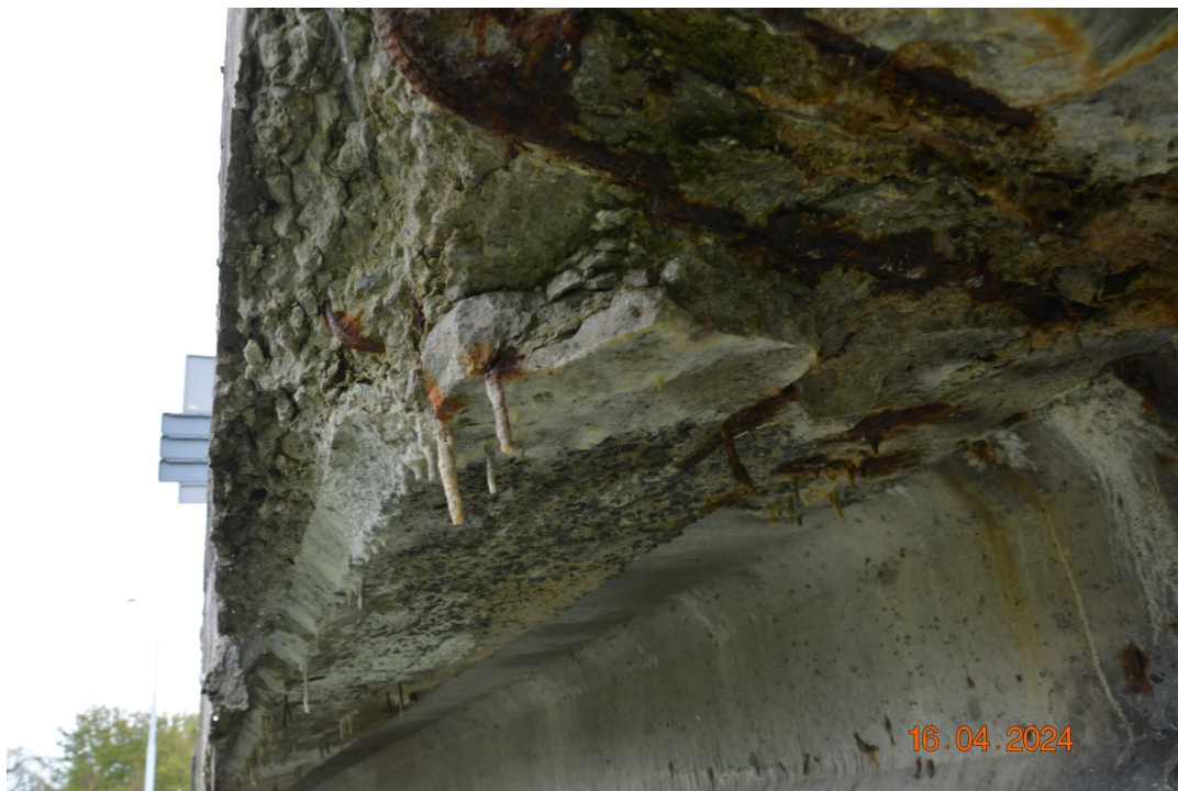
Fot. 25. Lokalnie korozja betonu, zarysowania, przecieki i ubytki betonu belek podporęczowych w strefach dylatacyjnych pomostu.
