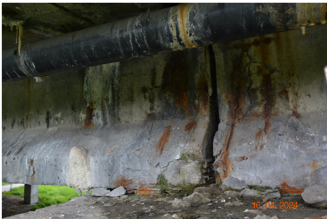
Fot. 32. Widoczne przecieki przez pomost w strefie dylatacyjnej. Typowy stan dźwigarów nad podporami: zacieki, wykwity, korozja zbrojenia miękkiego, odpryski otuliny. Blokada przesuwu na skorodowanych łożyskach.
