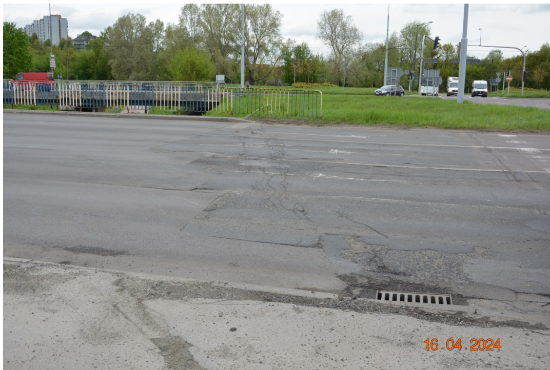
Fot. 20. Deformacje, zarysowania, przemieszczenia i wykruszenia nawierzchni jezdni w obszarach dojazdów i dylatacyjnych nad podporami 1 i 4
