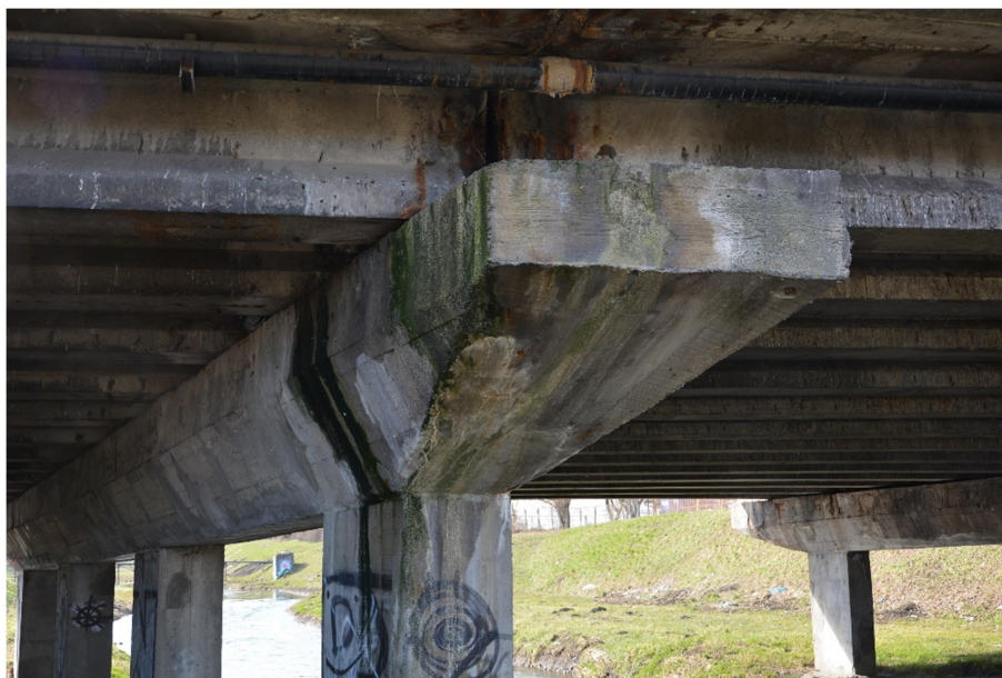
Fot. 9. Uszkodzenia oczepu filara oraz dźwigarów głównych: przecieki wody, wegetacja roślin, korozja zbrojenia w następstwie nieszczelności dylatacji
