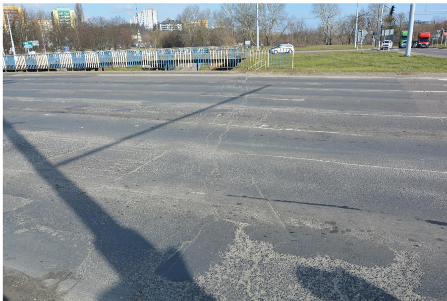
Fot. 5. Typowe uszkodzenia w obrębie skrzydeł: deformacje, rysy i ubytki materiału
