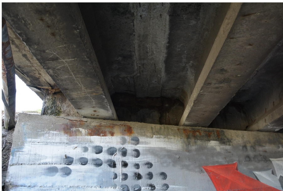
Fot. 10. Typowe uszkodzenia przyczółków, m.in.: przecieki wody i osady (świadczące o nieszczelności urządzeń dylatacyjnych), pęknięcia, korozja zbrojenia
