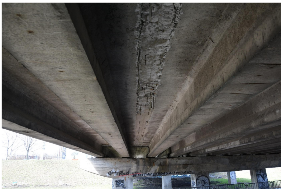
Fot. 8. Liczne przecieki wody na płycie pomostu świadczące o nieszczelności izolacji
