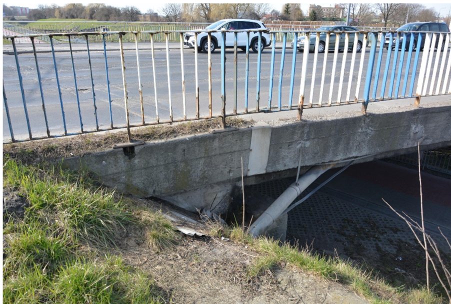
Fot. 7. Typowe uszkodzenia belek podporęczowych: ubytki i korozja betonu, wegetacja roślin, osady i wykwit. Typowe uszkodzenia balustrad po obu stronach obiektu: zniszczenie powłoki malarskiej oraz korozja elementów balustrady
