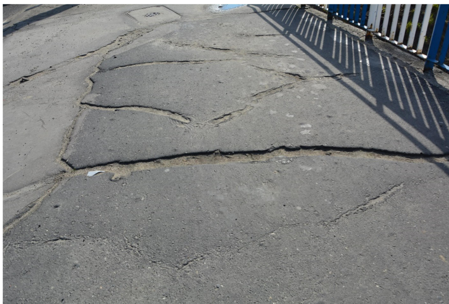
Fot. 6. Typowe uszkodzenia nawierzchni na chodniku: deformacje, ubytki materiału i przemieszczenia
