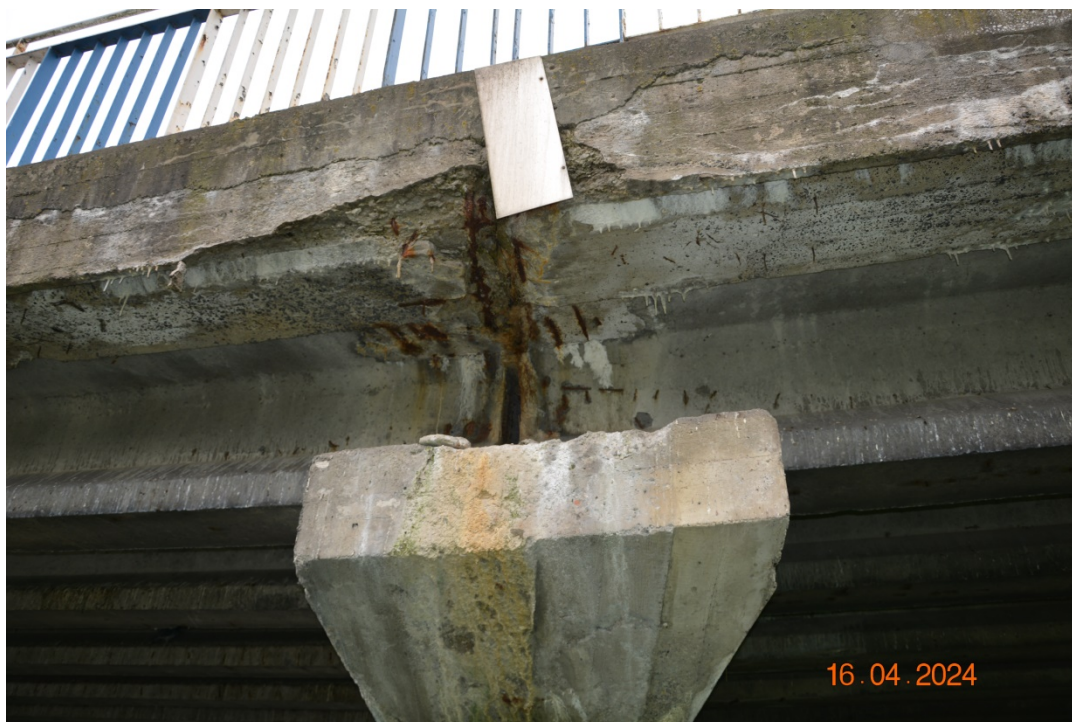
Fot. 25. Lokalnie korozja betonu, zarysowania, przecieki i ubytki betonu belek podporęczowych w strefach dylatacyjnych pomostu.
