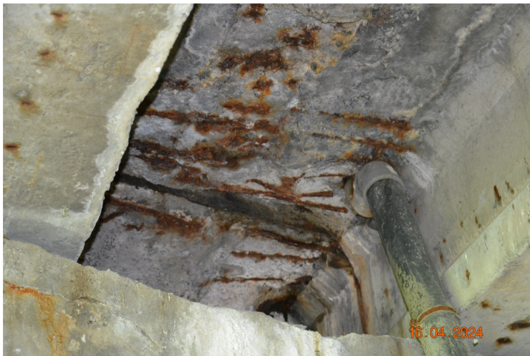
Fot. 31. Widoczne przecieki przez pomost w strefie dylatacyjnej. Typowy stan pomostu nad podporami pośrednimi: przecieki, zacieki, wykwyty, korozja zbrojenia miękkiego, odpryski otuliny.
