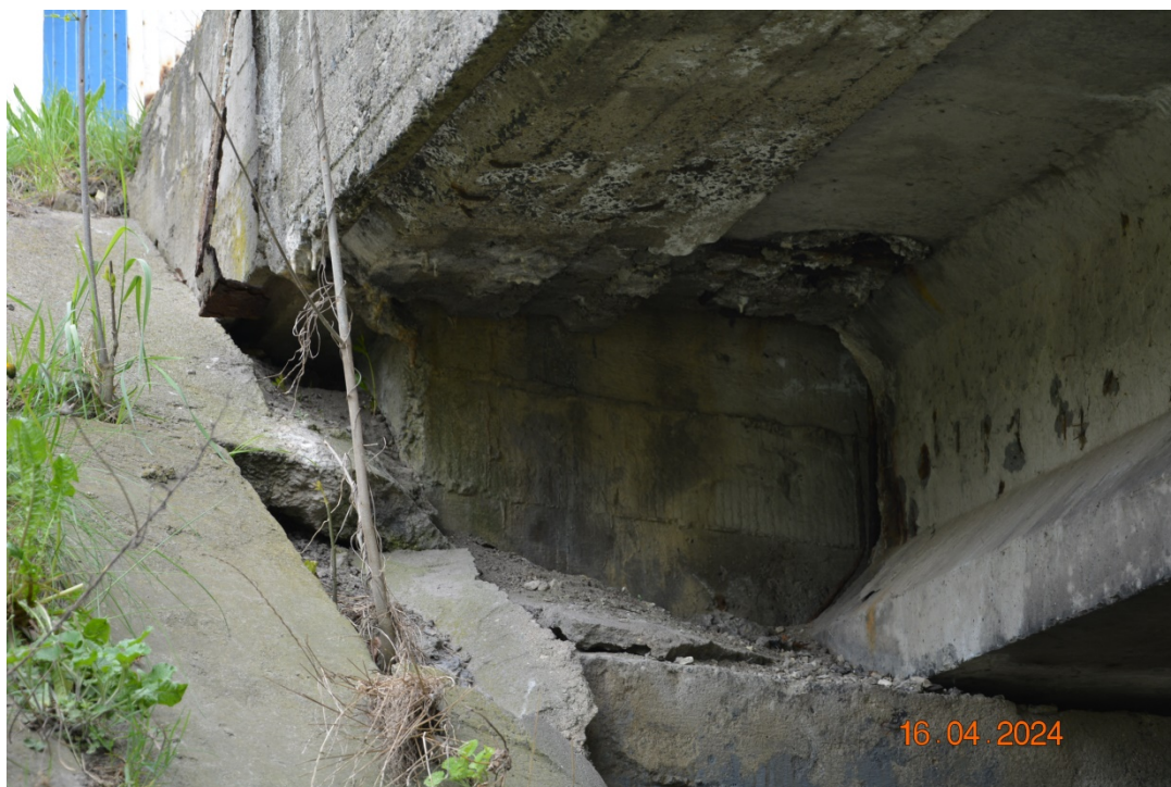
Fot. 36. Typowe uszkodzenia przyczółków, m.in.: przecieki wody i osady (świadczące o nieszczelności stref dylatacyjnych), pęknięcia, zanieczyszczenia graffiti. Blokada dźwigarów nad podporami skrajnymi.
