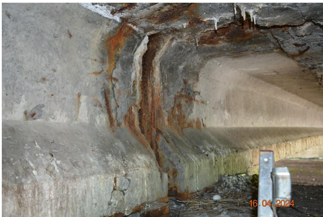
Fot. 30. Widoczne przecieki przez pomost w strefie dylatacyjnej. Typowy stan dźwigarów nad podporami: zacieki, wykwyty, korozja zbrojenia miękkiego, odpryski otuliny. Blokada przesuwu na skorodowanych łożyskach.
