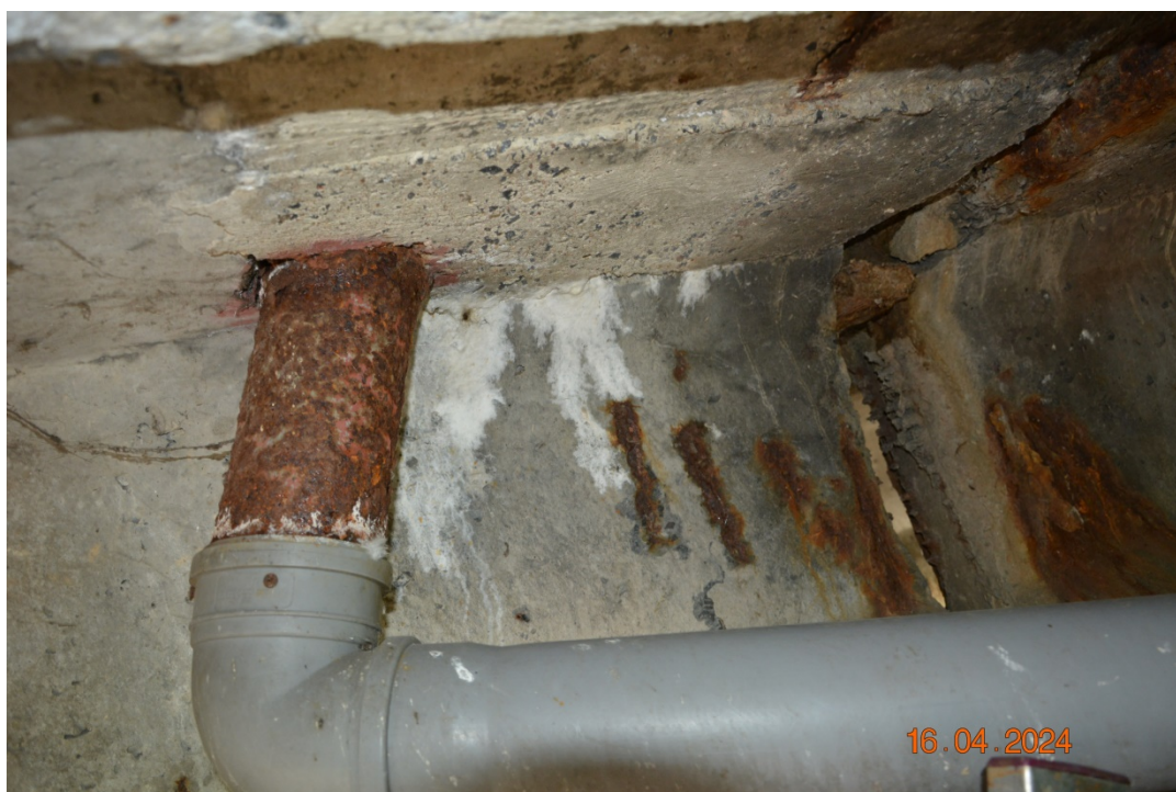
Fot. 26. Korozja rur spustowych wpustów.
