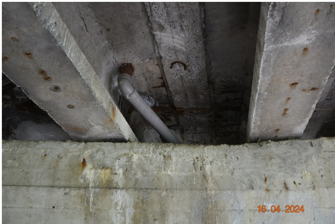
Fot. 34. Typowe uszkodzenia przyczółków, m.in.: przecieki wody i osady (świadczące o nieszczelności stref dylatacyjnych), pęknięcia, korozja zbrojenia, zanieczyszczenia graffiti.
