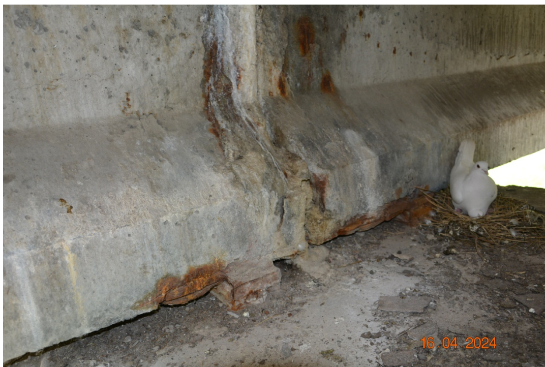
Fot. 32. Typowy stan łożysk. Korozja łożysk i blokada przesuwu na skorodowanych łożyskach. Bytowanie ptaków na podporach.
