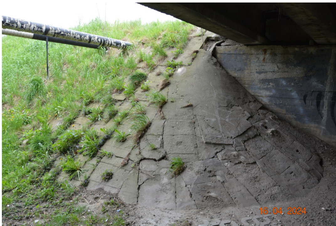
Fot. 19. Zarysowania, deformacje i ubytki betonu umocnienia skarp przy przyczółkach. Wegetacja roślinności na umocnieniach skarp przy przyczółkach.
