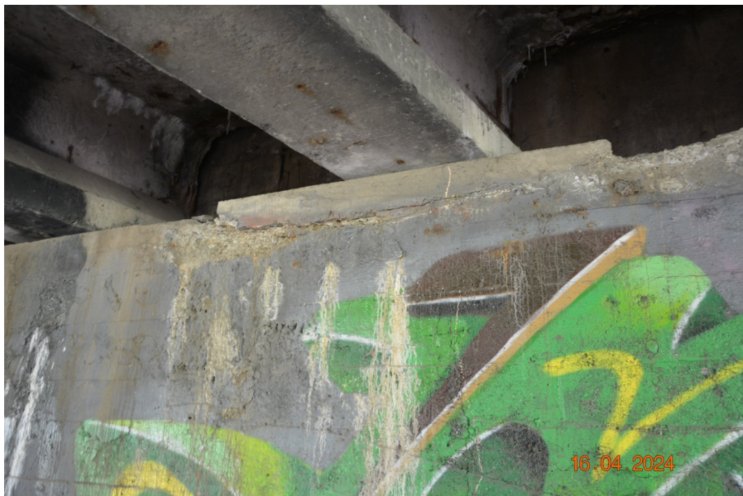
Fot. 35. Typowy stan przyczółków, m.in.: przecieki wody i osady (świadczące o nieszczelności stref dylatacyjnych), pęknięcia, korozja zbrojenia, zanieczyszczenia graffiti.
