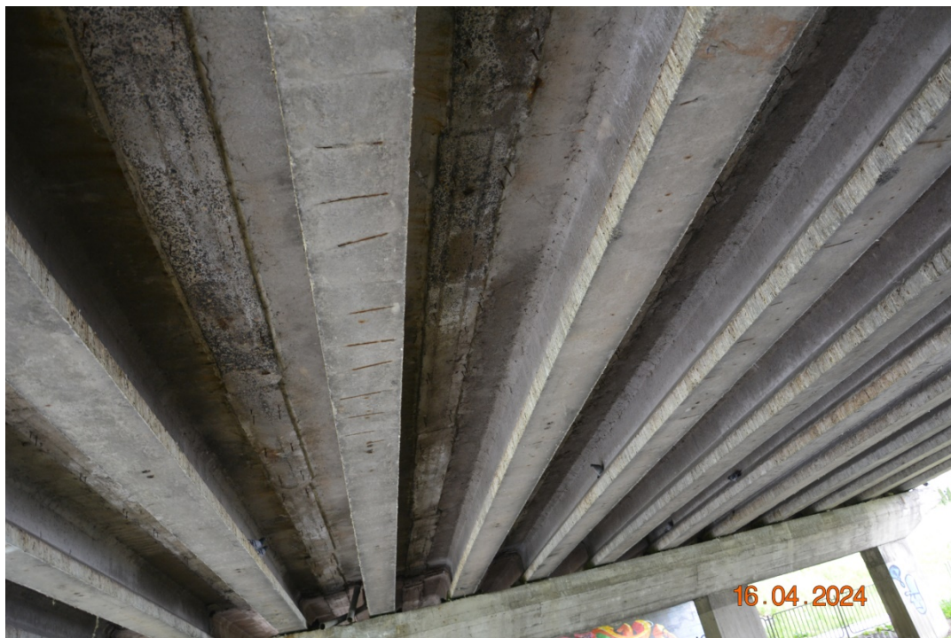
Fot. 27. Widoczne przecieki przez zamki pomostu świadczące o nieszczelności izolacji. Typowy stan pomostu: przecieki, wykwyty, korozja zbrojenia zamków, odpryski otuliny.
