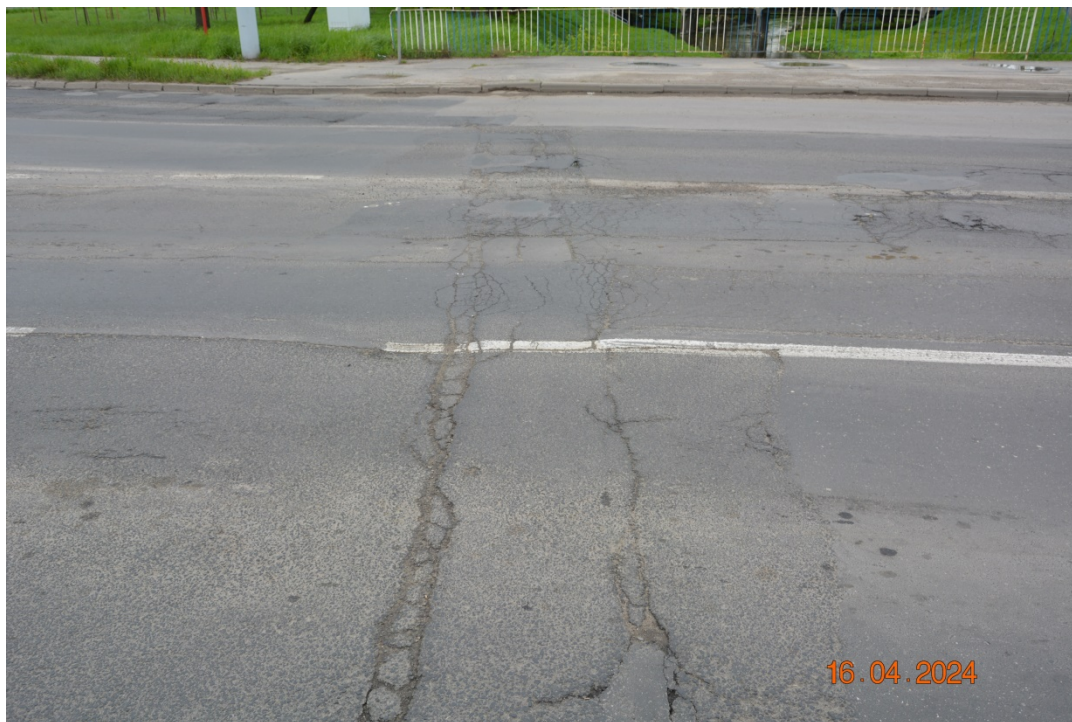
Fot. 20. Deformacje, zarysowania, przemieszczenia i wykruszenia nawierzchni jezdni w obszarach dojazdów i dylatacyjnych nad podporami 1, 2 i 4
