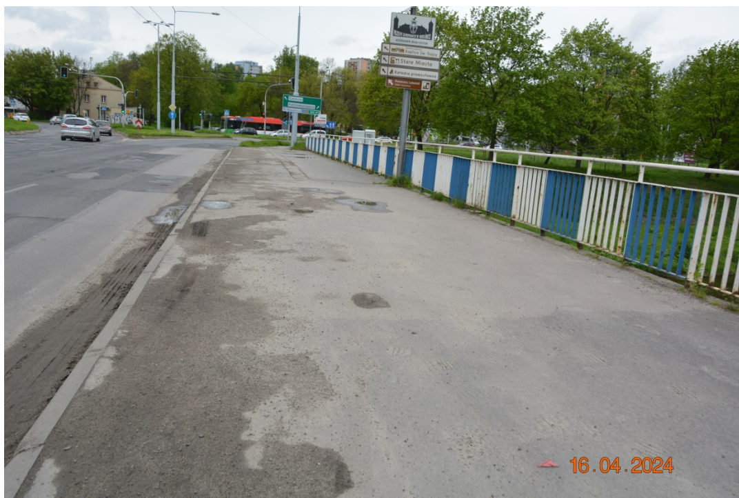
Fot. 22. Zanieczyszczenia, deformacje, zarysowania, przemieszczenia i wykruszenia nawierzchni chodnika na pomoście i dojazdach
