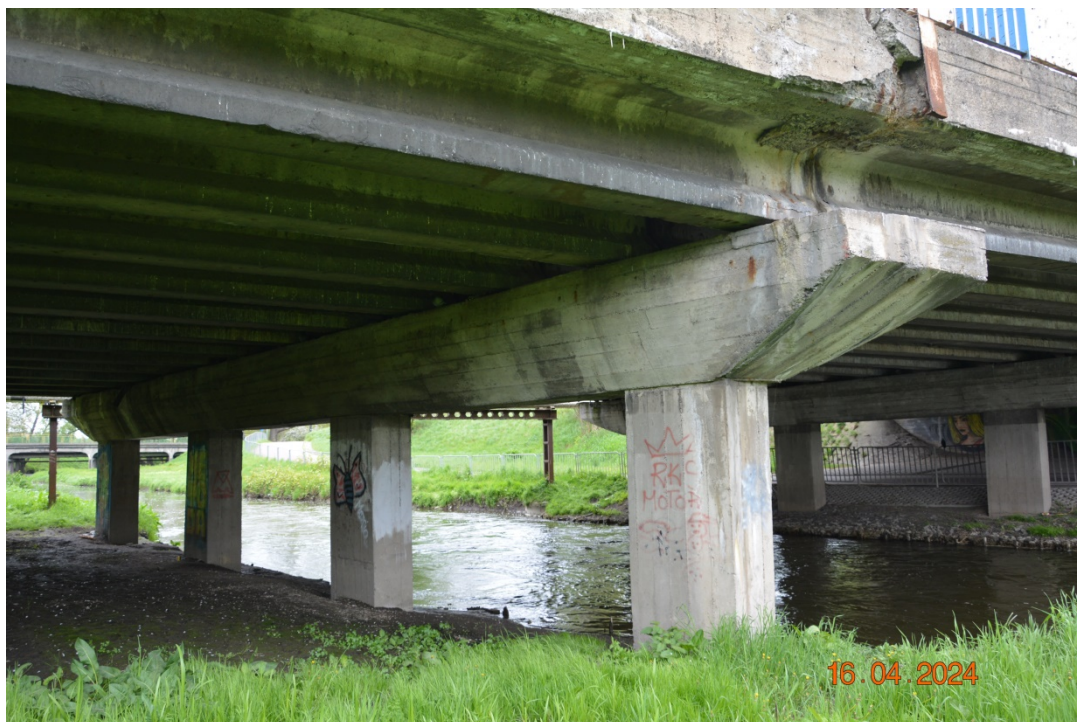
Fot. 33. Typowy stan podpór pośrednich 2 i 3. Uszkodzenia oczechu filara: przecieki wody, wegetacja roślin, korozja zbrojenia w następstwie nieszczelności dylatacji. Zarysowania słupów spowodowane korozją zbrojenia wywołaną zawilgoceniem od przeciekającej z pomostu wody, zanieczyszczenia graffiti.
