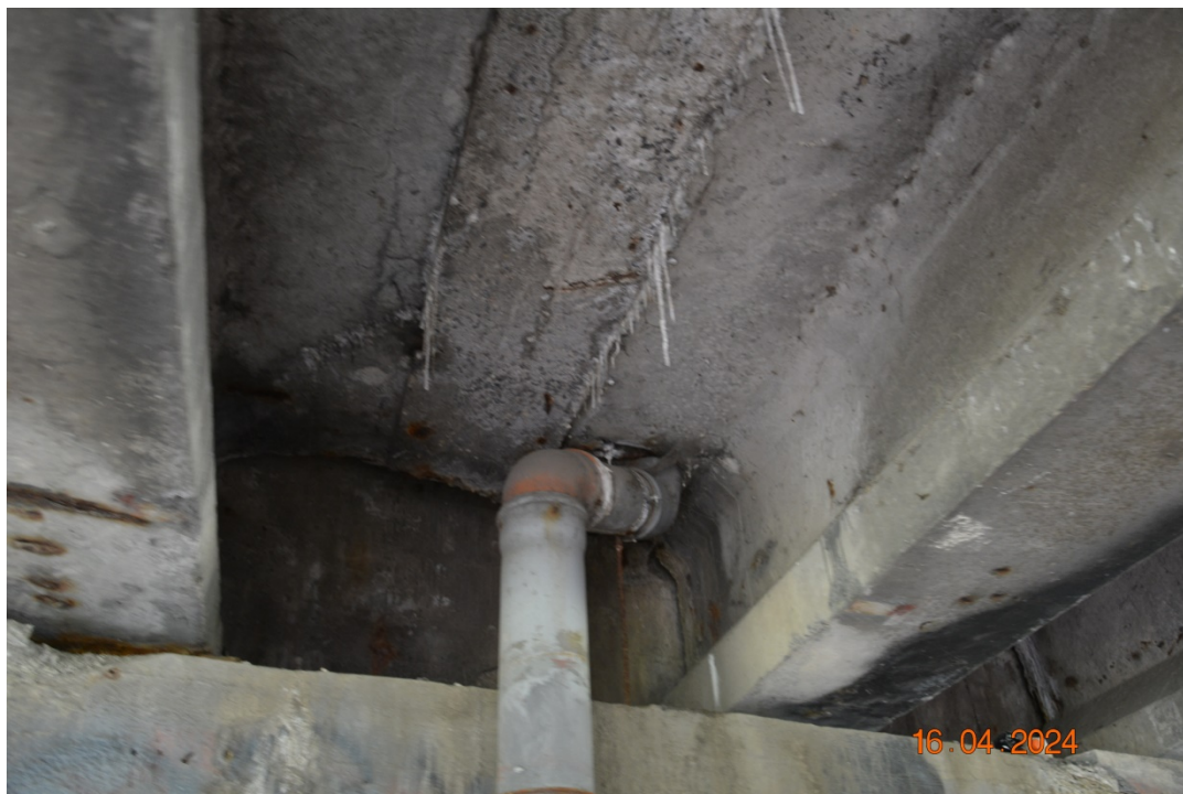
Fot. 29. Widoczne przecieki przez zamki pomostu świadczące o nieszczelności izolacji. Typowy stan dźwigarów: zacieki, wykwyty, korozja zbrojenia miękkiego, odpryski otuliny. Blokada przęseł na podporach skrajnych.
