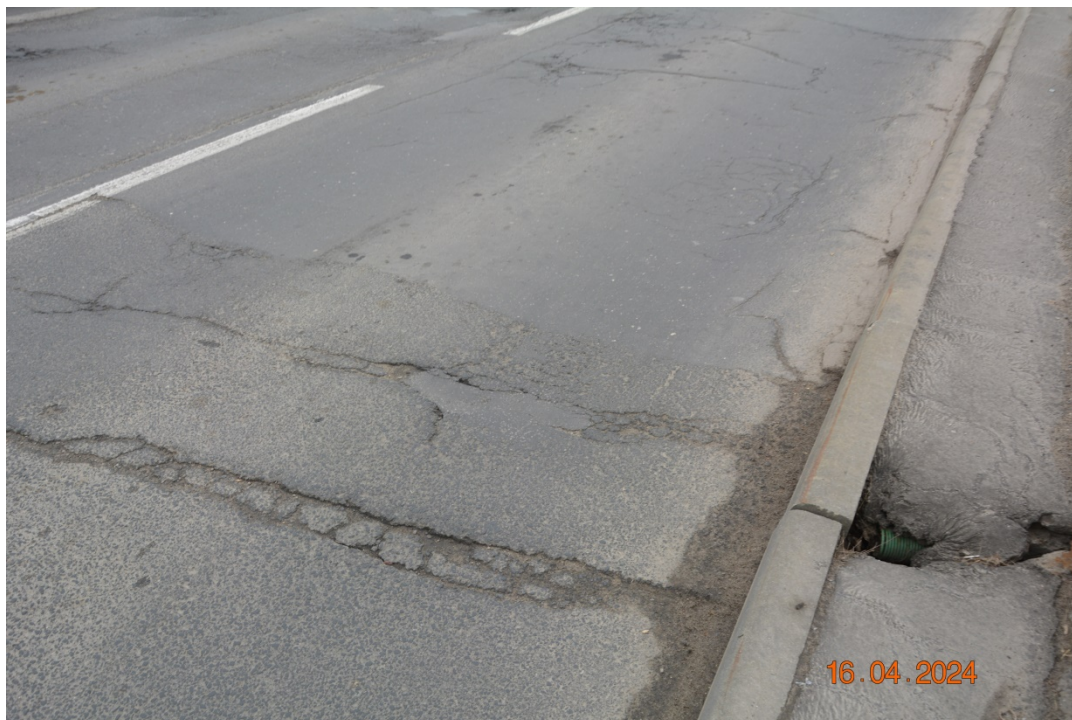
Fot. 21. Lokalne deformacje i ubytki nawierzchni jezdni kapy w przejściu 1 nad P1
