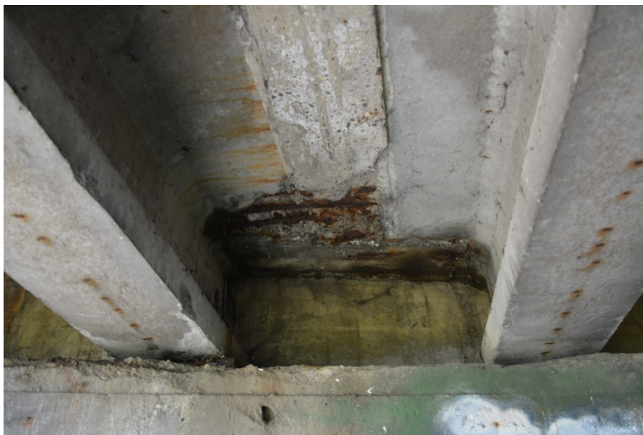
Fot. 9. Typowe uszkodzenia płyty pomostu: przecieki wody, ubytki betonu, korozja zbrojenia i betonu oraz
