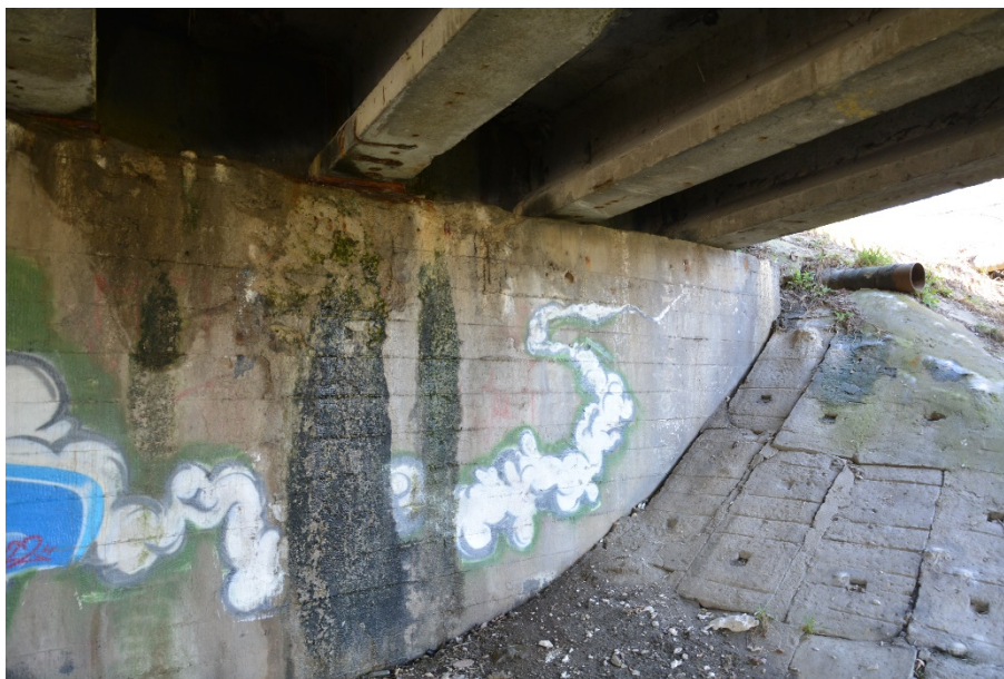
Fot. 11. Typowe uszkodzenia przyczółków, m.in.: przecieki wody i osady (świadczące o nieszczelności urządzeń dylatacyjnych), pęknięcia, korozja betonu
