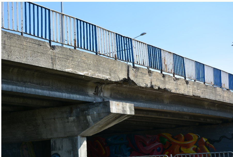
Fot. 7. Typowe uszkodzenia belek podporęczowych: ubytki i korozja betonu, osady i wykwyty oraz balustrad: zniszczenie powłoki malarskiej oraz korozja elementów balustrady
