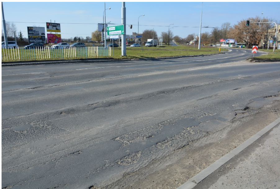
Fot. 5. Typowe uszkodzenia nawierzchni w obrębie skrzydeł i na obiekcie: zanieczyszczenia, deformacje, rysy i ubytki materiału
