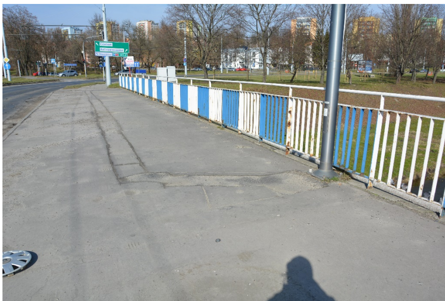
Fot. 6. Typowe uszkodzenia nawierzchni na chodniku: deformacje, ubytki materiału
