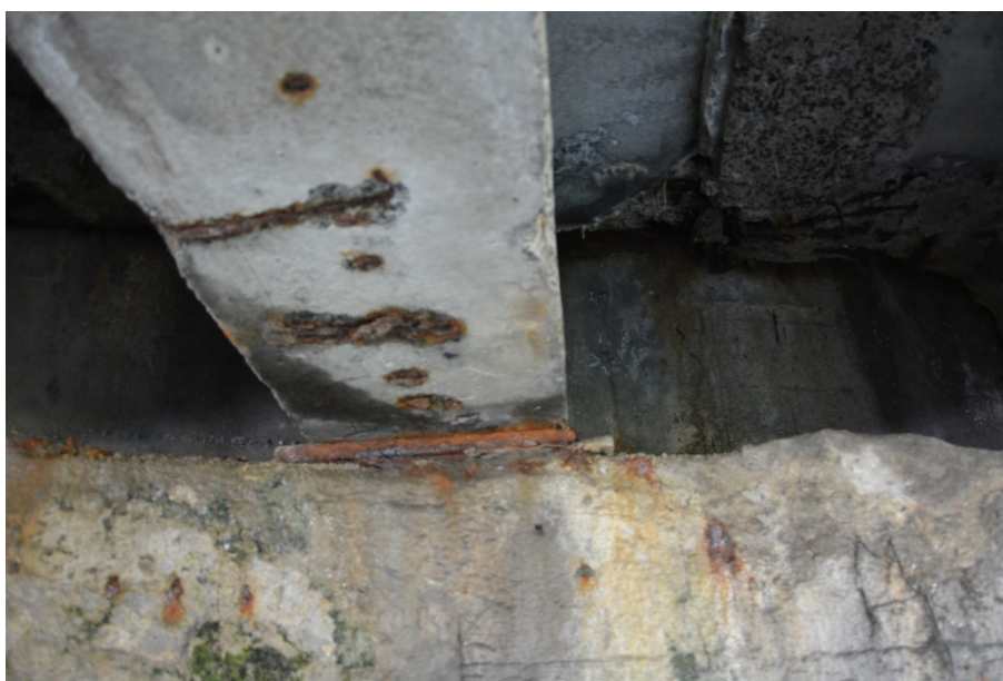
Fot. 10. Uszkodzenia łożysk: korozja i zanieczyszczenia. Dodatkowo widoczne typowe uszkodzenia dźwigarów głównych: ubytki betonu i korozja odsłoniętego zbrojeni oraz liczne przecieki wody na płycie pomostu świadczące o nieszczelności izolacji
