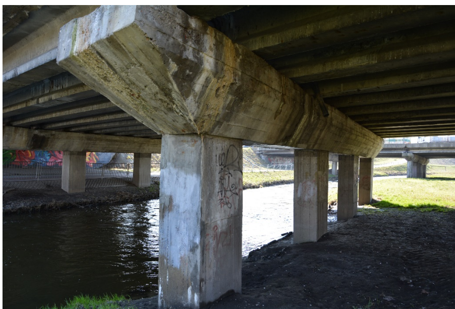
Fot. 12. Typowe uszkodzenia filarów, m.in.: przecieki wody, osady i wykwity a także korozja betonu
