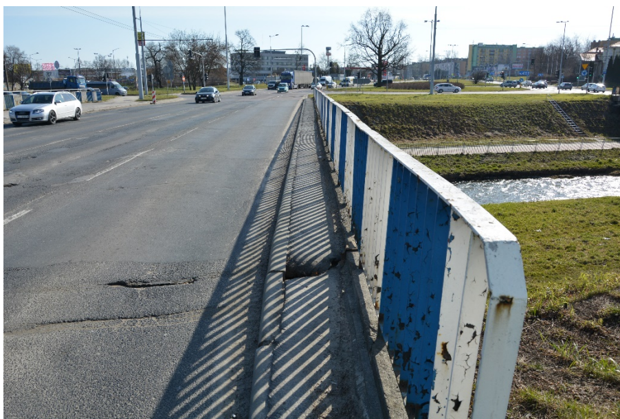
Fot. 8. Zapadnięta nawierzchnia kapy gzymsowej na zjeździe z obiektu
