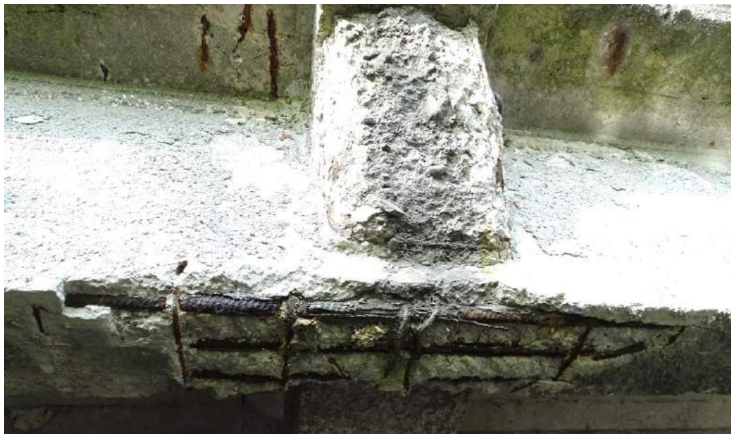
Fot. 25. Przęsło 3-4, dźwigar skrajny od DW w środku rozpiętości. Intensywna korozja i ubytki przekroju zbrojenia, rozległe ubytki otuliny betonowej. Widoczna korozja zbrojenia na wsporniku podchodnikowym.
