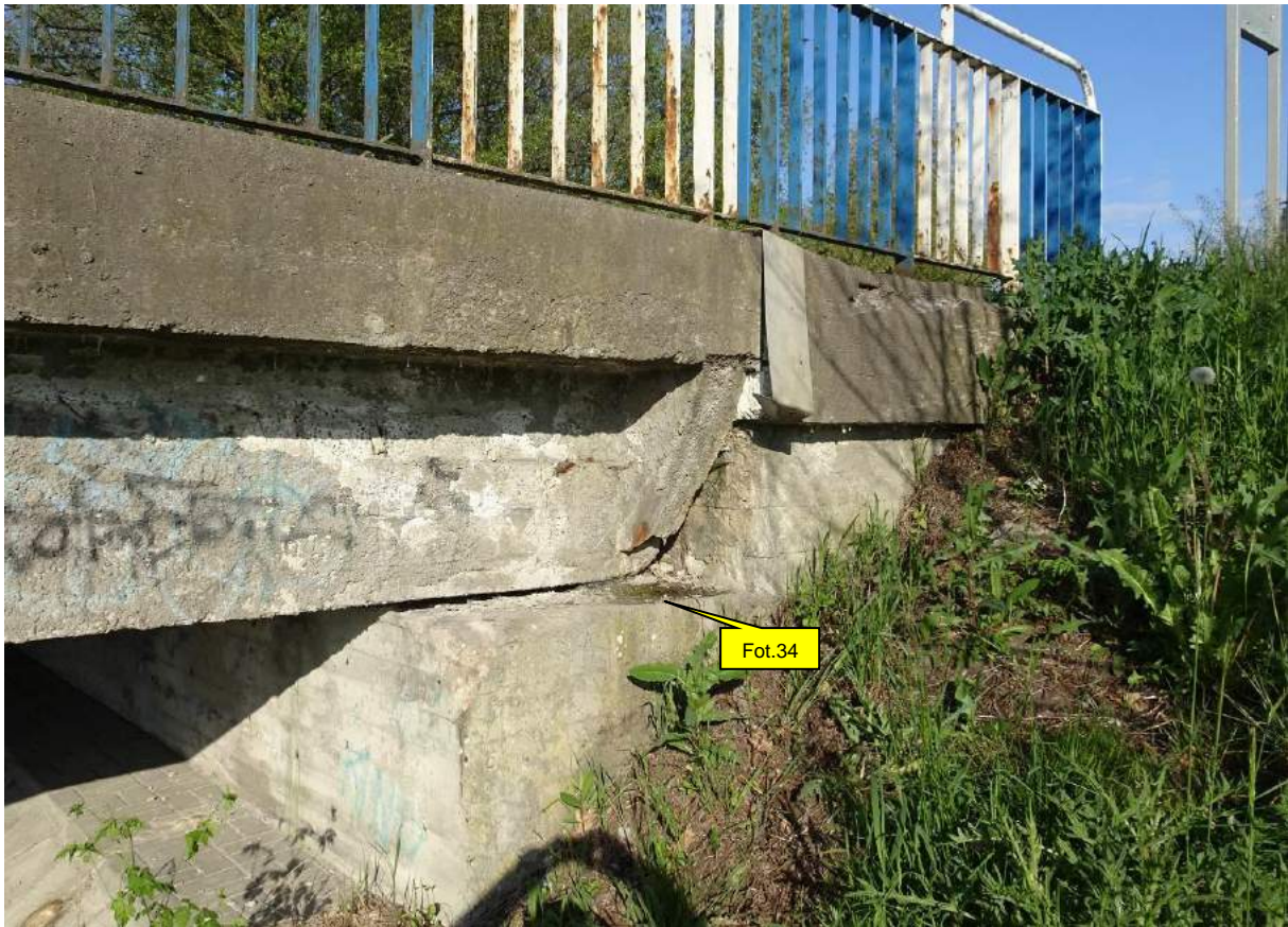
Fot. 33. Podpora nr 1, widok od DW. Zanieczyszczenie ławy podłożyskowej i zniszczone łożysko (patrz fot. 35). Ubytki betonu w gzymsie. Wegetacja na umocnieniu stożka. Widoczne zniszczone betonowe umocnienie wylotu kanału deszczowego.
