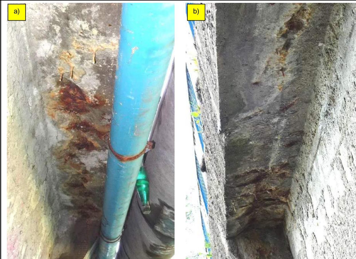
Fot. 29. Typowe uszkodzenia wspornika podchodnikowego od GW (fot. a) i od DW (fot. b). Intensywne przecieki, korozja i ubytki betonu oraz korozja zbrojenia, występujące z różną intensywnością na całej długości mostu.
