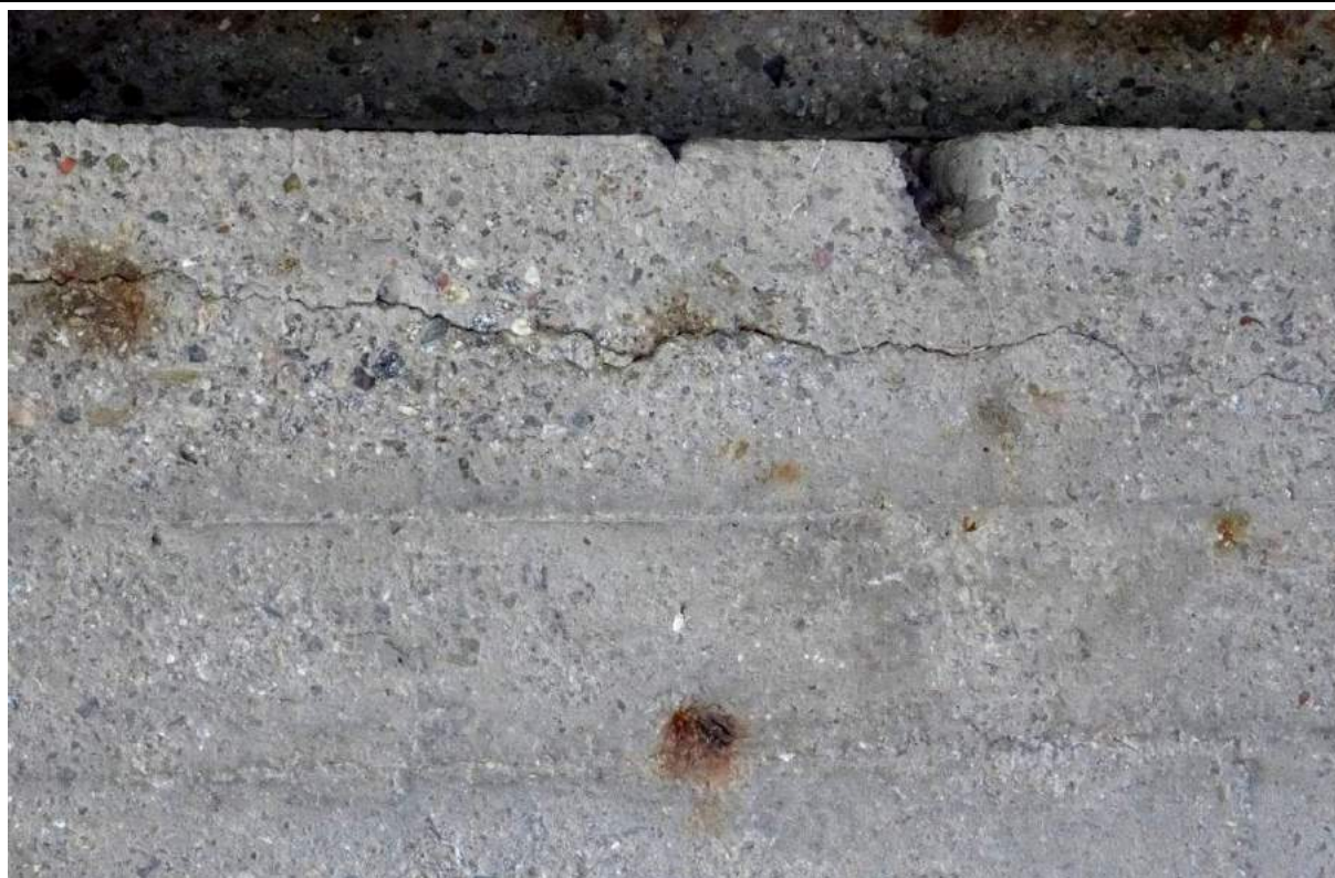
Fot. 48. Podpora nr 2. Szczegół rysy poziomej w górnej części oczepu spowodowanej korozją zbrojenia głównego.
