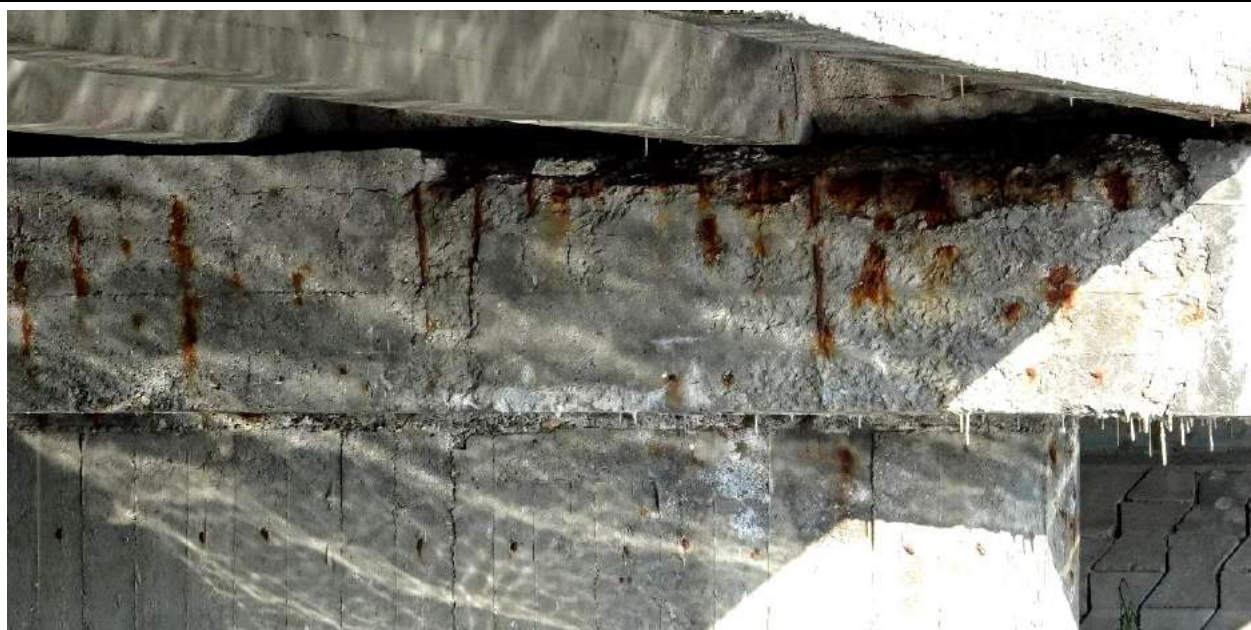
Fot. 51. Podpora nr 2, widok od str. podpory nr 3. Rozległe ubytki skorodowanego betonu oraz intensywna korozja i ubytki przekroju odsłoniętego zbrojenia oczepu nad słupem od DW. Na dolnej powierzchni oczepu widoczne stalaktyty świadczące o przeciekach przez oczep. Uszkodzenia spowodowane przeciekami przez dylatację.
