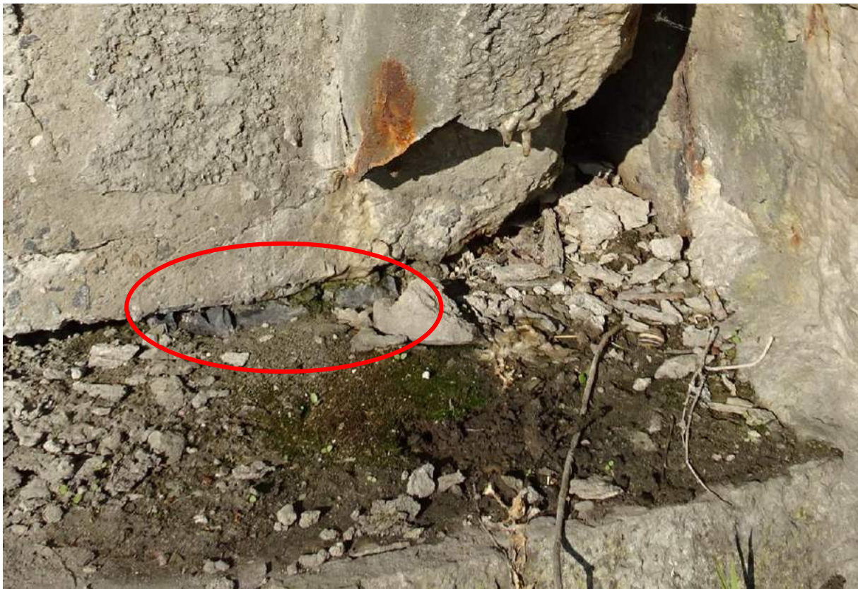
Fot. 34. Podpora nr 1, widok od DW. Zniszczone (zmiażdżone) łożysko gumowe. Zanieczyszczenie ławy gruzem betonowym i mchem oraz zawilgocenie spowodowane przeciekami przez dylatację.
