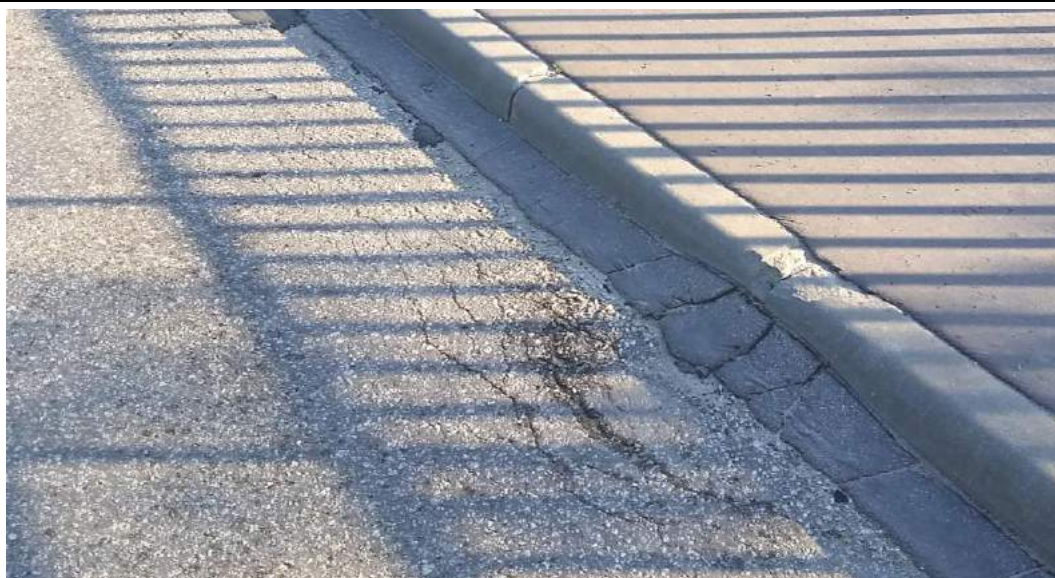
Fot. 8. Spękania podłużne i siatkowe nawierzchni jezdni, występujące z różną intensywnością wzdłuż krawężnika od DW i lokalnie wzdłuż krawężnika od GW.
