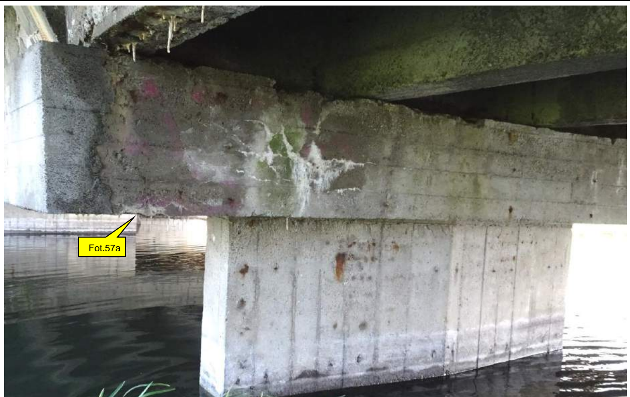
Fot. 55. Podpora nr 3, słup od GW, widok od str. podpory nr 4. Przepieki i korozja ługująca betonu w oczepie . Ogniska korozji zbrojenia w słupie. Uszkodzenia spowodowane przeciekami przez dylatację i wspornik podchodnikowy.
