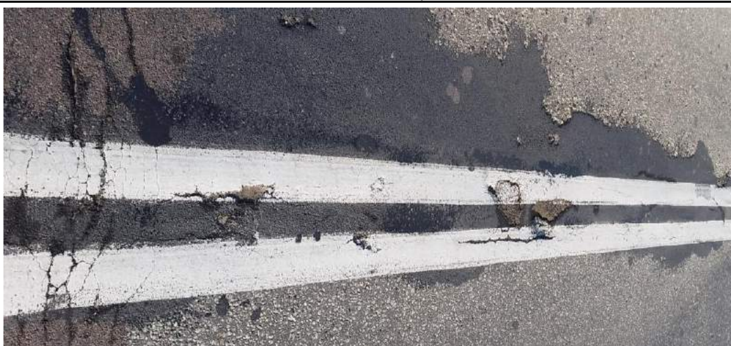
Fot. 9. Spękania i niewielkie ubytki nawierzchni w osi jezdni, widoczne na całej długości mostu.
