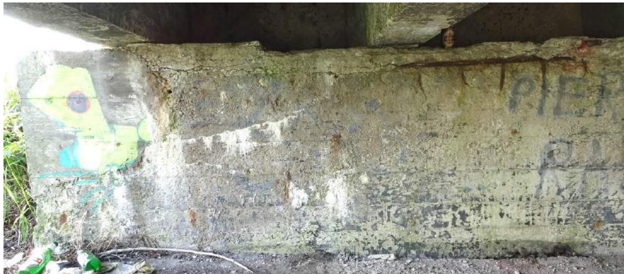
Fot. 43. Podpora nr 4. Zarysowania i ubytki betonu wzdłuż krawędzi ławy podłożyskowej spowodowane korozją zbrojenia w następstwie przecieków przez dylatację.
