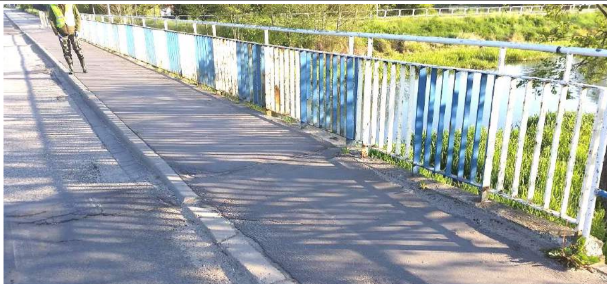
Fot. 11. Widok wzdłuż chodnika od str. DW. Deformacje nawierzchni na dojeździe od str. ul. Osmolickiej. Wegetacja roślinna wzdłuż balustrady.
