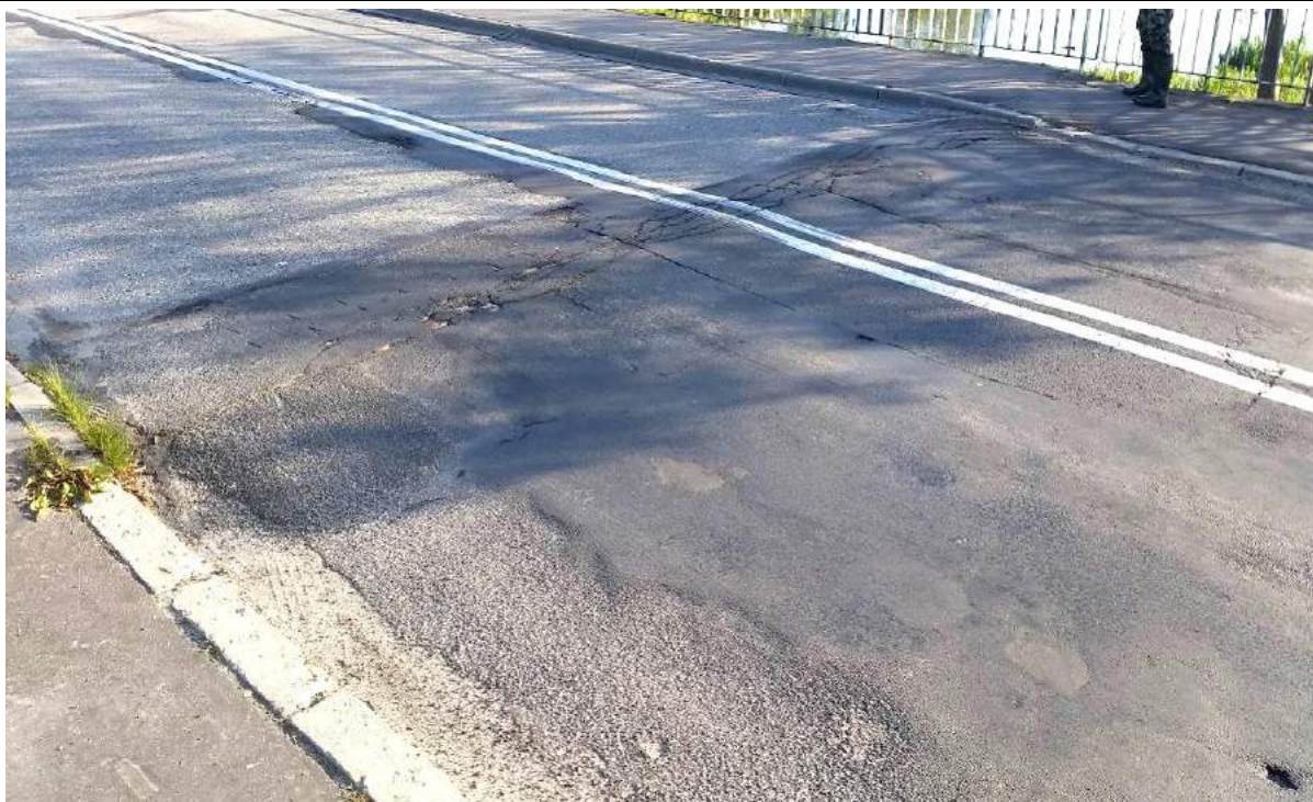
Fot. 13. Dojazd od str. ul. Osmolickiej. Zaniżenie i deformacje poprzeczne i podłużne nawierzchni dojazdu. Spękania i ubytki nawierzchni w obrębie dylatacji.
