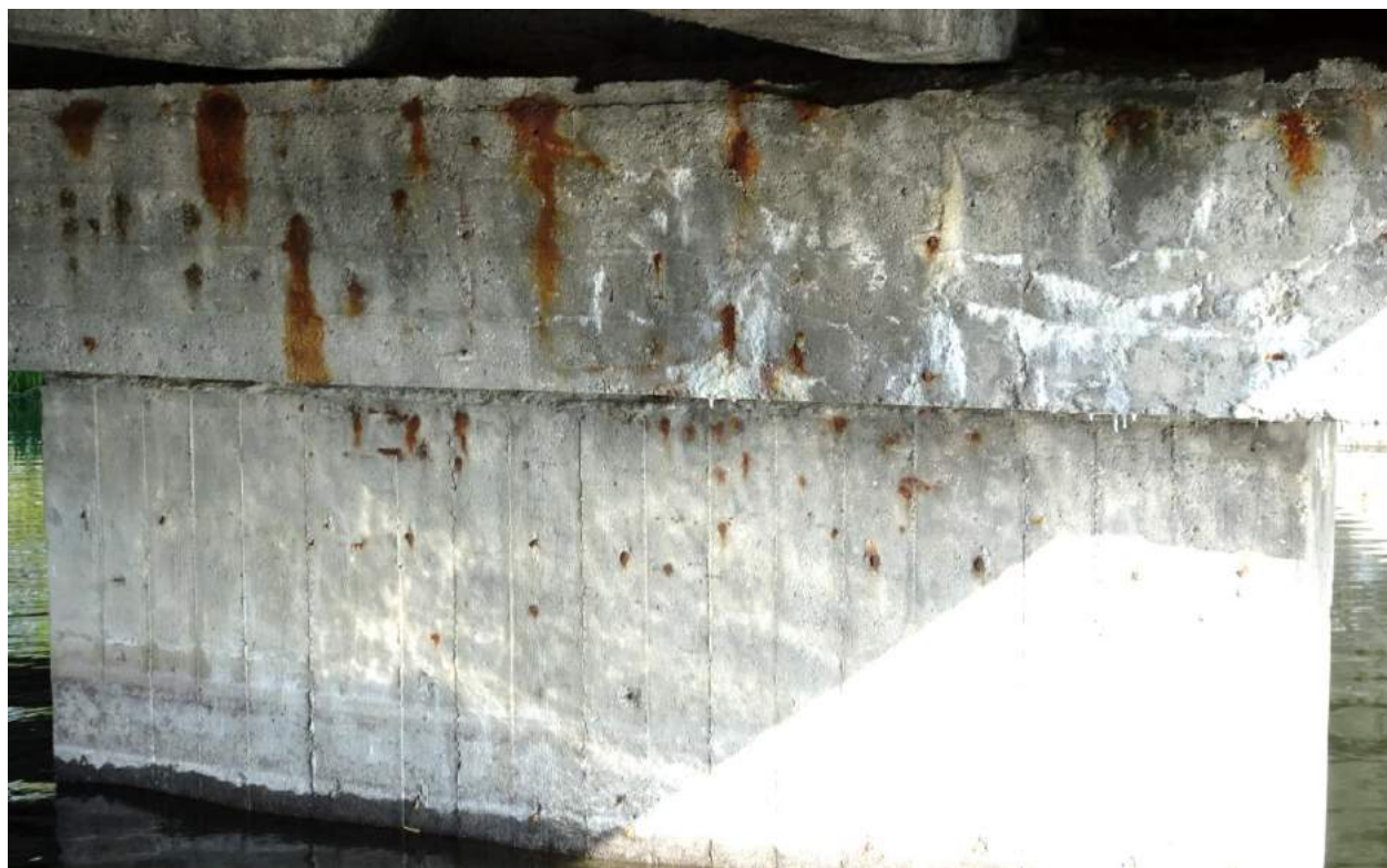
Fot. 56. Podpora nr 3, słup od DW, widok od str. podpory nr 4. Przepieki przez oczep, korozja ługująca i powierzchniowe ubytki betonu. Intensywna korozja zbrojenia w oczepie i w górnej części słupa.
