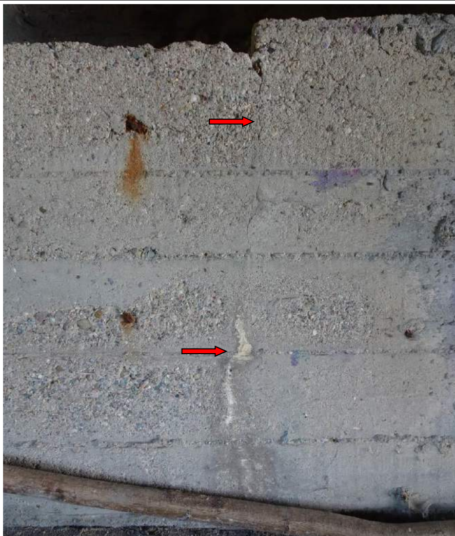
Fot. 36. Podpora nr 1. Rysa pionowa w ścianie czołowej o rozwarości do 0,4 mm, pomiędzy 2 i 3 dźwigarem od GW. Niewielkie wycieki przez rysę. Korozja zbrojenia licującego z powierzchnią betonu.
