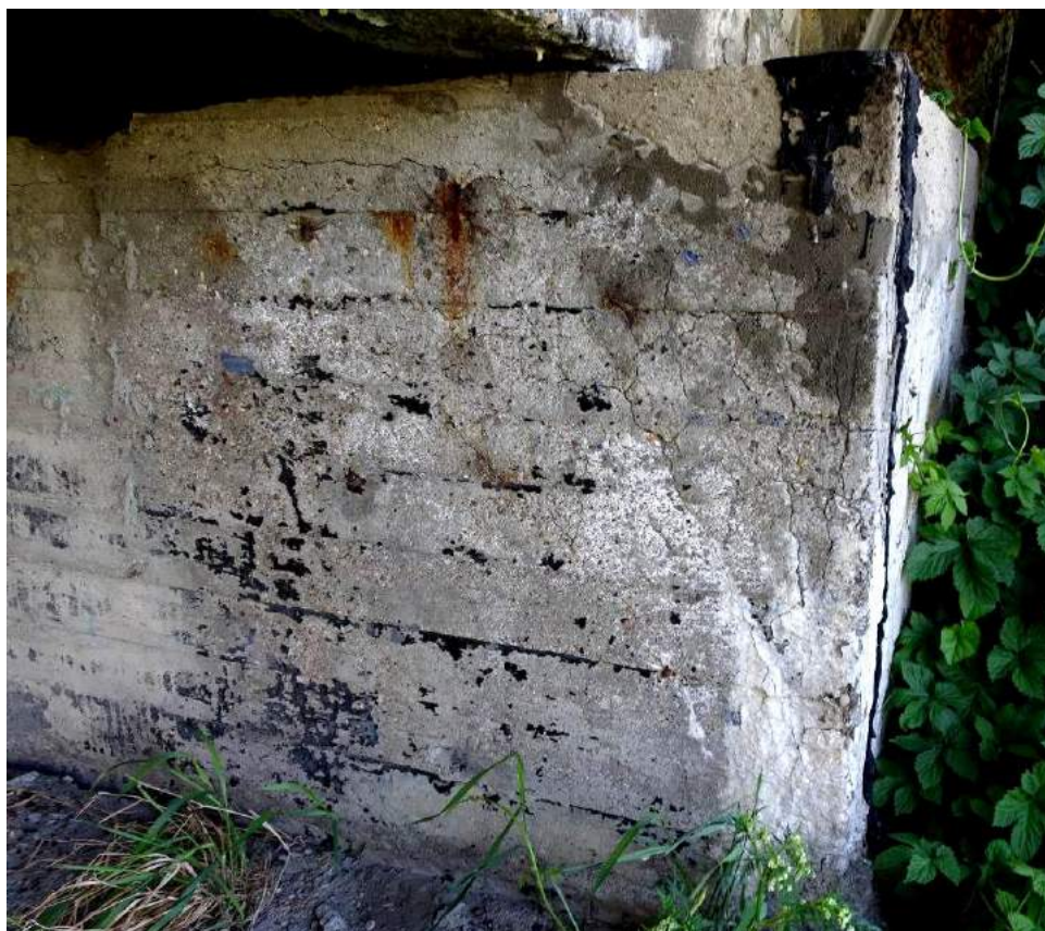
Fot. 42. Podpora nr 4. Spękania i wykwyty spowodowane korozją ługującą betonu oraz korozją zbrojenia w narożu ściany czołowej od GW.
