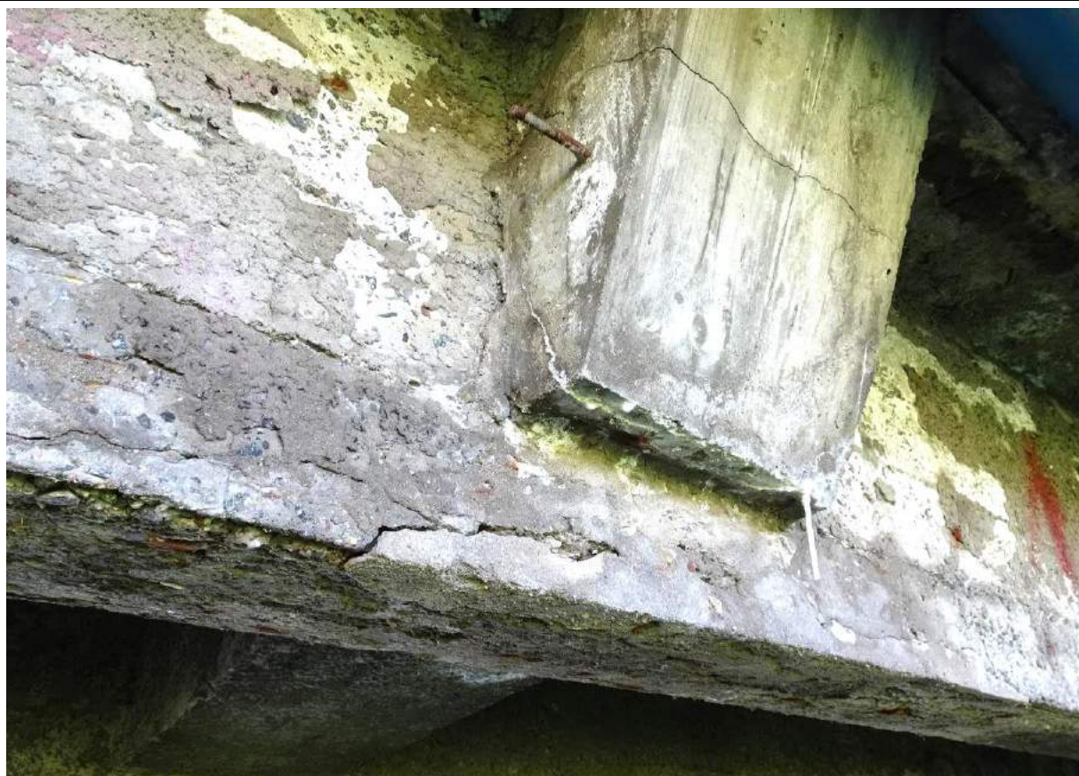
Fot. 24. Przęsło 3-4, dźwigar skrajny od GW w środku rozpiętości. Intensywna korozja betonu i zbrojenia, odpryski otuliny spowodowane korozją zbrojenia. Zarysowanie poziome w poprzecznicy.
