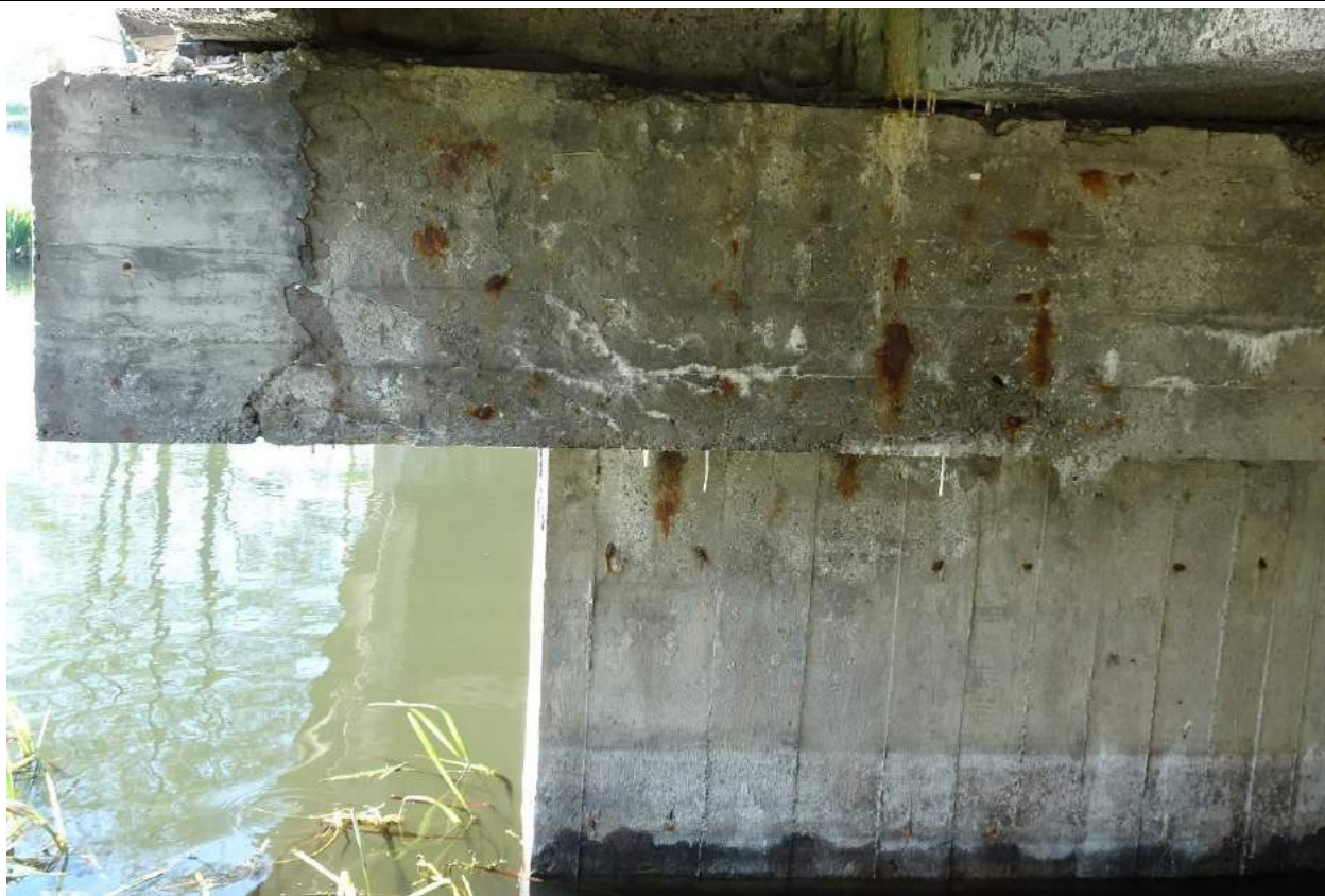
Fot. 46. Podpora nr 2, widok od str. podpory nr 1. Szczegół uszkodzeń oczeput od DW. Korozja betonu i zbrojenia spowodowana intensywnymi przeciekami przez nieszczelną dylatację.
