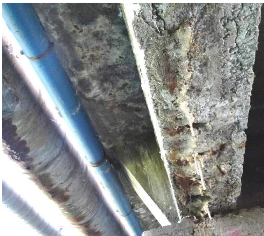
Fot. 23. Przęsło 3-4, dźwigar skrajny od GW nad podporą nr 3. Intensywna korozja betonu i zbrojenia oraz odpryski otuliny spowodowane korozją zbrojenia. Widoczne przecieki i korozja betonu i zbrojenia na wsporniku podchodnikowym oraz uszkodzenia urządzeń obcych.
