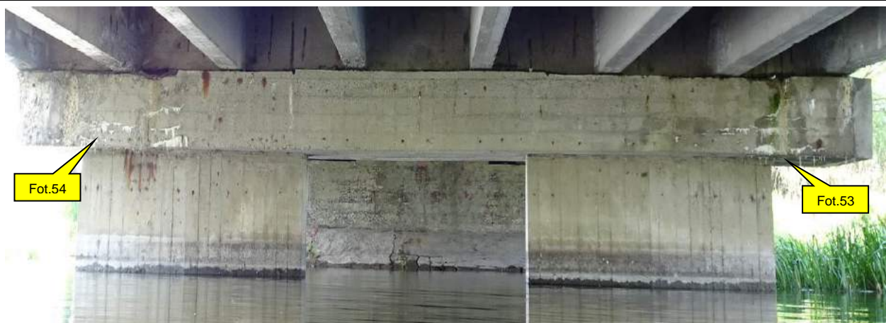
Fot. 52. Podpora nr 3, widok ogólny od str. podpory nr 2. Przecieki, wykwyty, korozja betonu i zbrojenia w skrajnych częściach oczepu. Rysa pozioma w górnej części oczepu spowodowana korozją zbrojenia głównego.
