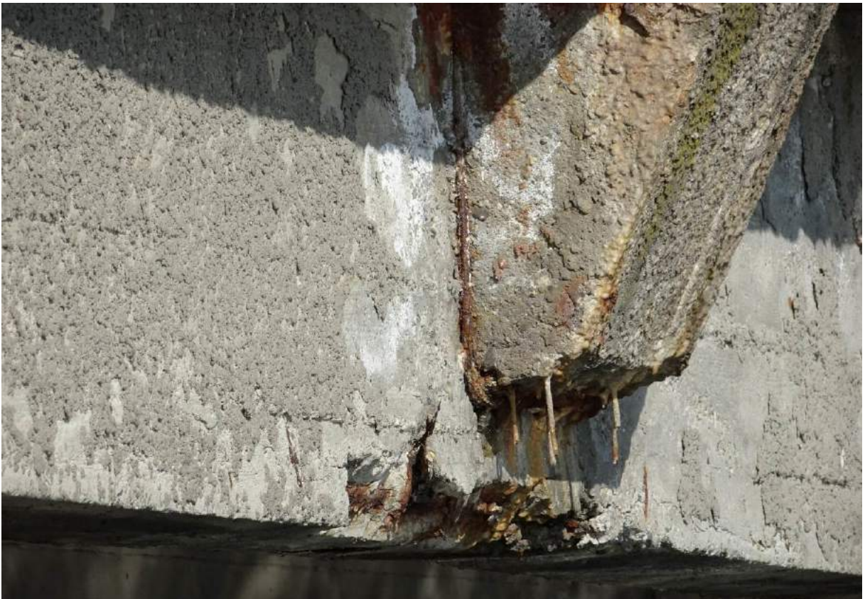
Fot. 22. Przęsło 2-3, środek rozpiętości dźwigara skrajnego od DW. Intensywna korozja i ubytki przekroju zbrojenia głównego i strzemion oraz spękania i ubytki otuliny betonowej. Widoczne zacieki i korozja betonu spowodowane przeciekami przez wspornik podchodnikowy.
