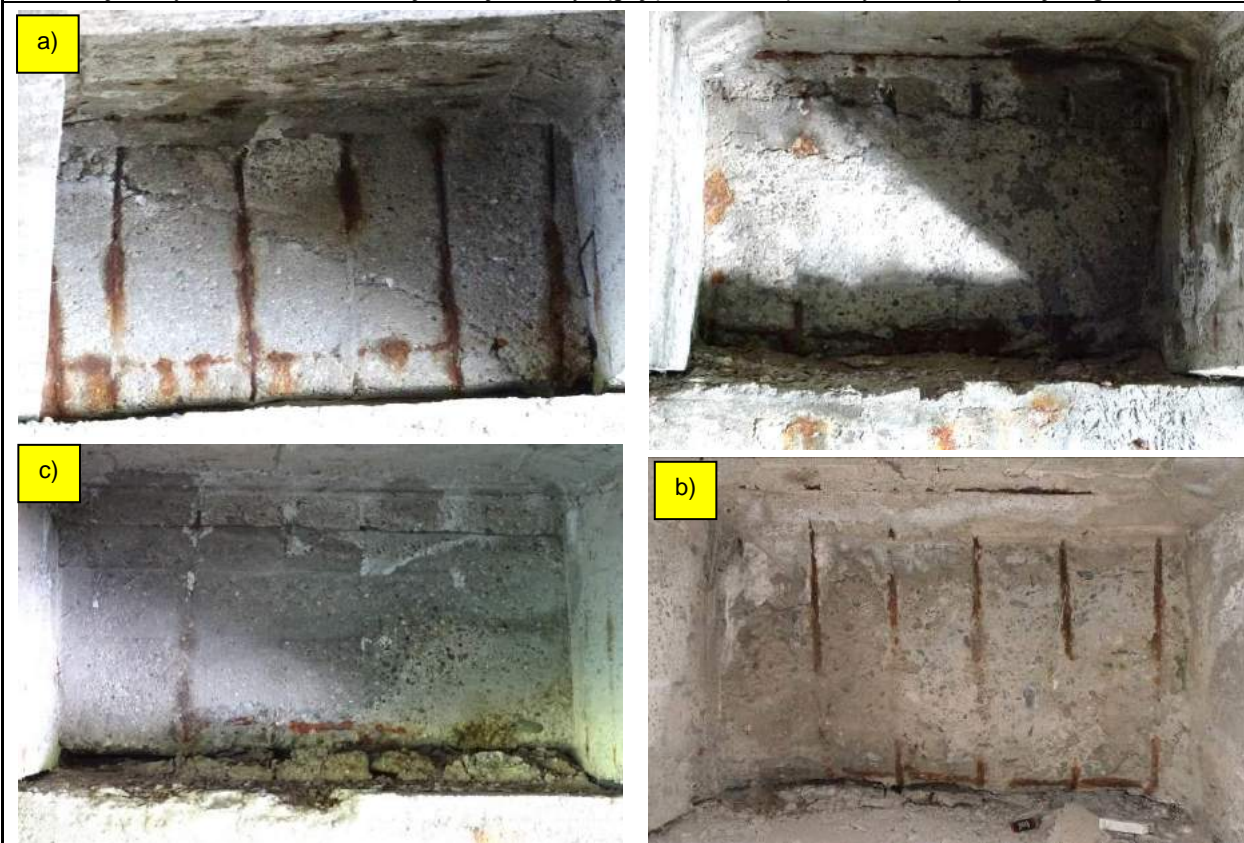
Fot. 30. Przykłady uszkodzeń poprzecznic podporowych: a) nad podporą nr 2; b) i c) nad podporą nr 3, d) nad podporą nr 4. Korozja zbrojenia spowodowana zbyt małą grubością otuliny betonowej.
