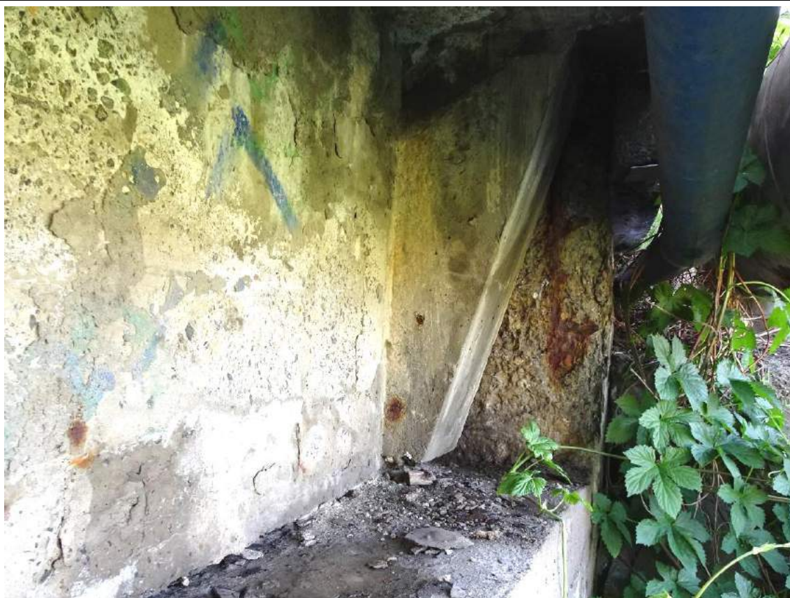
Fot. 38. Podpora nr 4, widok od GW. Ubytki betonu i korozja zbrojenia ścianki zapleczej spowodowana przeciekami przed dylatacją. Zwilgocenie ławy podłożyskowej.
