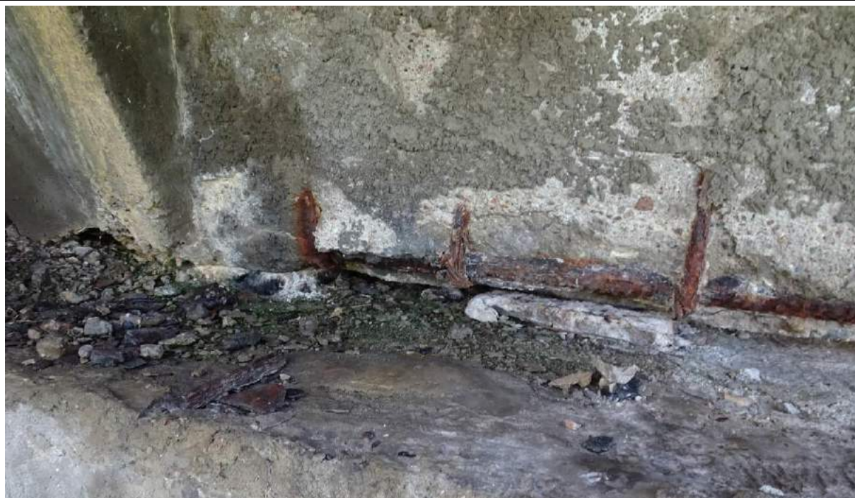
Fot. 17. Przęsło 1-2. Intensywna korozja zbrojenia głównego i strzemion powodująca odpryski otuliny w dźwigarze skrajnym od GW nad podporą nr 1. Zanieczyszczenia i zawilgocona ława podłożyskowa przyczołka.
