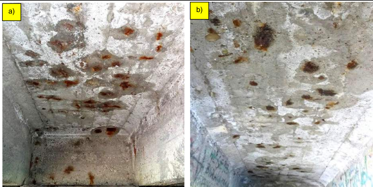
Fot. 27. Intensywna korozja zbrojenia w środkowym polu płyty pomostu w przęśle 1-2 (fot. a) i przęśle 3-4 (fot. b) spowodowana przeciekami przez konstrukcję pomostu (por. uszkodzenia nawierzchni na fot. 9).
