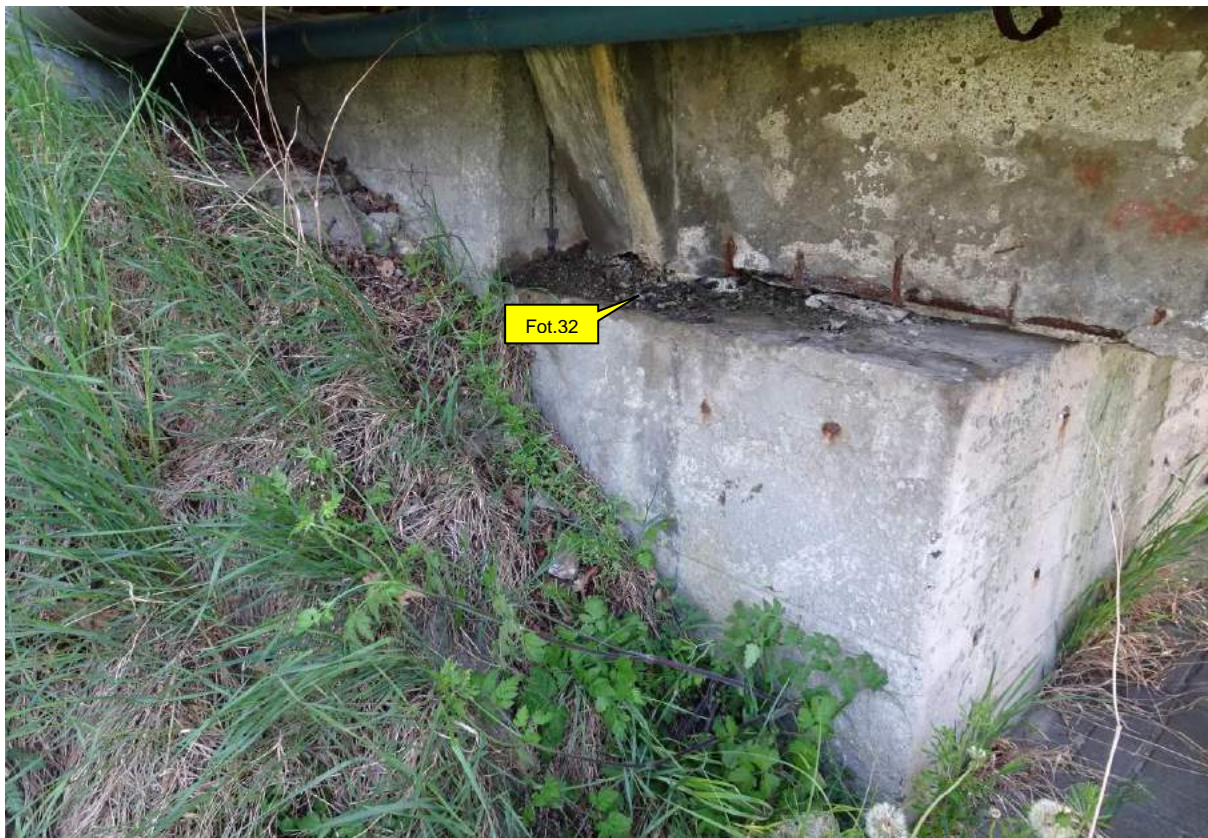
Fot. 31. Podpora nr 1, widok od GW. Zanieczyszczenie ławy podłożyskowej i zniszczone łożysko (patrz fot. 32). Wegetacja na umocnieniu stożka.
