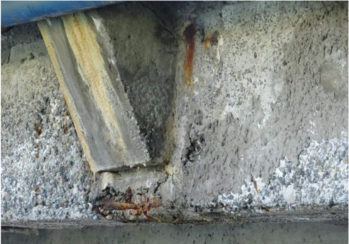
Fot. 21. Przęsło 2-3, środek rozpiętości dźwigara skrajnego od GW. Intensywna korozja i ubytki przekroju zbrojenia głównego i strzemion oraz spękania i ubytki otuliny betonowej. Widoczne zacieki i korozja betonu spowodowane przeciekami przez wspornik podchodnikowy.
