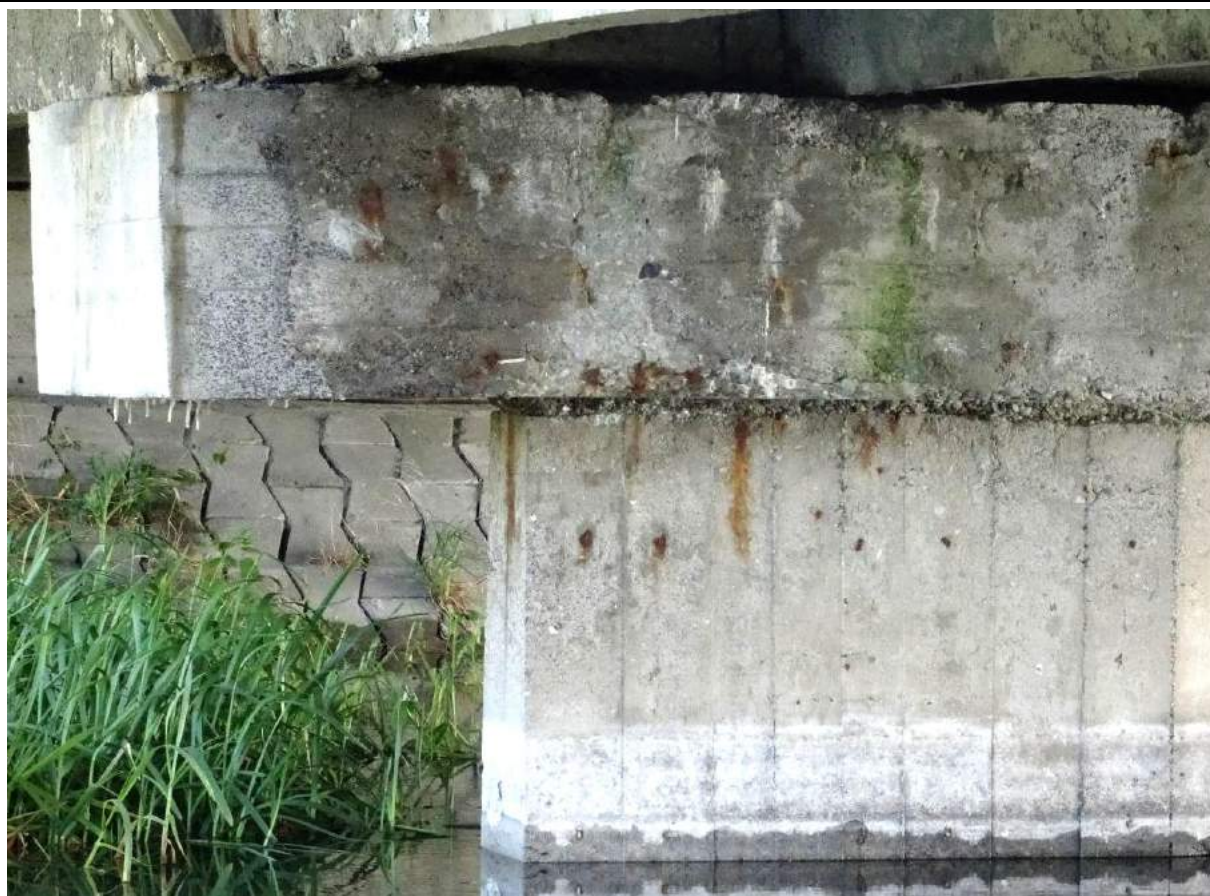
Fot. 50. Podpora nr 2, widok od str. podpory nr 3. Szczegół uszkodzeń oczepu od GW. Korozja betonu i zbrojenia spowodowana intensywnymi przeciekami przez nieuszczelną dylatację.
