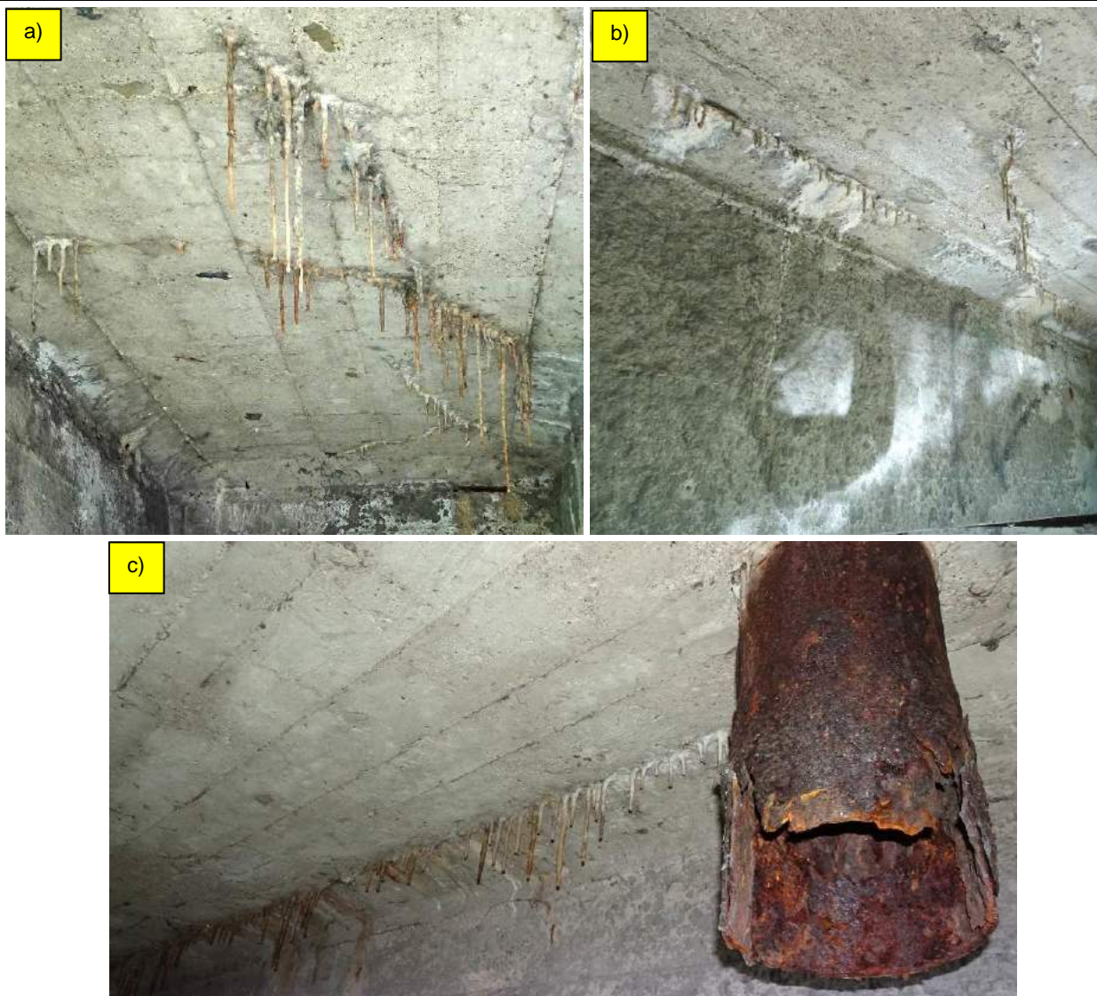
Fot. 26. Przęsło 1-2. Typowe uszkodzenia płyty pomostu: rysy ukośne i równoległe do osi dźwigarów, ze stalaktytami świadczącymi o nieszczelności izolacji i korozji ługującej w betonie. Pozostałości rury spustowej.
