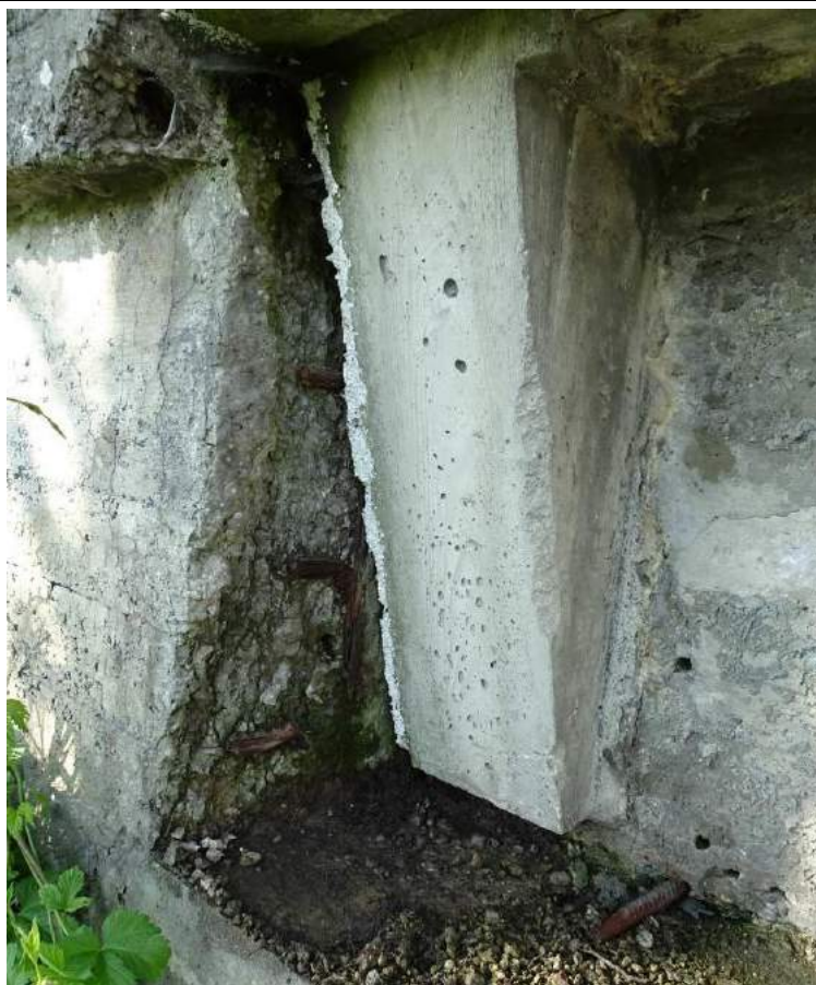
Fot. 40. Podpora nr 4, widok od DW. Spękania, ubytki i korozja betonu oraz korozja zbrojenia w ściance zapleczej. Uszkodzenia spowodowane przeciekami przed dylatacją.
