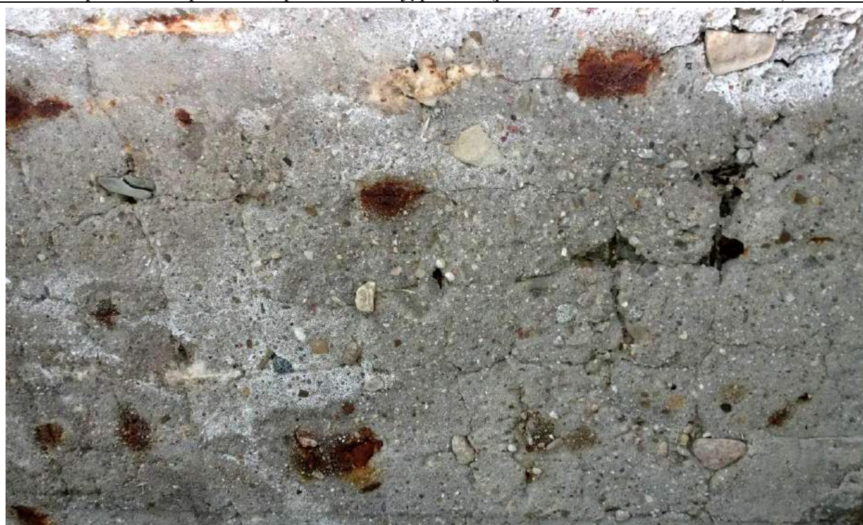
Fot. 28. Przęsło 3-4. Zarysowania siatkowe w środkowym polu płyty pomostu mogące świadczyć o przeciążeniu płyty. Rdzawe plamy świadczące o korozji zbrojenia. Podobne uszkodzenie stwierdzono również w środkowym polu płyty w przęśle 2-3.
