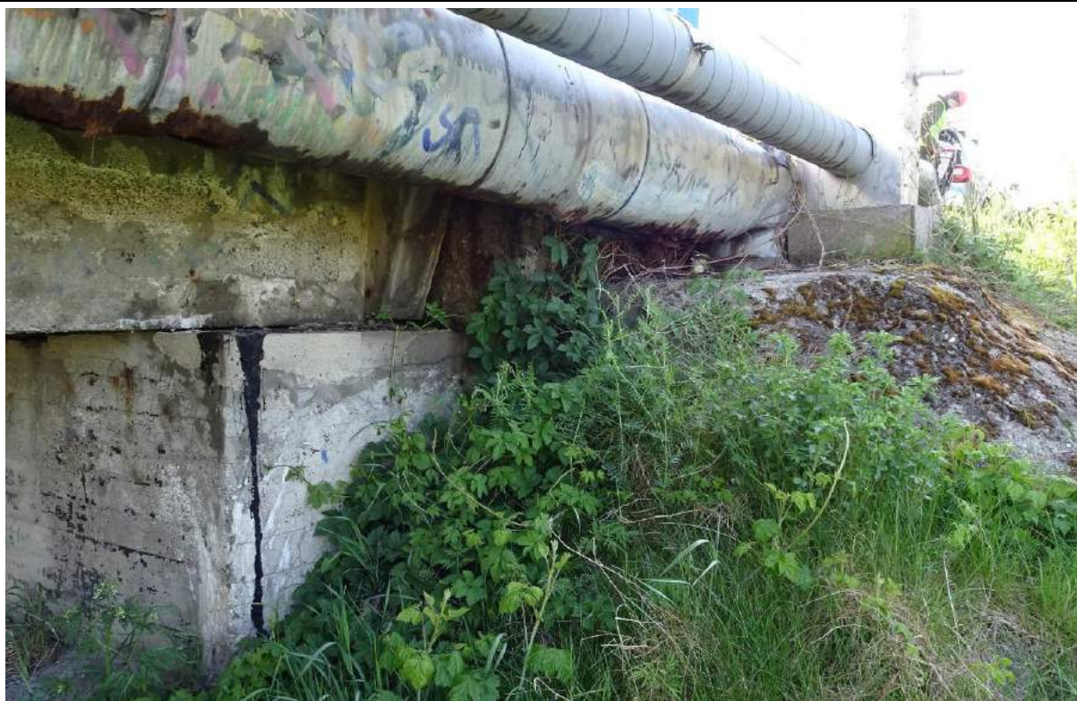
Fot. 37. Podpora nr 4, widok od GW. Zacieki, wykwity i zarysowania siatkowe na powierzchni skrzydła, ścianki zapleczej i ściany czołowej. Wegetacja na umocnieniu skarpy. Uszkodzenia urządzeń obcych.
