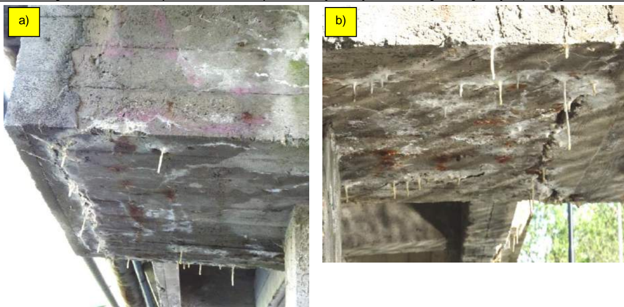
Fot. 57. Podpora nr 3. Stalaktyty na dolnej powierzchni wsporników oczepu świadczące o intensywnych przeciekach przez oczep i korozji ługującej w betonie. Widoczne również rdzawe plamy świadczące o korozji zbrojenia.
