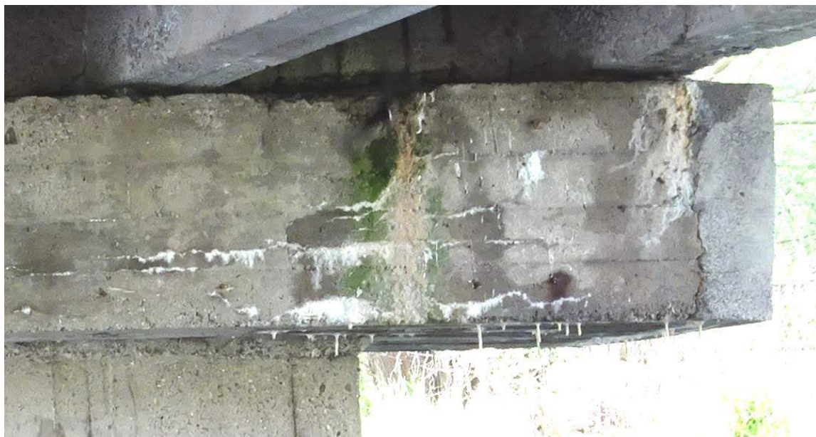
Fot. 53. Szczegół uszkodzeń oczepu od str. GW.
