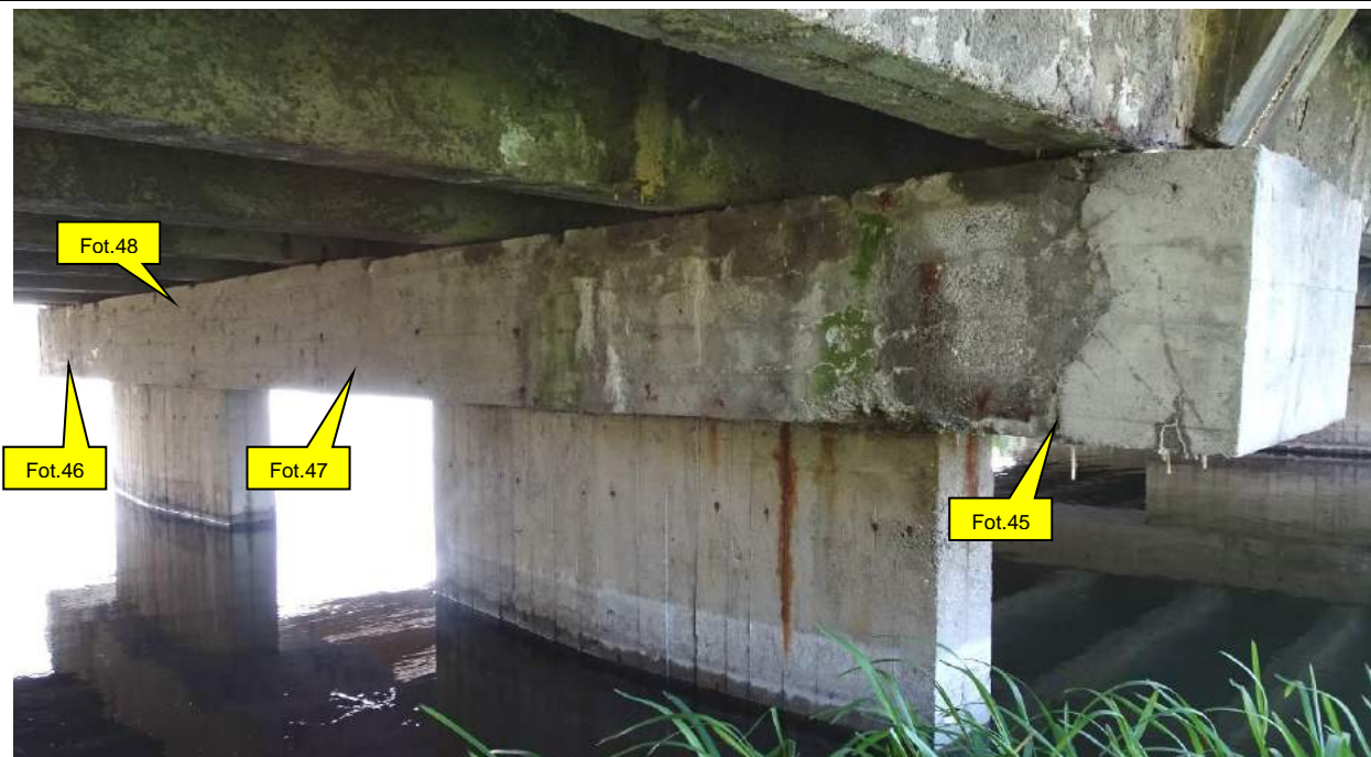
Fot. 44. Podpora nr 2, widok ogólny od str. podpory nr 1. Przecieki przez wsporniki oczepu, powodujące intensywną korozję betonu i zbrojenia (fot. 45, 46). Rysy pionowe w środku rozpiętości oczepu (fot. 47). Rysa pozioma w górnej części oczepu (fot. 48). Na całej powierzchni oczepu i lokalnie na słupach liczne rdzawe plamy świadczące o korozji zbrojenia w następstwie braku otuliny betonowej.
