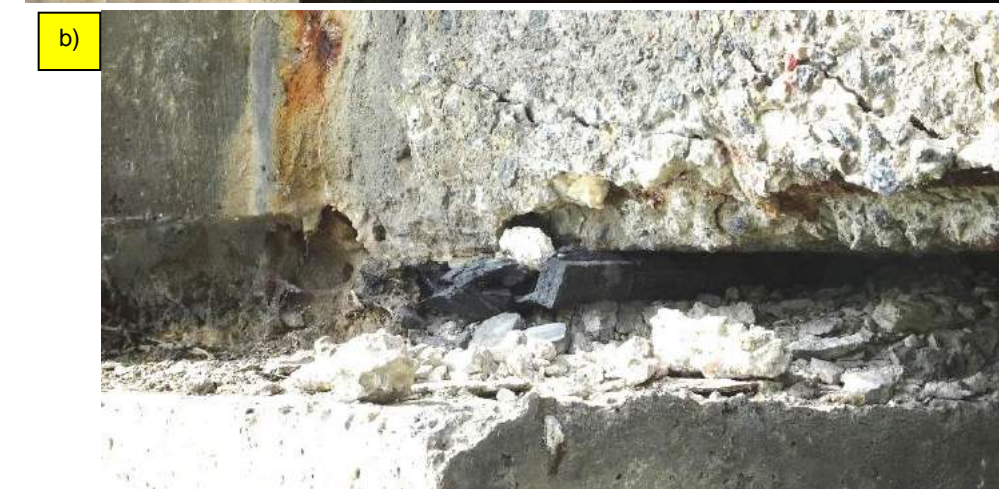
Fot. 20. Korozja zbrojenia oraz spękania i ubytki otuliny betonowej w dźwigarze skrajnym od DW nad podporą nr 2. Na fot. b) szczegół całkowicie zniszczonego łożyska gumowego. Ława podłożyskowa pokryta gruzem betonowym odpadającym z dźwigarów. Ubytki betonu i korozja zbrojenia w belce gzymsowej.
