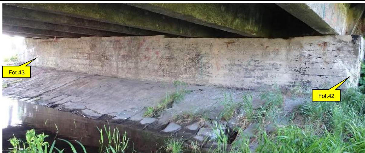
Fot. 41. Podpora nr 4, widok ściany czołowej. Spękania i wykwyty spowodowane korozją ługującą betonu oraz korozją zbrojenia w narożu ściany czołowej od GW (fot. 42). Zarysowania i ubytki betonu wzdłuż krawędzi ławy podłożyskowej spowodowane korozją zbrojenia w następstwie przecieków przez dylatację (fot. 43). Niewielkie deformacje i ubytki w umocnieniu skarpy.
