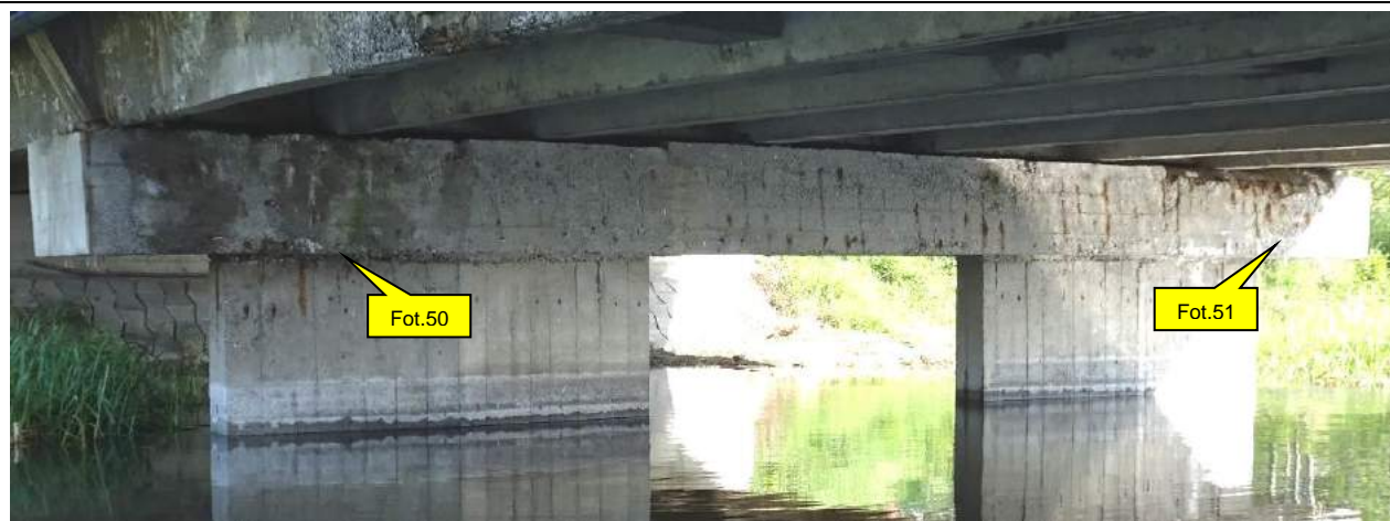
Fot. 49. Podpora nr 2, widok ogólny od str. podpory nr 3. Przecieki przez wsporniki oczepu, powodujące intensywną korozję betonu i zbrojenia (fot. 50, 51). Rysa pozioma w górnej części oczepu spowodowana korozją zbrojenia głównego. Na całej powierzchni oczepu i lokalnie na słupach liczne rdzawe plamy świadczące o korozji zbrojenia w następstwie ubytków otuliny betonowej.
