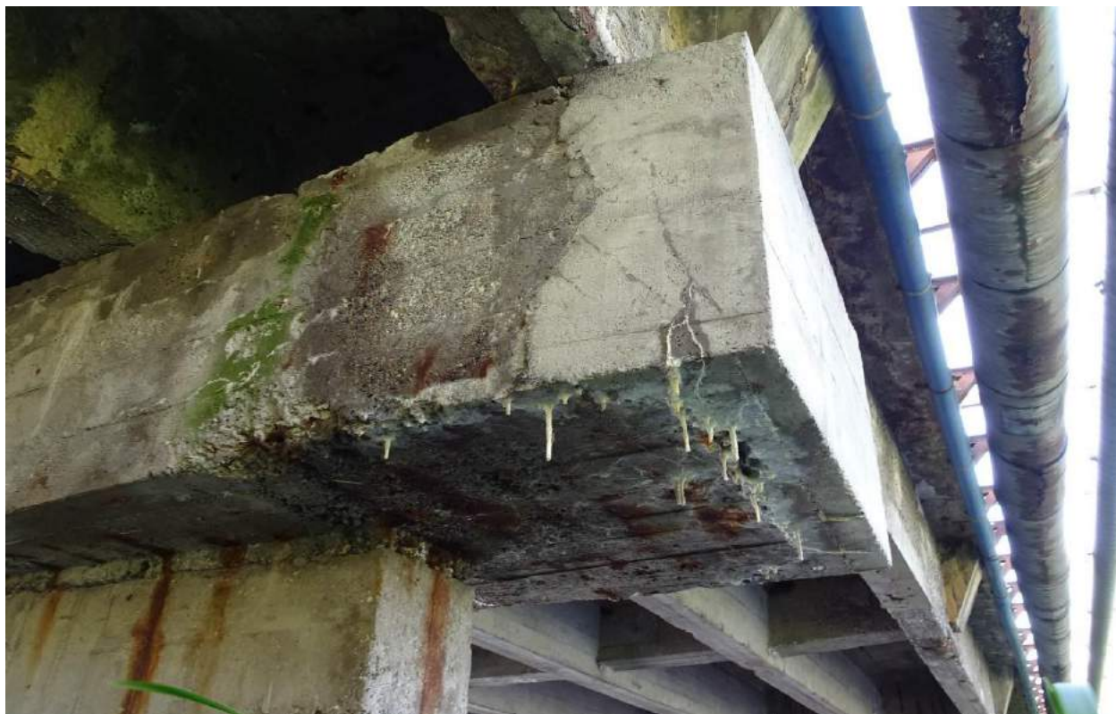
Fot. 45. Podpora nr 2, widok od str. podpory nr 1. Szczegół uszkodzeń oczeput od GW. Korozja betonu i zbrojenia spowodowana intensywnymi przeciekami przez nieszczelną dylatację. Widoczne uszkodzenia urządzeń obcych.
