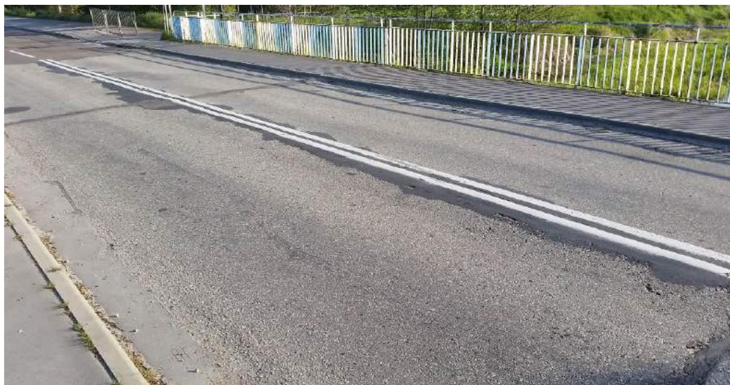
Fot. 7. Widok ogólny jezdni na moście. Niewielkie deformacje poprzeczne (koleiny), spękania, niewielkie ubytki i liczne łaty w nawierzchni jezdni.
