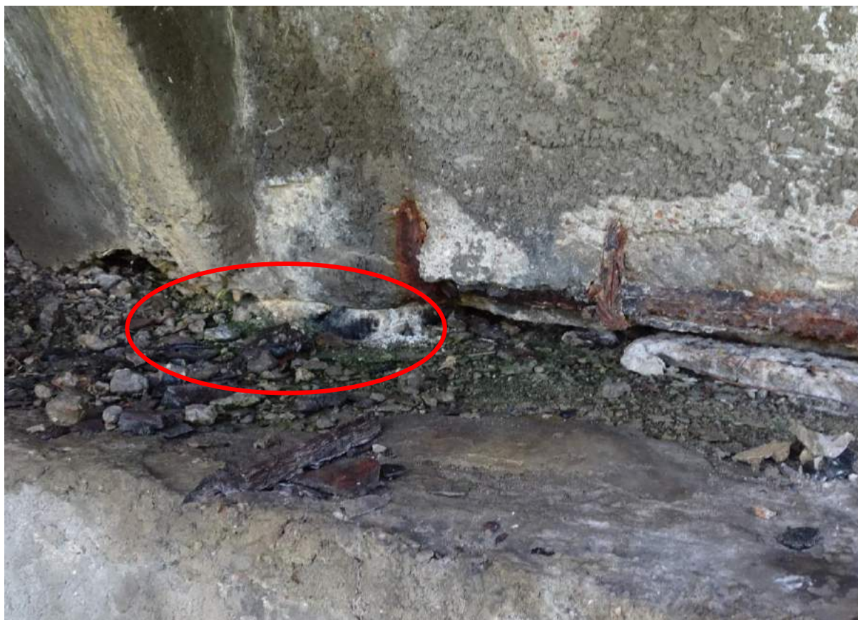
Fot. 32. Podpora nr 1, widok od GW. Zniszczone (zmiażdżone) łożysko gumowe. Zanieczyszczenie ławy gruzem betonowym odpadającym z dźwigara. Zawilgocenie ławy spowodowane przeciekami przez dylatację.
