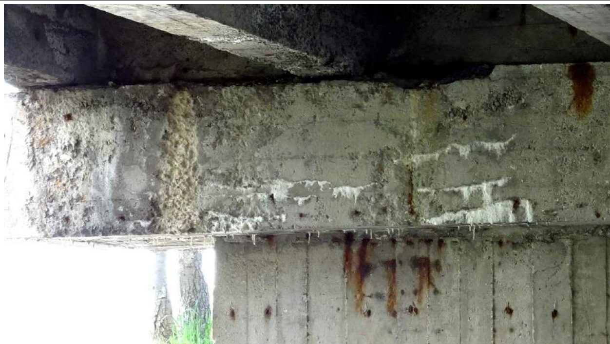
Fot. 54. Podpora nr 3, widok od str. podpory nr 2. Szczegół uszkodzeń oczepu od str. DW. Przepieki przez oczep, korozja i powierzchniowe ubytki betonu. Lokalna korozja zbrojenia w górnej części słupa.
