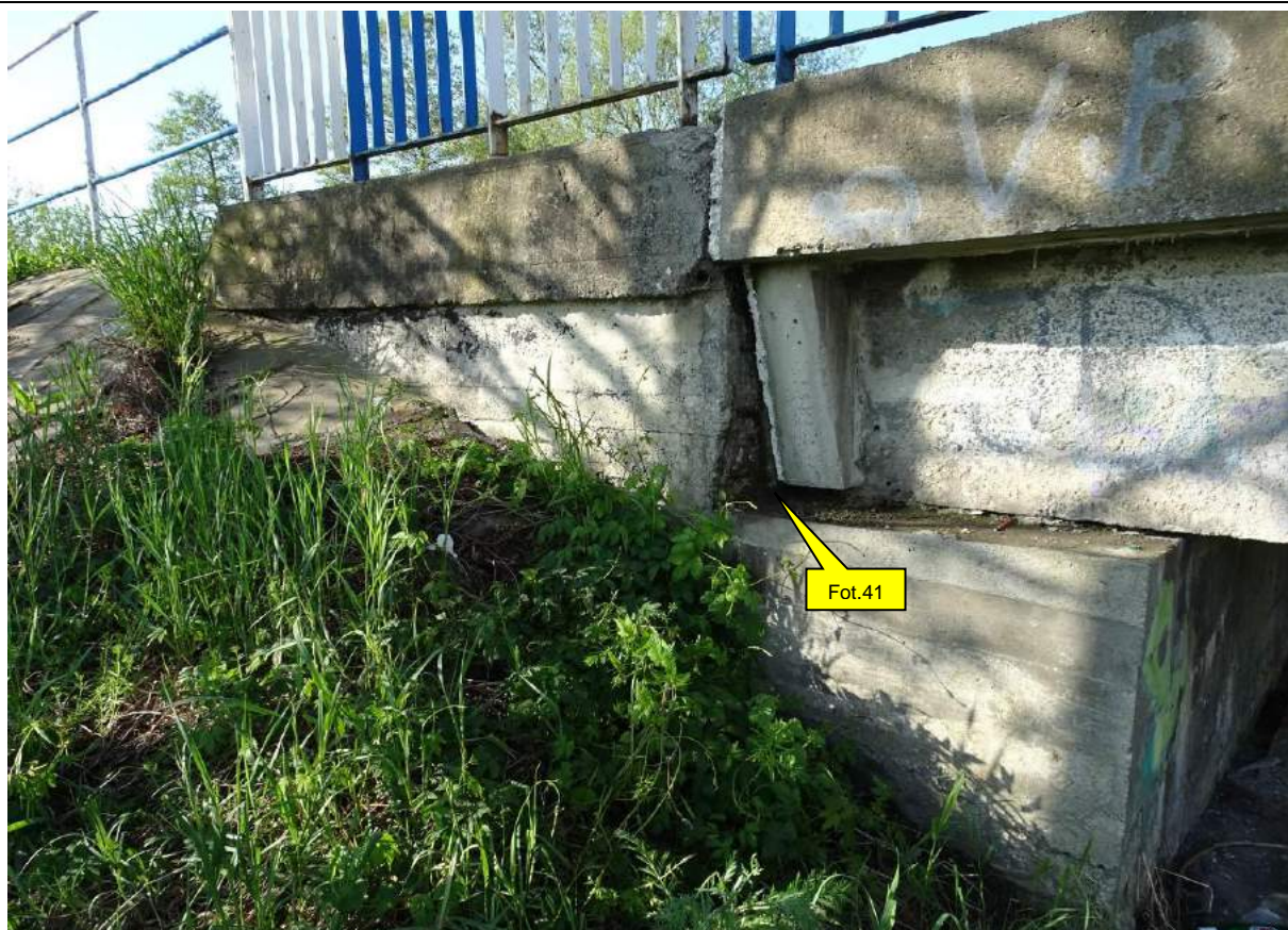
Fot. 39. Podpora nr 4, widok od DW. Ubytki i korozja betonu oraz zbrojenia ścianki zapleczej spowodowane przeciekami przed dylatacją. Wegetacja na umocnieniu skarpy.
