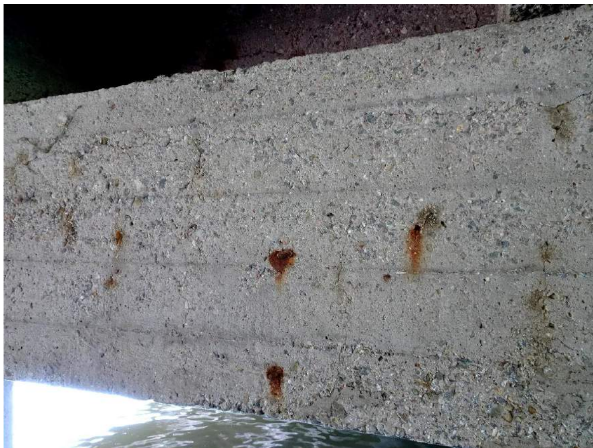
Fot. 47. Podpora nr 2. Rysa pozioma w górnej części oczepu spowodowana korozją zbrojenia głównego oraz rysy pionowe o rozwartości do 0,3 mm w środku rozpiętości oczepu. Rdzawe plamy spowodowane korozją zbrojenia.
