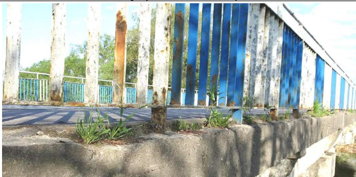
Fot. 12. Chodnik od str. DW. Intensywna wegetacja roślinna wzdłuż belki gzymsowej. Lokalne ogniska korozji na balustradzie.
