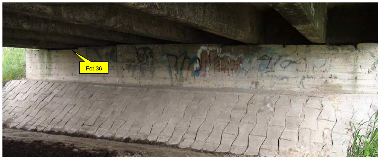
Fot. 35. Podpora nr 1, widok ogólny ściany czołowej. Rysa pionowa o rozwarości do 0,4 mm (fot. 36). Korozja zbrojenia stykającego się z powierzchnią betonu. Umocnienie skarpy bez uszkodzeń.
