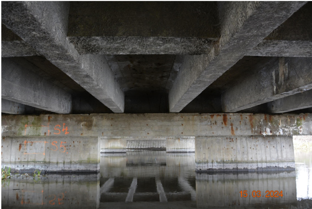
Fot. 13 Lokalne przecieki przez obszary dylatacyjne nad wszystkimi podporami. Przecieki i zacieki na spodzie pomostu świadczące o nieszczelnościach izolacji. Widoczne zacieki, przecieki, ubytki betonu i korozja zbrojenia w filarach.
