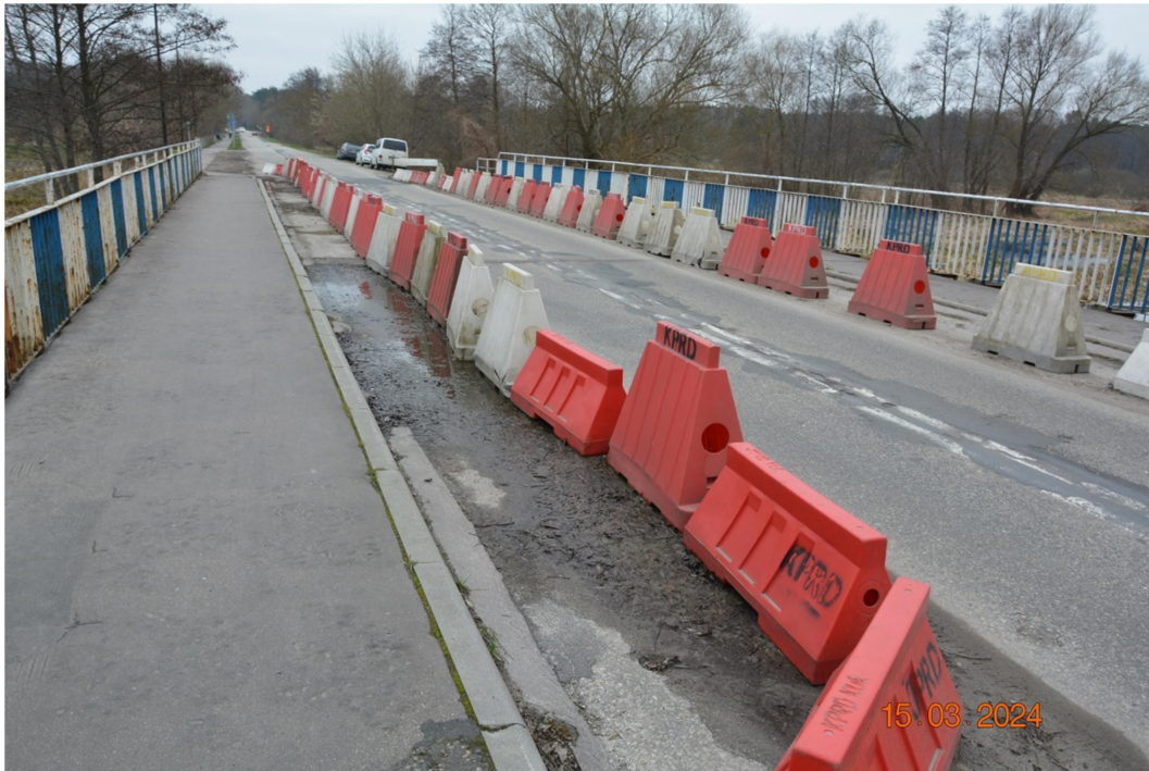
Fot. 11 Spadki niezapewniające pełnego spływu wody i zastoiska wody na pomoście.
