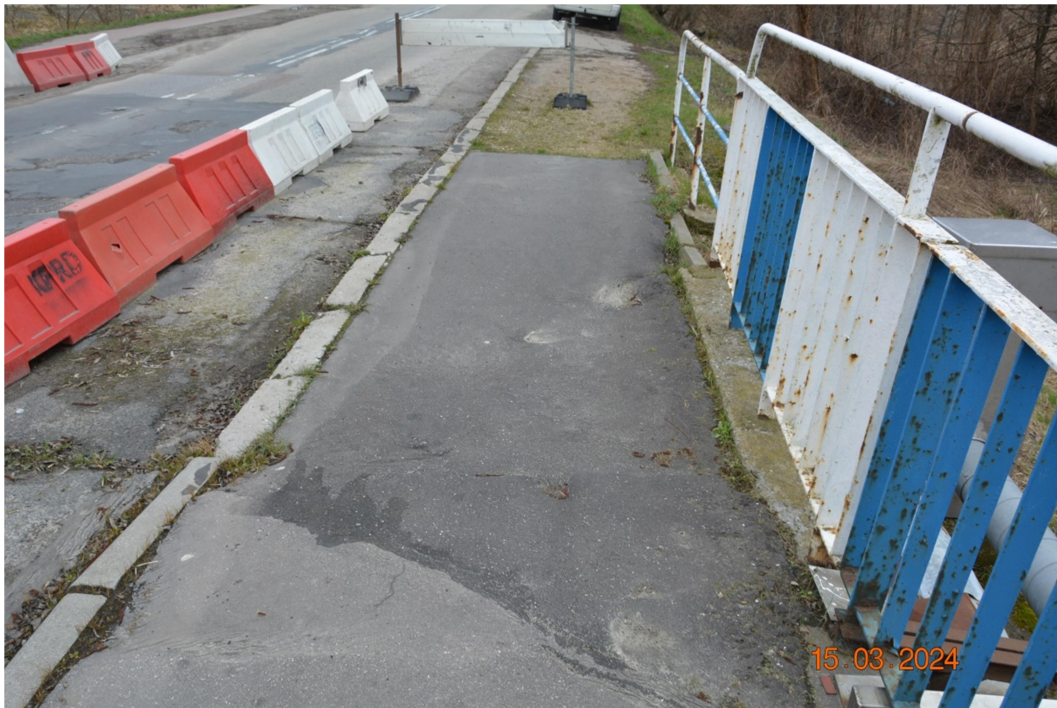
Fot. 8 Zanieczyszczenie, deformacje, zarysowania, ubytki nawierzchni, zastoiska wody i wegetacja roślinności na chodnikach. Osiadanie terenu na dojazdach do obiektu. Lokalne przemieszczenia krawężników.
