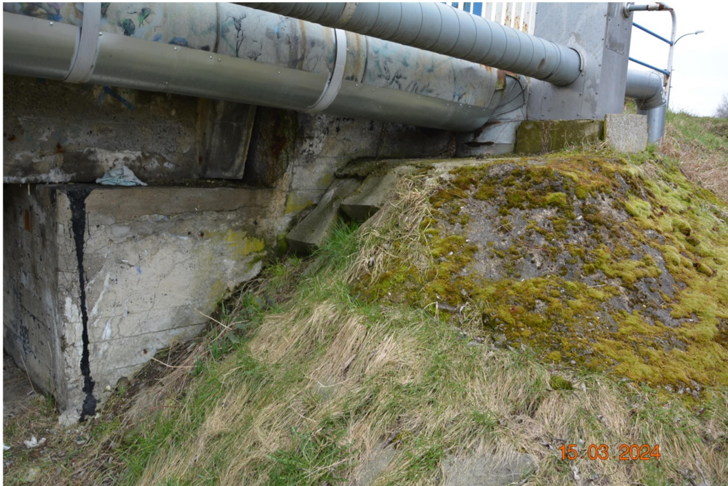
Fot. 5 Przemieszczenia, ubytki umocnień stożków i skarp przy skrzydłach.
