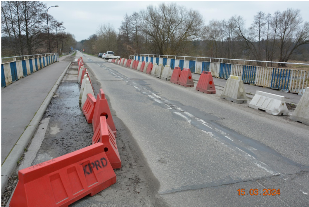
Fot. 7 Zanieczyszczenie, deformacje, zarysowania ubytki nawierzchni jezdni na pomoście.
