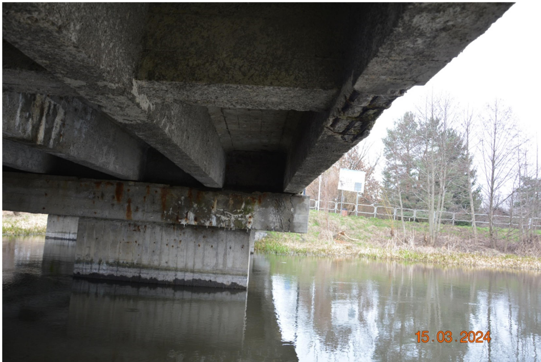
Fot. 12 Przecieki przez dźwigary, zacieki na betonie, lokalne zniszczenia otuliny, zarysowania otuliny, lokalna korozja strzemion i prętów zbrojenia głównego dźwigarów. Widoczne zacieki, przecieki, ubytki betonu i korozja zbrojenia w filarach.
