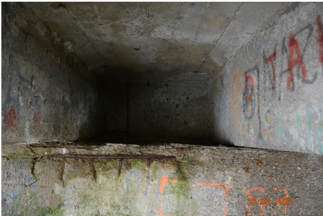
Fot. 14 Lokalne przecieki przez korpusy przyczółków, zacieki na betonie, lokalne zniszczenia otuliny, zarysowania, lokalna korozja zbrojenia.
