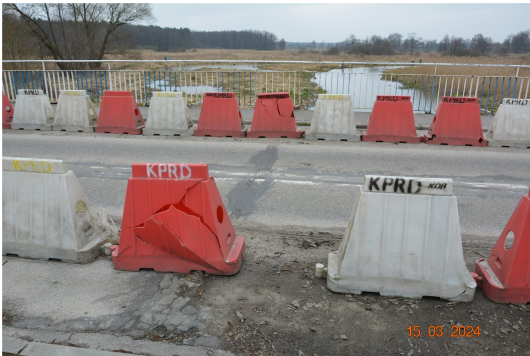
Fot. 16 Zanieczyszczenie, deformacje, zarysowania i wykruszenia nawierzchni jezdni i chodników w strefach dylatacyjnych pomostu.
