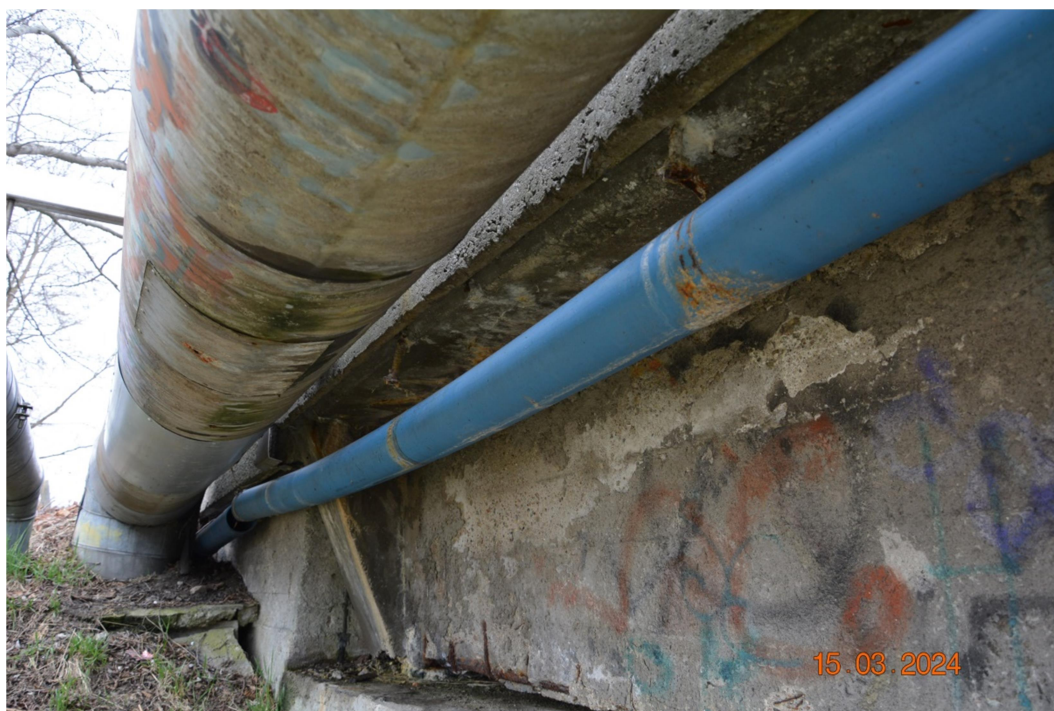
Fot. 18 Zniszczenie elementów podwieszenia rury osłonowej instalacji elektrycznej?
