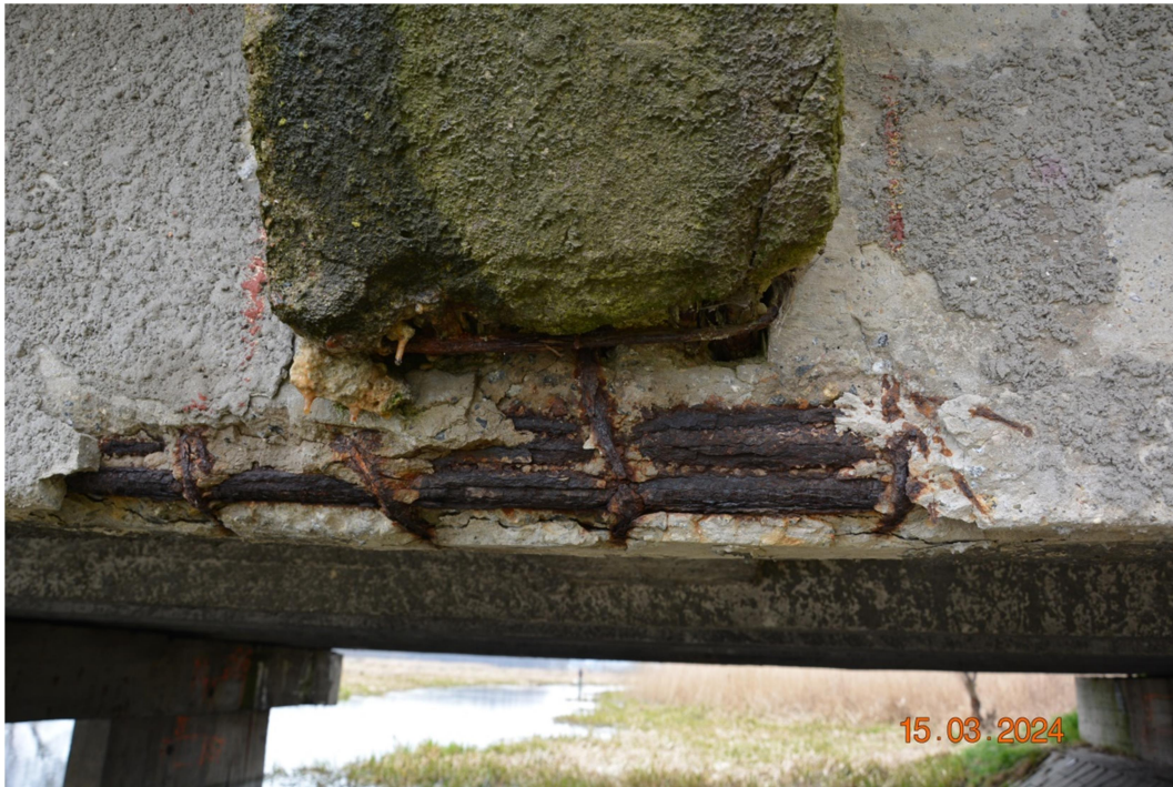
Fot. 15 Przepieki przez dźwigary, zacieki na betonie, lokalne zniszczenia otuliny, zarysowania otuliny, lokalna korozja strzemion i prętów zbrojenia głównego dźwigarów.
