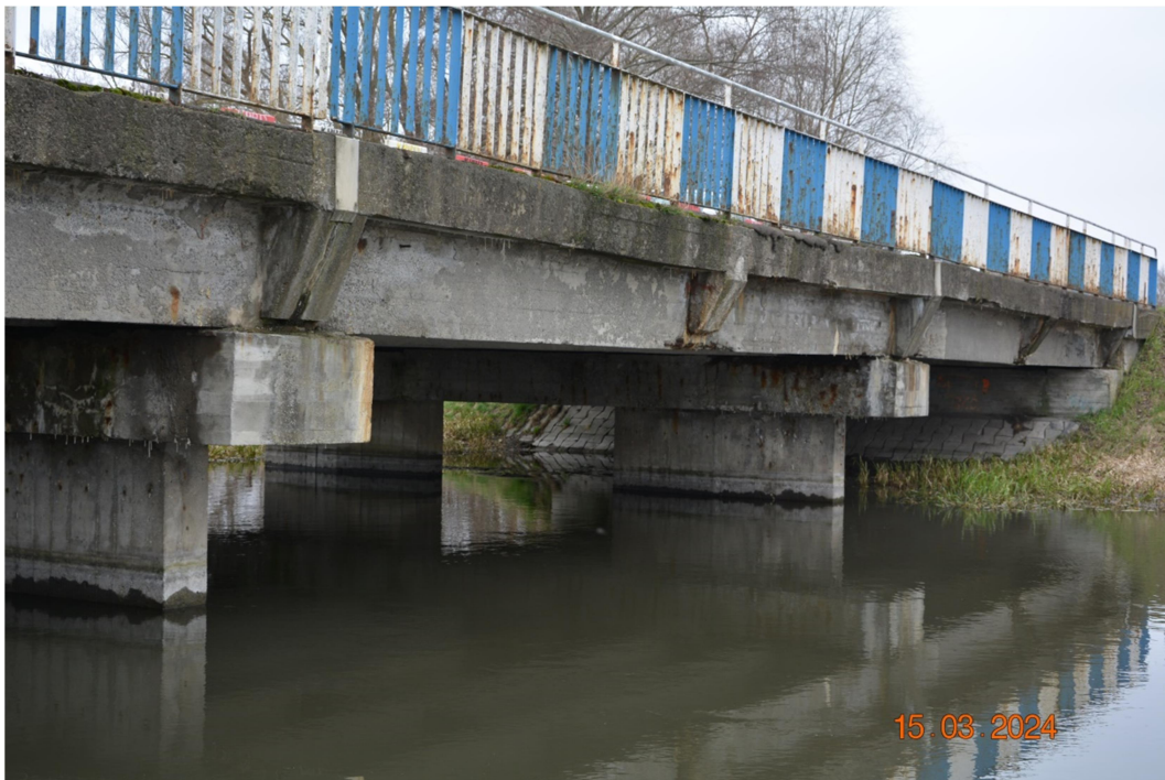
Fot. 10 Zanieczyszczenia, zarysowania, ubytki zacieki i przecieki oraz korozja betonu belek podporęczowych. Widoczne zacieki, przecieki, ubytki betonu i korozja zbrojenia w dźwigarach głównych.
