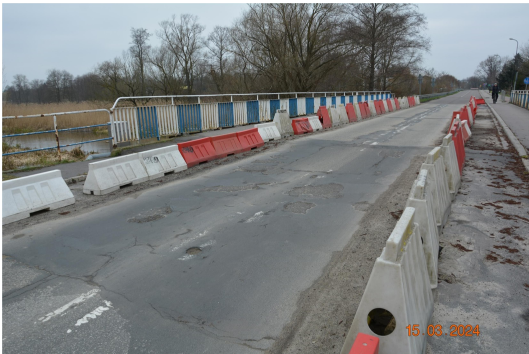
Fot. 6 Zanieczyszczenie, deformacje, zarysowania i wykruszenia nawierzchni jezdni i chodników na dojazdach.
