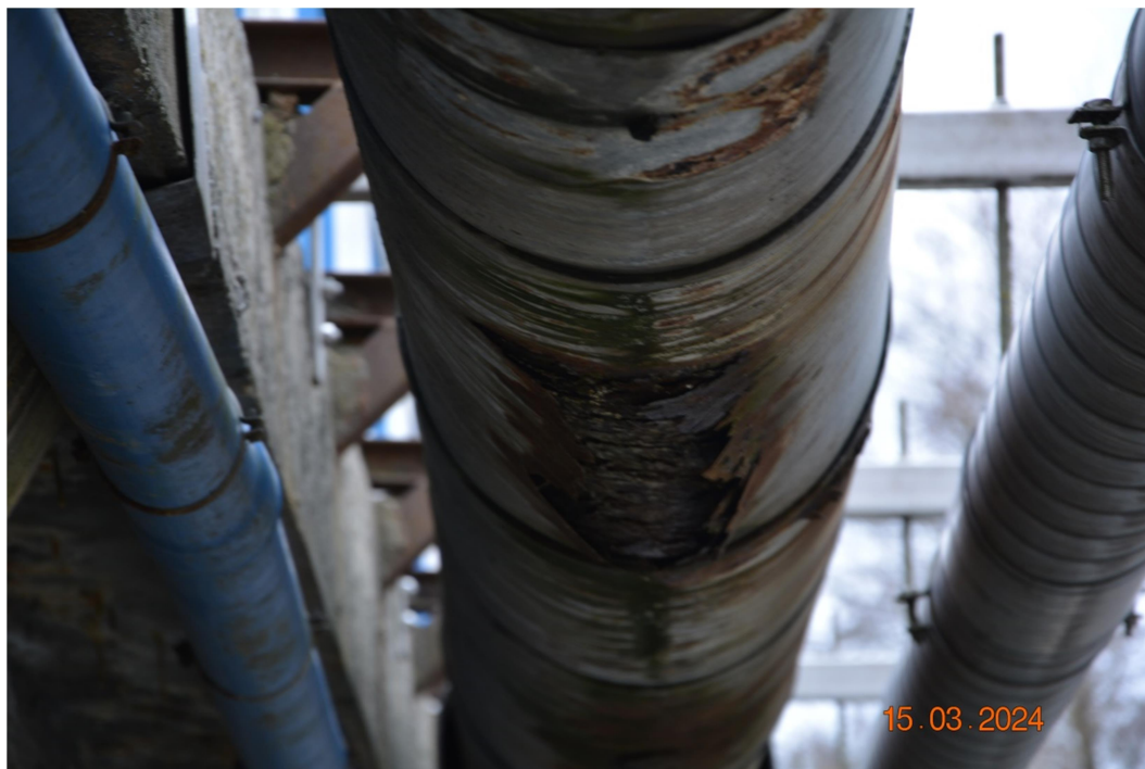
Fot. 17 Korozja rury osłonowej ciepłociągu?
