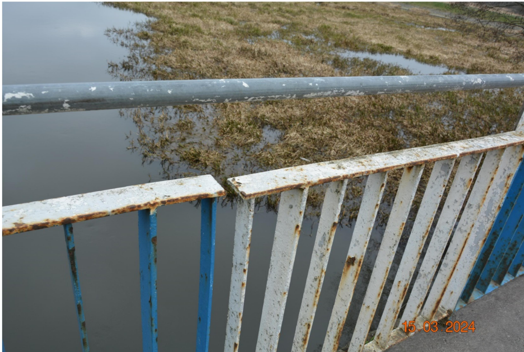
Fot. 9 Zniszczenie powłok antykorozyjnych i korozja elementów balustrad. Lokalne przemieszczenie elementów balustrady względem siebie na dylatacji balustrady.
