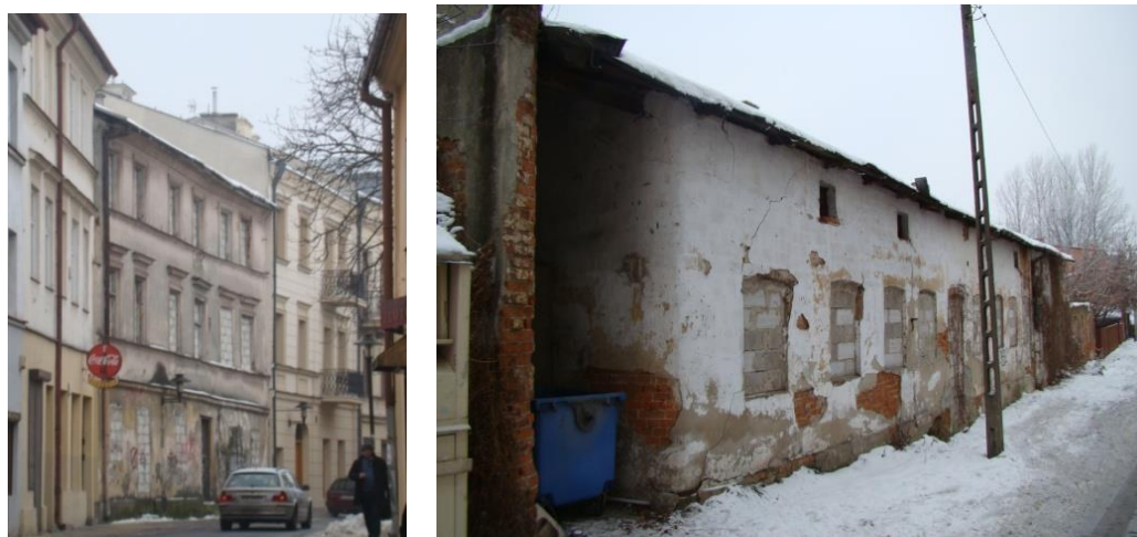
Zdjęcie 4.3 – zaniedbana zabudowa – pustostany (zdjęcia wykonane na zlecenie UM Lublin).
