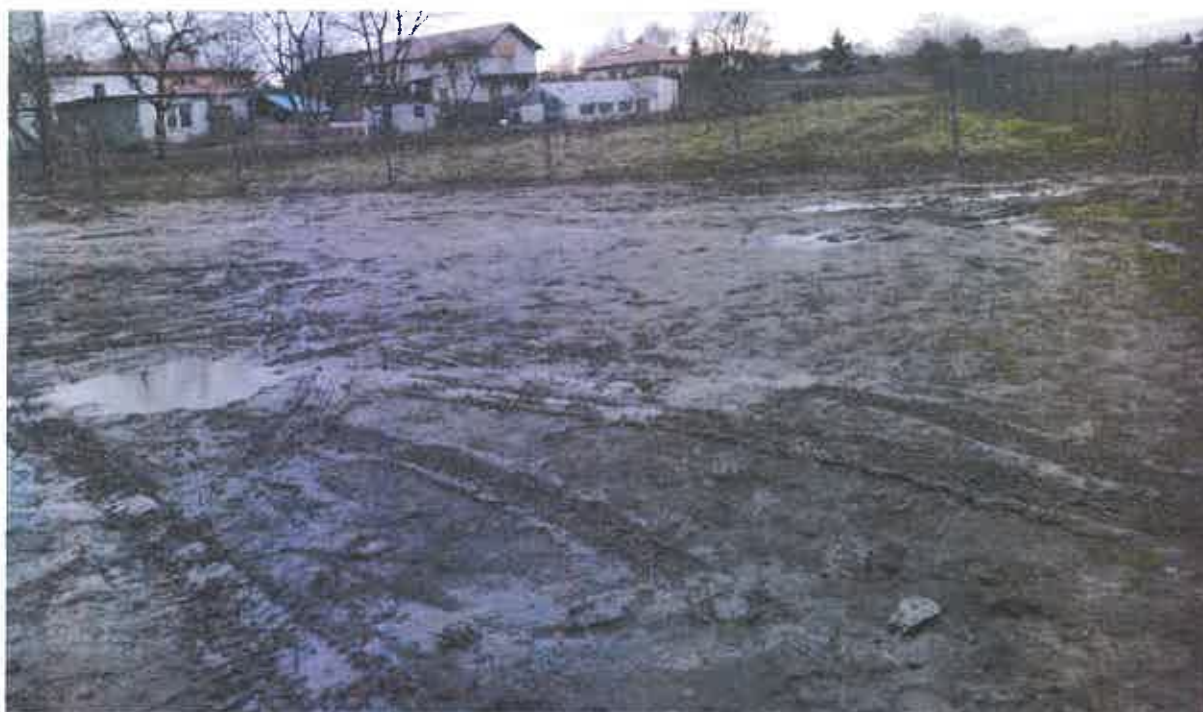
Rys. 3. Widok na plac manewrowy stanowiący początek dojścia do ścieżki rowerowej wzdłuż rzeki Bystrzycy, stan na dzień 28.01.2016 r. (działka nr 12/18 arkusz 5, obręb 20).
