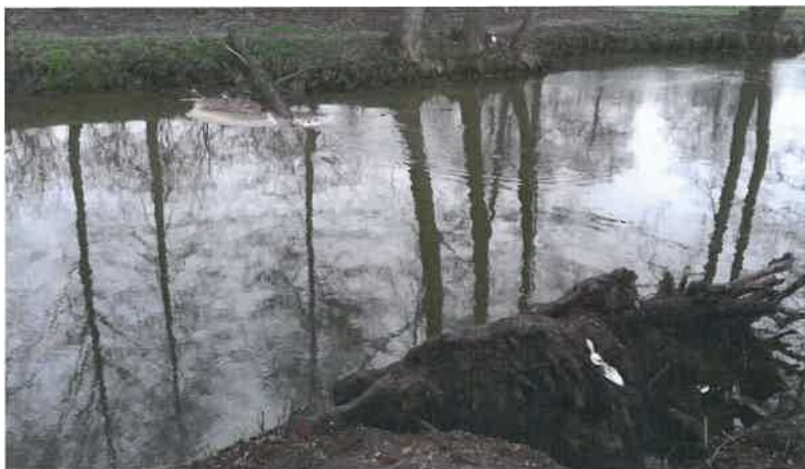
Fot. 2. Powalone drzewo w korycie Bystrzycy (na wysokości działki nr 39, arkusz 31, obręb 43), stan na dzień 01.04.2016 r.
