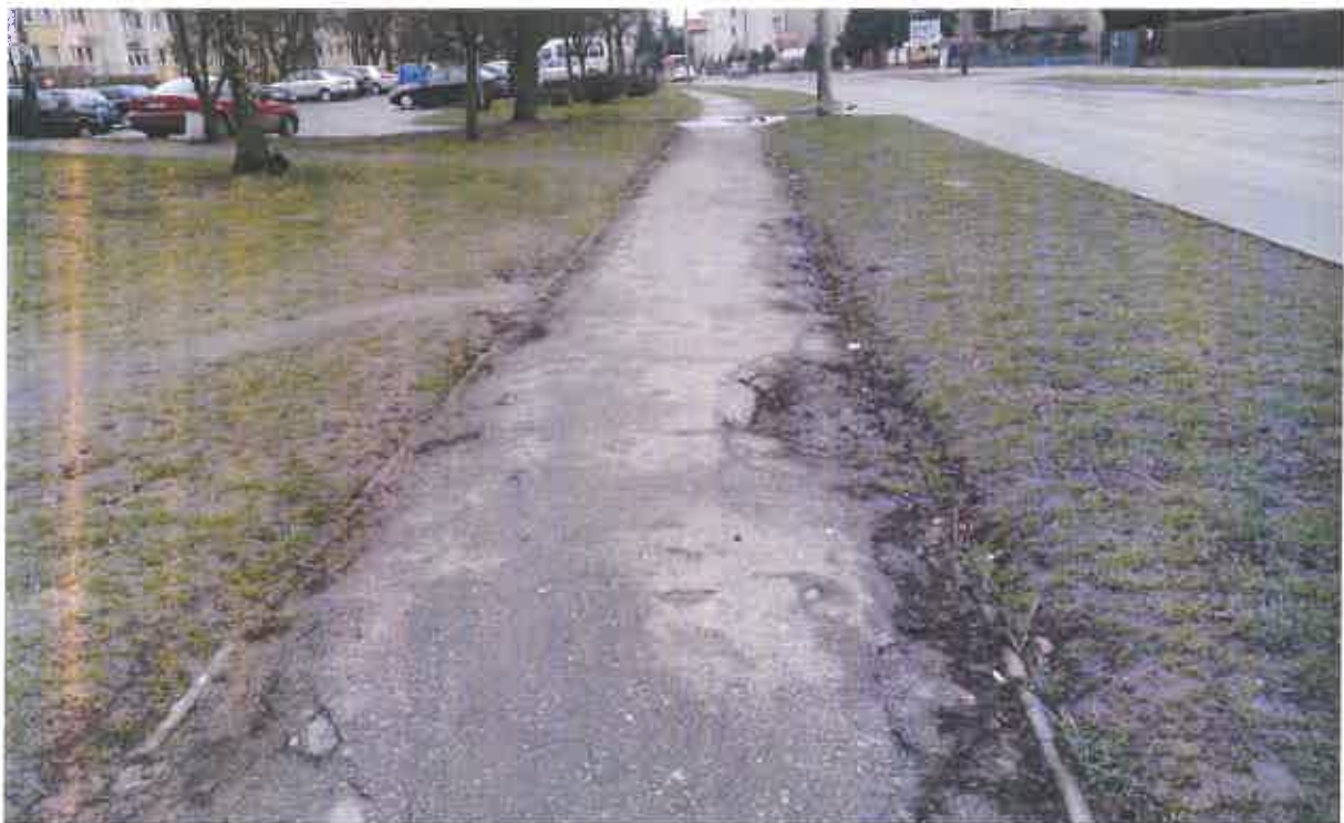
Fot. 5. Zniszczony chodnik w pobliżu budynku Romera 46; sugerowana możliwość wykonania miejsc postojowych oraz ciągu pieszo-rowerowego.
