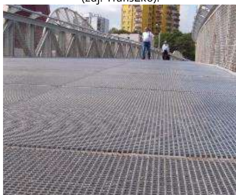
Fot. 21. Kładka nad ul. Filaretów. Nawierzchnia nieprzystosowana np. dla osób w butach na obcasie. (zdj. TransEko).
