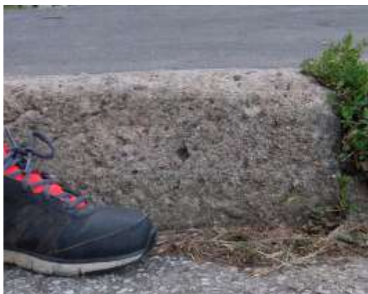
Fot. 19. Krawężnik niedostosowany do potrzeb pieszych. (zdj. TransEko).
