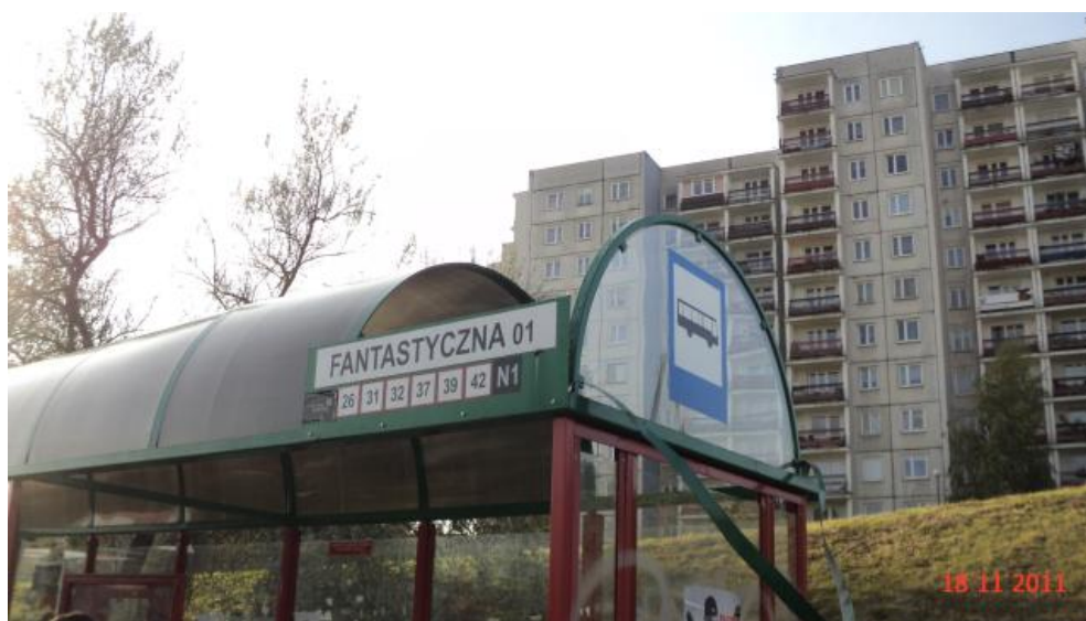
Zdjęcie nr 2: Przykład wandalizmu w komunikacji miejskiej – zniszczone zadaszenie wiaty przystankowej. Autor: ZTM Lublin.
