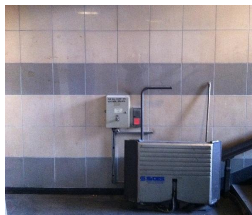
Fot. 2.8. Dworzec Lublin (Główny) – platforma dla osób niepełnosprawnych zamontowana przy schodach wejściowych
