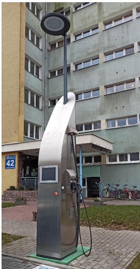
Zdjęcie 2 Stacja ładowania zintegrowana ze słupem oświetleniowym
